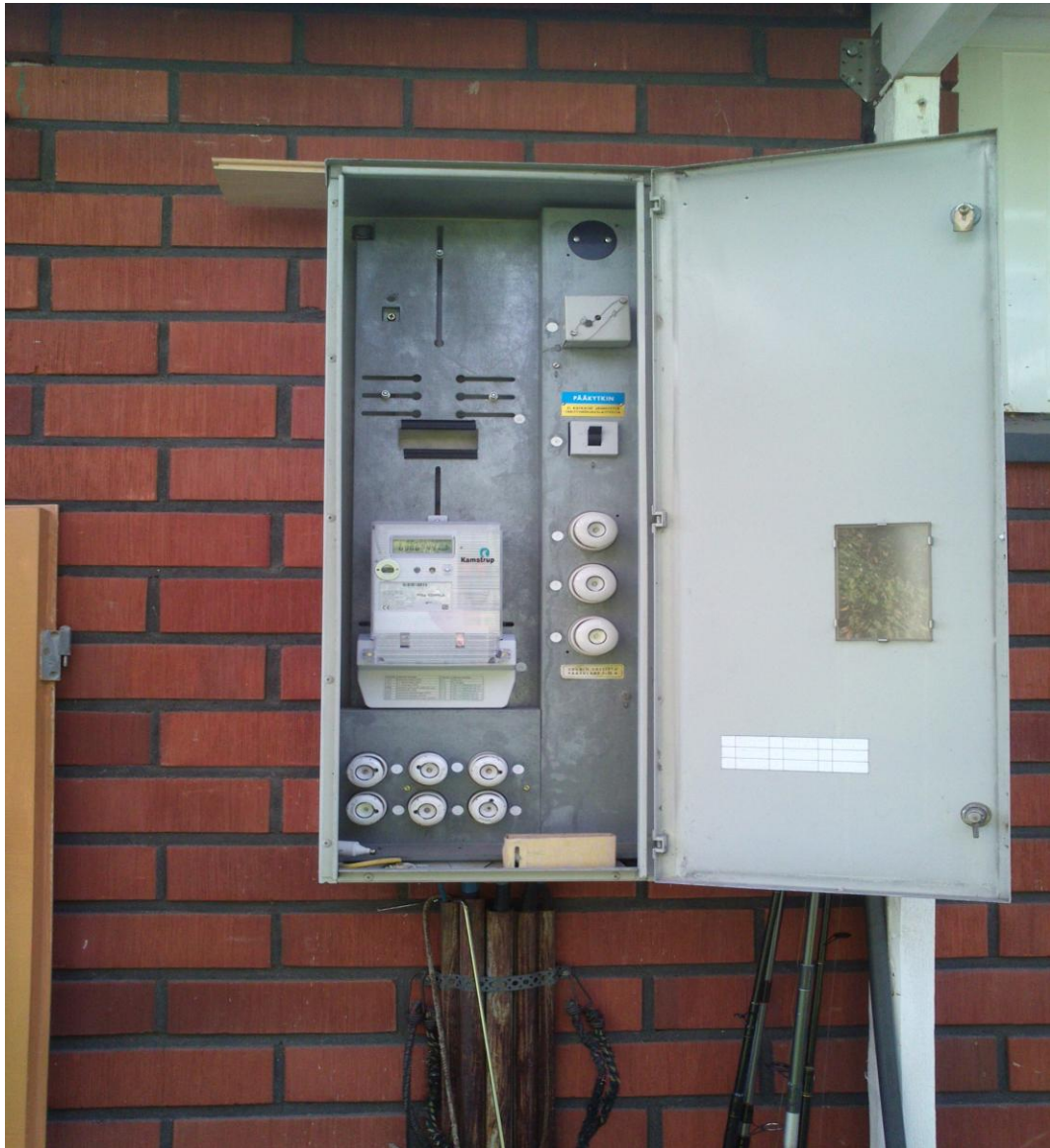
Kuva 6. Pääkeskus johon on asennettu nykyaikainen etäluettava sähkömittari
