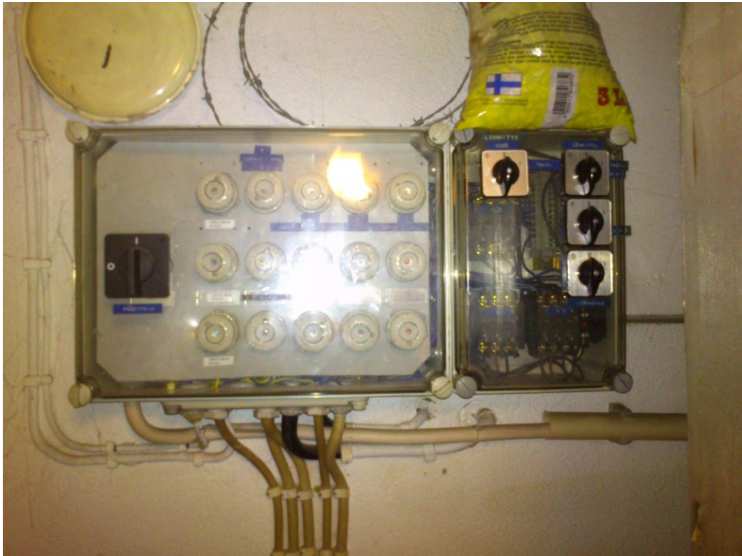
Kuva 5. Kellarikerroksen alakeskus pannuhuoneessa
