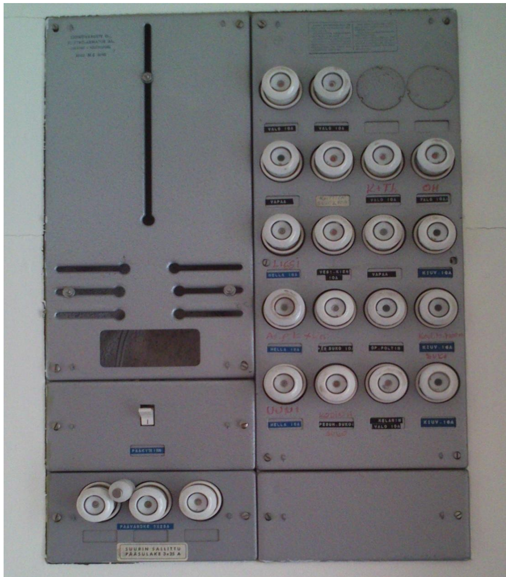
Kuva 3. Talon eteisessä oleva sähkökeskus
