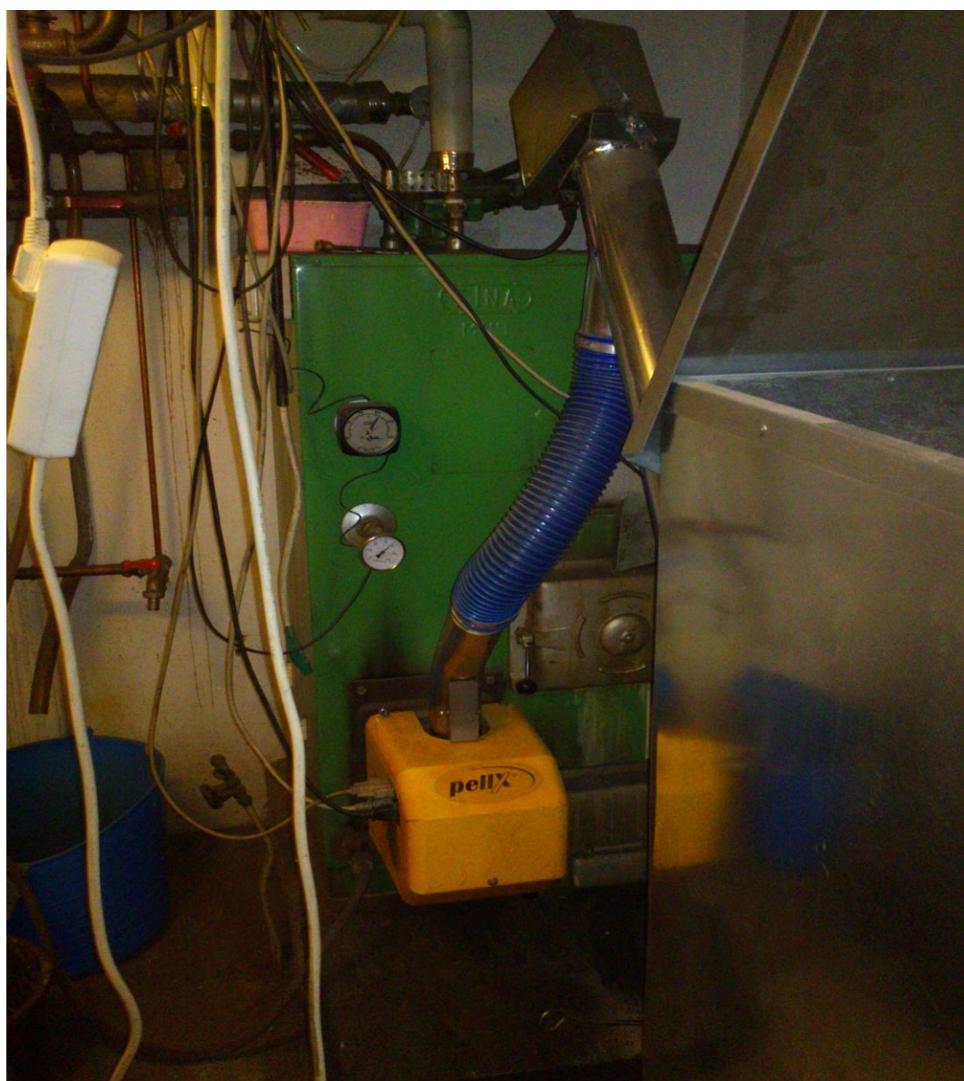
Kuva 13. Kattila on Etna Duo ja siihen asennettu Pellex 20 –pellettipoltin.
