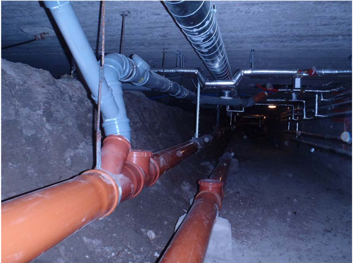
Kuva 10. Kohde C:n ryömintätilan kuljettavilla osuuksilla on perusmaan päälle valettu laatta. Kuvassa vasemmalla savikerrostumaa, joka kattaa suurimman osa ryömintätilan pohjapinta-alasta.
