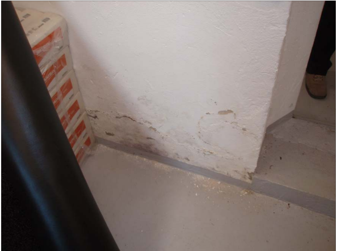
Kuva 4. Veden kapillaarista nousua betonirakenteessa.
