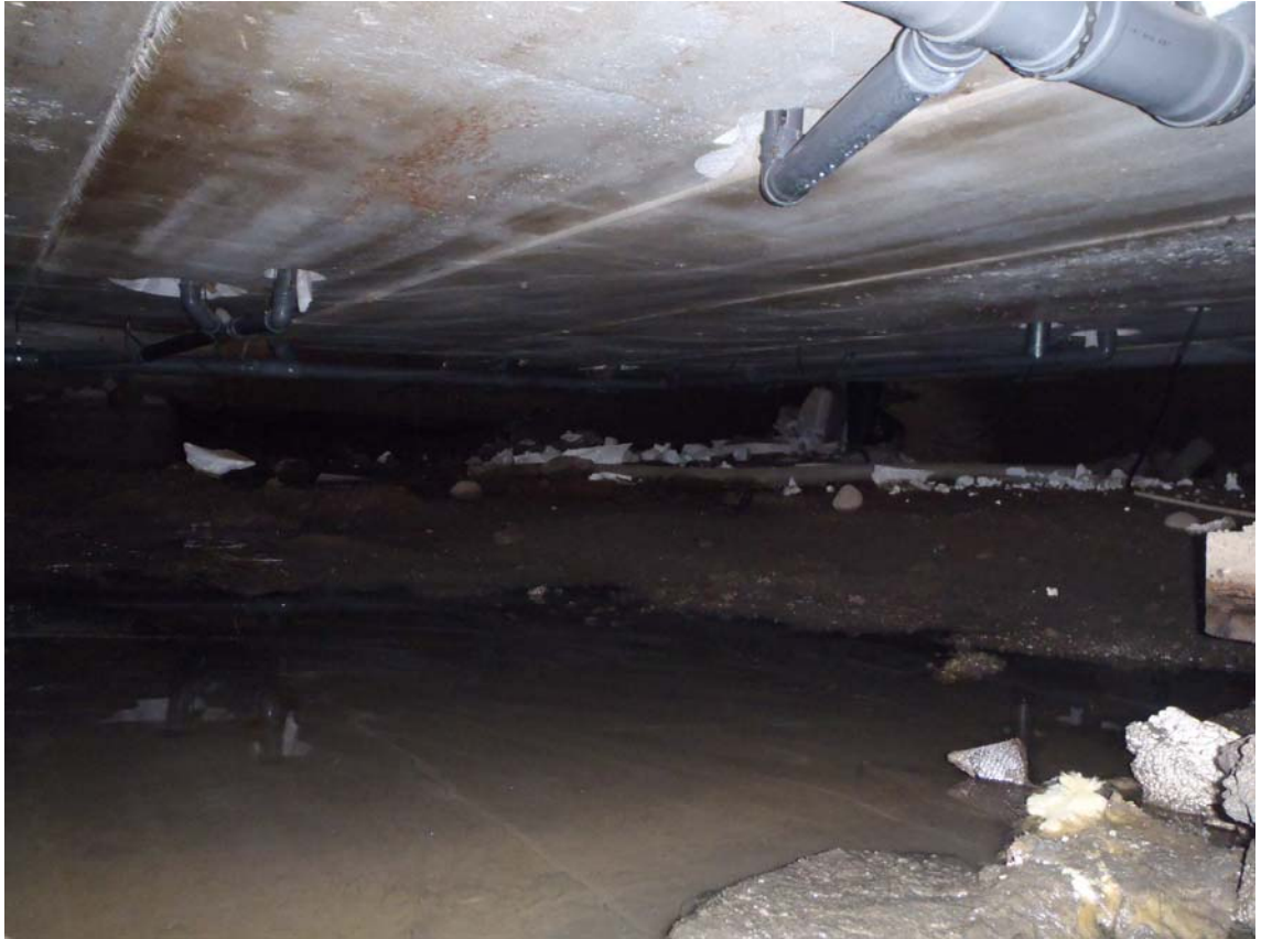
Kuva 3. Pintavesien hallitsematon valuminen rakennusta kohti voi johtaa vapaan veden kertymiseen ryömintätilaan.
