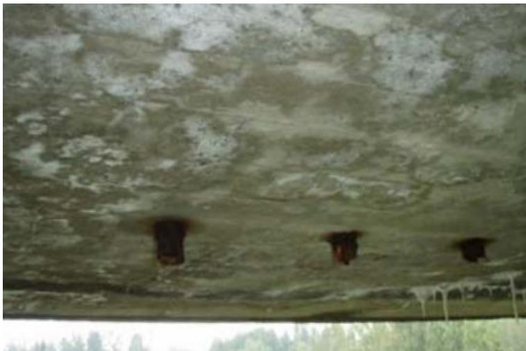
Kuva 2. Merkkejä vedeneristyksen vaurioista ovat vuotavat halkeamat, kalkkipuikot ja kalkkiläiskät (SILKO 1.801 2011, 6.)
