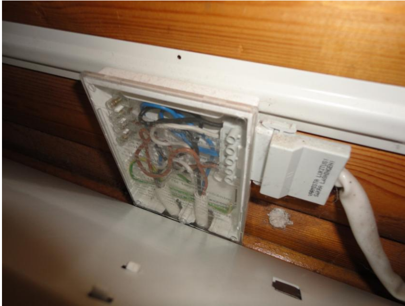
Kuva 13. Pattereiden ohjauksien kytkentöjä.
