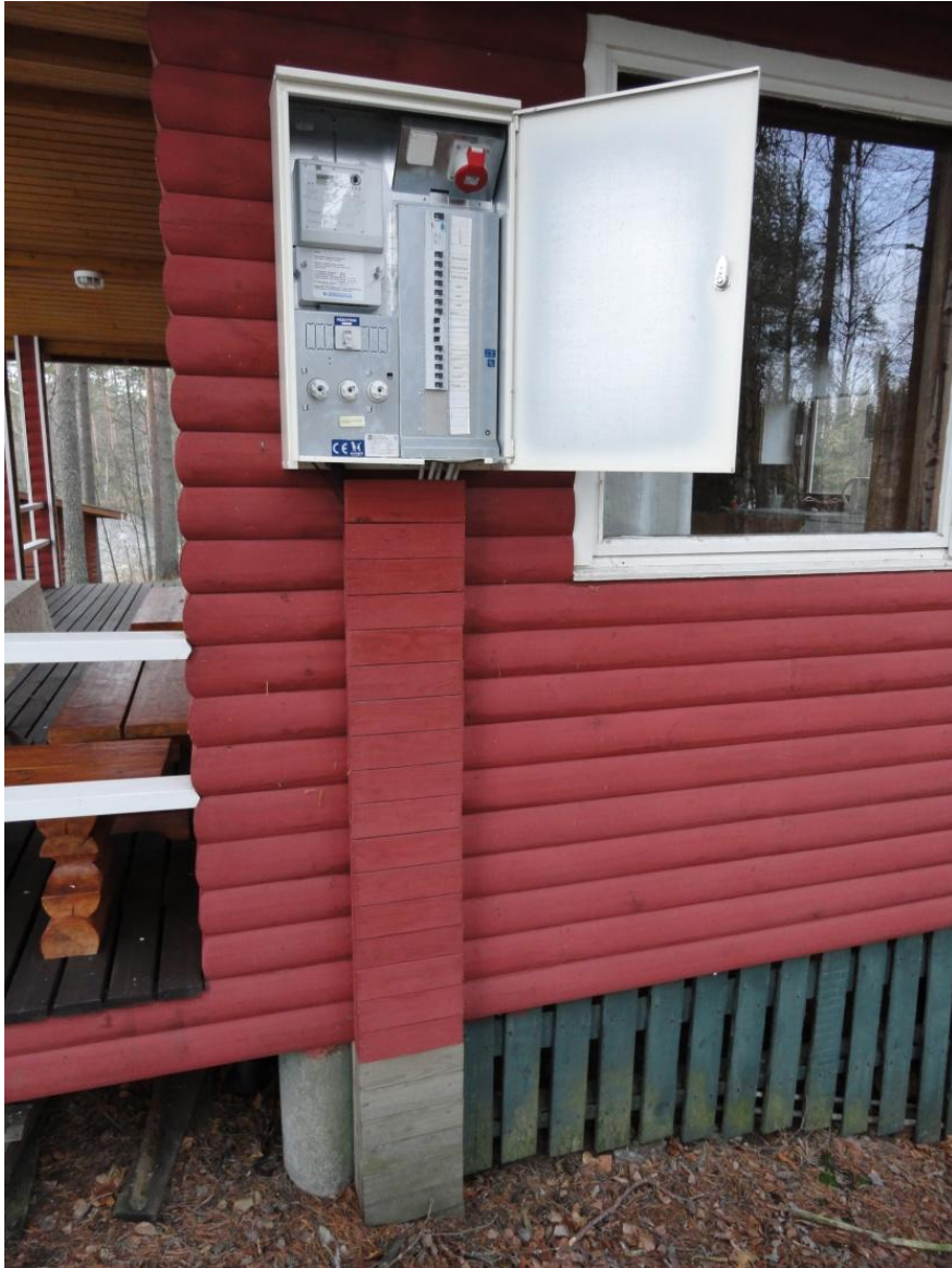
Kuva 2. Sähkökeskus asennettuna kesämökin seinään.
