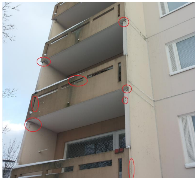
Bild 19 Kanterna under räcken speciellt utsatta. Armeringen synlig i räcket på andra våningen och sidoväggarna där bitar av betong lossnat.
