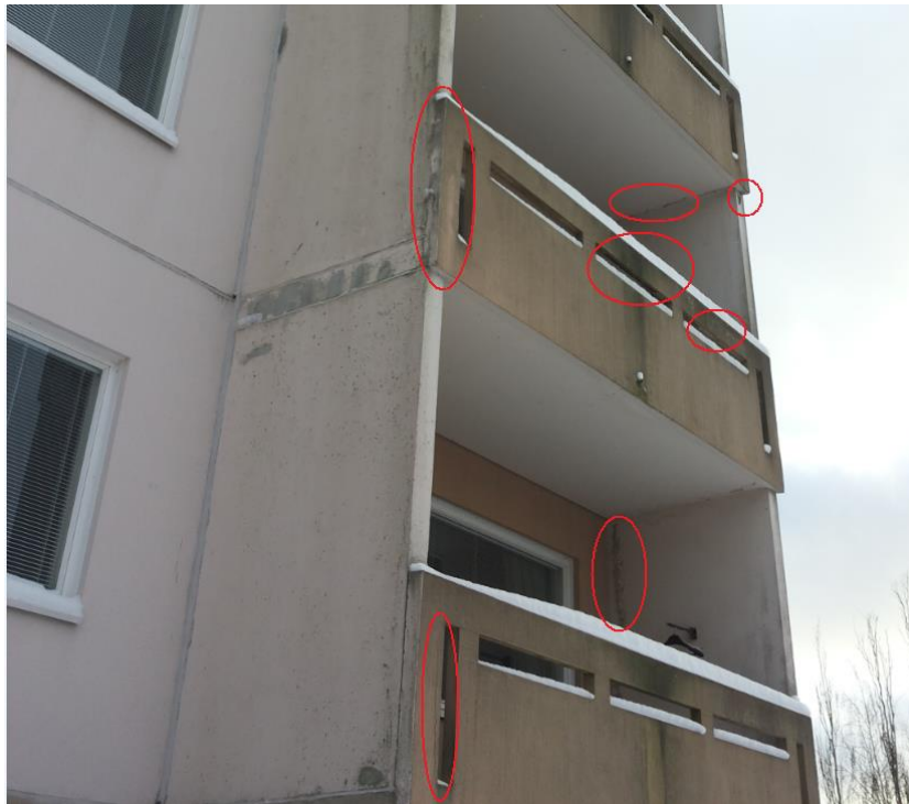
Bild 21 Sprickor i räcken, på andra våningen har betongbitar lossnat och armeringen är synlig. Färgen har släppt på sidoväggen och betongbitar lossnat och armeringen är synlig på andra våningen.
