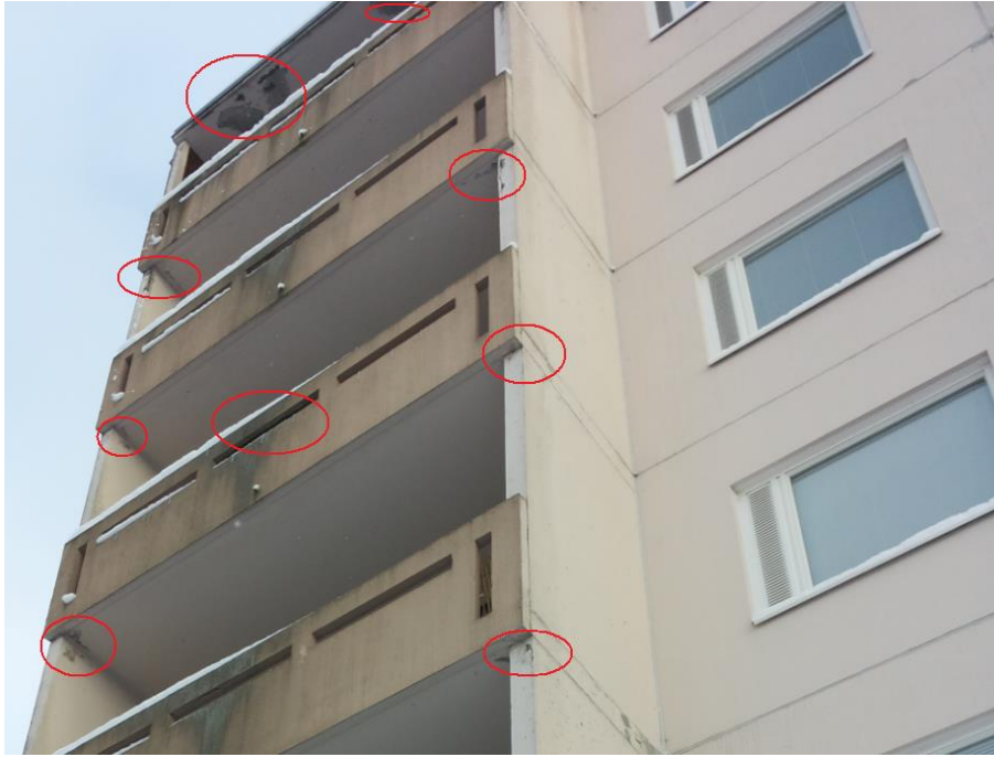
Bild 20 Kanterna under räcken speciellt utsatta. Armeringen synlig i räcket på femte våningen. Hörnen under balkongräcken speciellt utsatta av frostvittring. Sjätte våningens balkongtak har antagligen läckt och orsakat skador.
