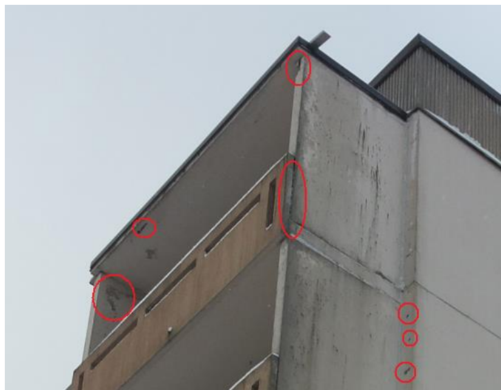
Bild 8 Närmare bild av skadorna på balkonerna. Man ser sprickor i räcken och bitar av betong som lossnar i hörnen och synlig armering. Räckena har dessutom börjat lossna från sidoväggarna. Armeringen är synlig på väggelementen mot norrfasaden. Färgen är svag och nersmutsad.
