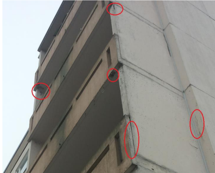
Bild 16 Närmare bild av skadorna på balkonerna. Man ser sprickor i räcken och bitar av betong som lossnar i hörnen och synlig armering. Räckena har dessutom börjat lossna från sidoväggarna. Sprickor i sidoväggarna. Färg har också lossnat och man ser lappningar som gjorts tidigare.
