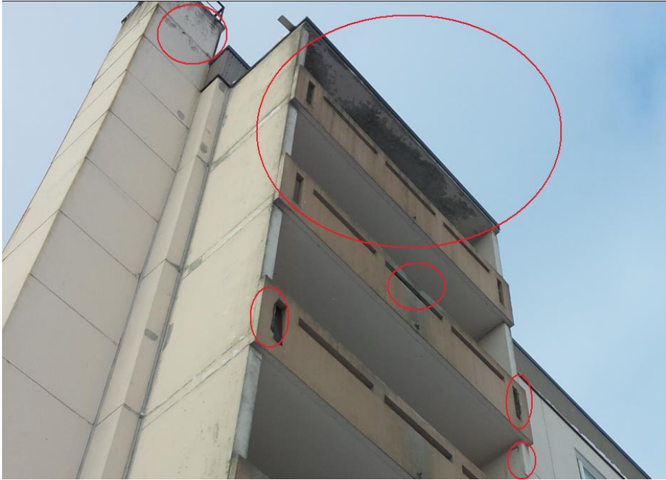
Bild 26 Omfattande skada på sjätte våningen, taktäckningen har troligen läckt vatten som kommit igenom betongen. Bitar har lossnat från balkongräcken på femte och fjärde våningen och armeringen är synlig. Pipan har också skador upptill.
