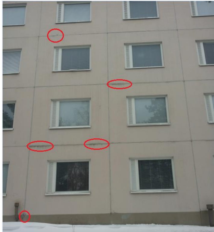
Bild 10 Spricka i elementet på fjärde våningen, kan tyda på korrosionsskada/frostvittring. Sprickor också på sockeln. Smuts har runnit från fogarna.
