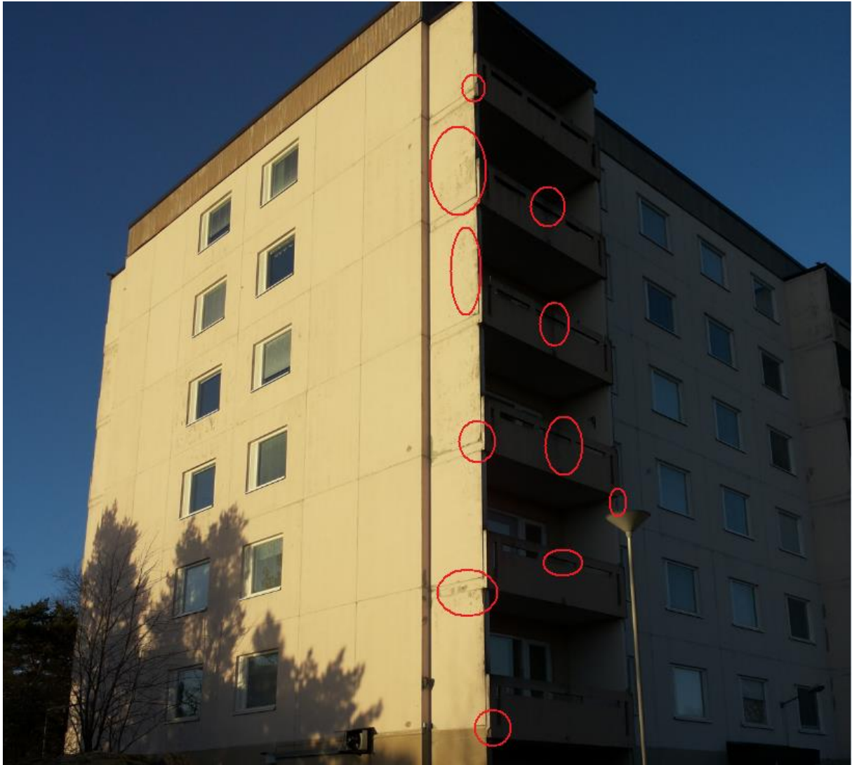
Bild 2 Balkongtornen har omfattande skador i räcken ser man korrosionsskador där bitar av betongen släppt också i hörnen av räcken har det lossnat bitar. Från sidoväggarna har det också lossnat bitar av betong och på vissa områden är armeringen synlig.
