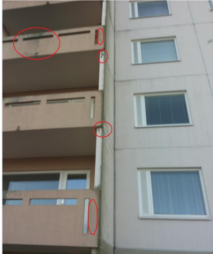
Bild 5 Närmare bild av skadorna på balkonerna. Man ser sprickor i räcken och bitar av betong som lossnar i hörnen och synlig armering. Balkongräcken har dessutom blivit smutsiga.
