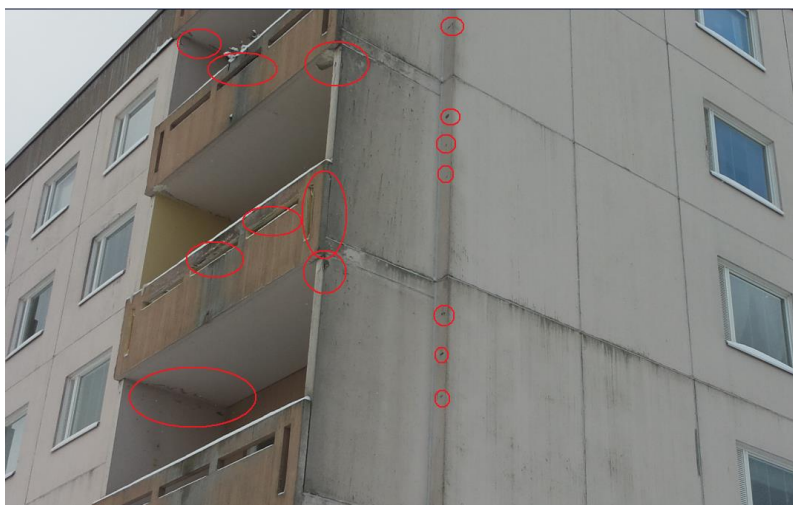
Figur 5. Betongbitar har lossnat från balkongräckena och lämnat synlig korroderad armering. Armeringen är även synlig på väggelementen. Speciellt i nedre hörnen av räckena är det vanligt med skador. Bilden är av TALO A. © Andreas Pettersson. (bilaga 1)
