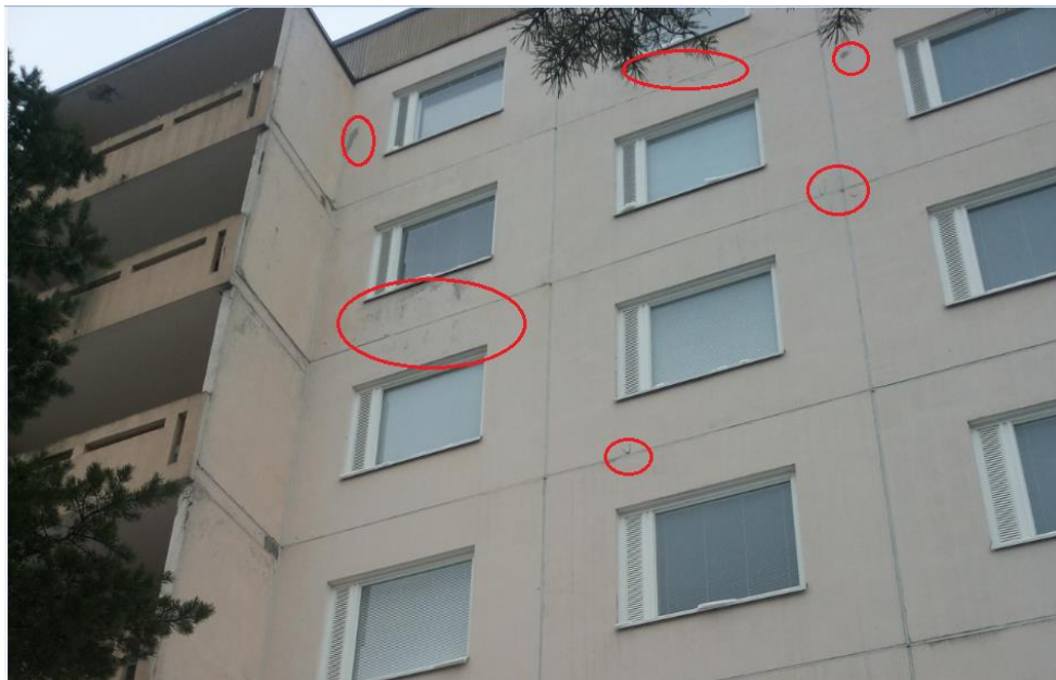
Bild 11 Sprickor i elementen fjärde och femte våningen. Omfattande frostvittringsskador på femte våningen, sprickor under vattenplåten och möjligen synlig armering. På sjätte våningen syns även frostvittringsskador.
