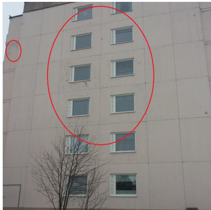
Bild 17 Frostvittringsskador från sjätte våningen ner till andra våningen, längst framskridet på fjärde våningen. Man ser också skador på balkongtornet.
