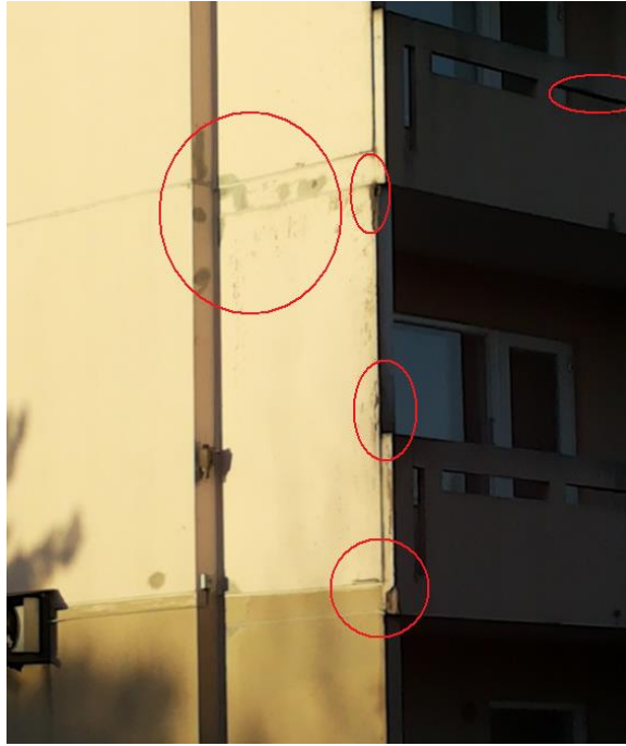
Bild 3 Närmare bild av skadorna på balkonerna. Här syns också lappningar som antagligen gjorts 2010.
