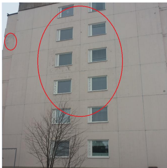
Figur 3. Omfattande frostvittring på södra fasaden av TALO A © Andreas Pettersson. (bilaga 1)
