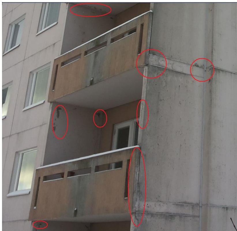
Bild 7 Närmare bild av skadorna på balkonerna. Man ser sprickor i räcken och bitar av betong som lossnar i hörnen och synlig armering. Räckena har dessutom börjat lossna från sidoväggarna.
