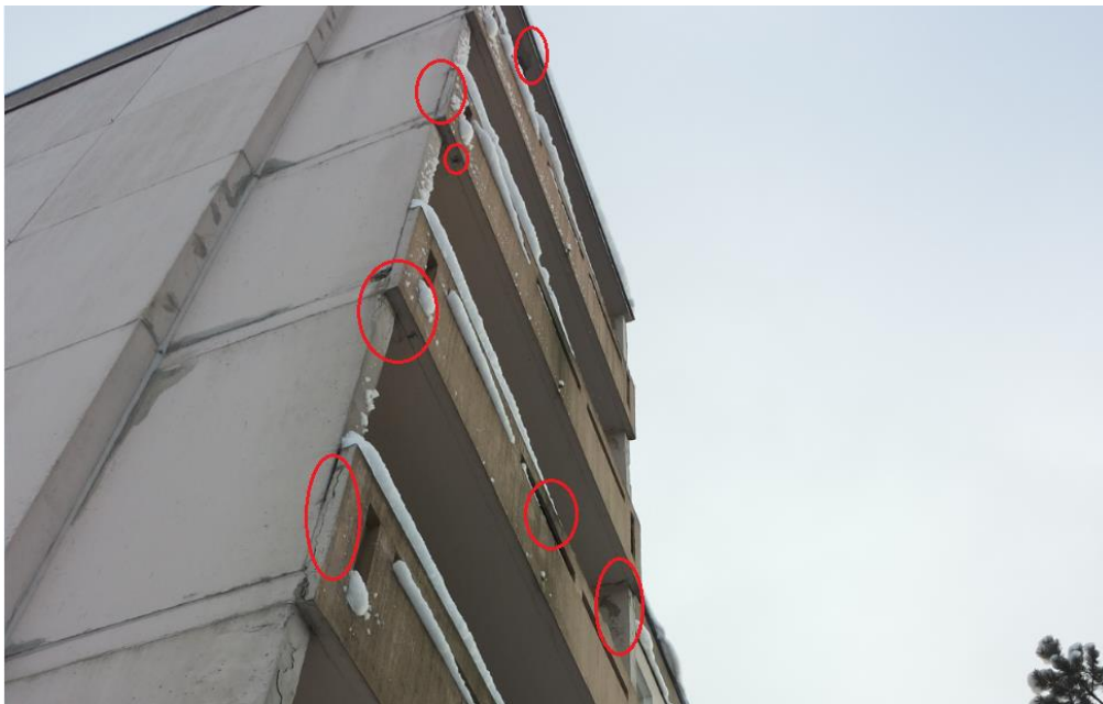
Bild 13 Närmare bild av skadorna på balkonerna. Man ser sprickor i räcken och bitar av betong som lossnar i hörnen och synlig armering. Räckena har dessutom börjat lossna från sidoväggarna. Sprickor i sidoväggarna. Färg har också lossnat och man ser lappningar som gjorts tidigare.
