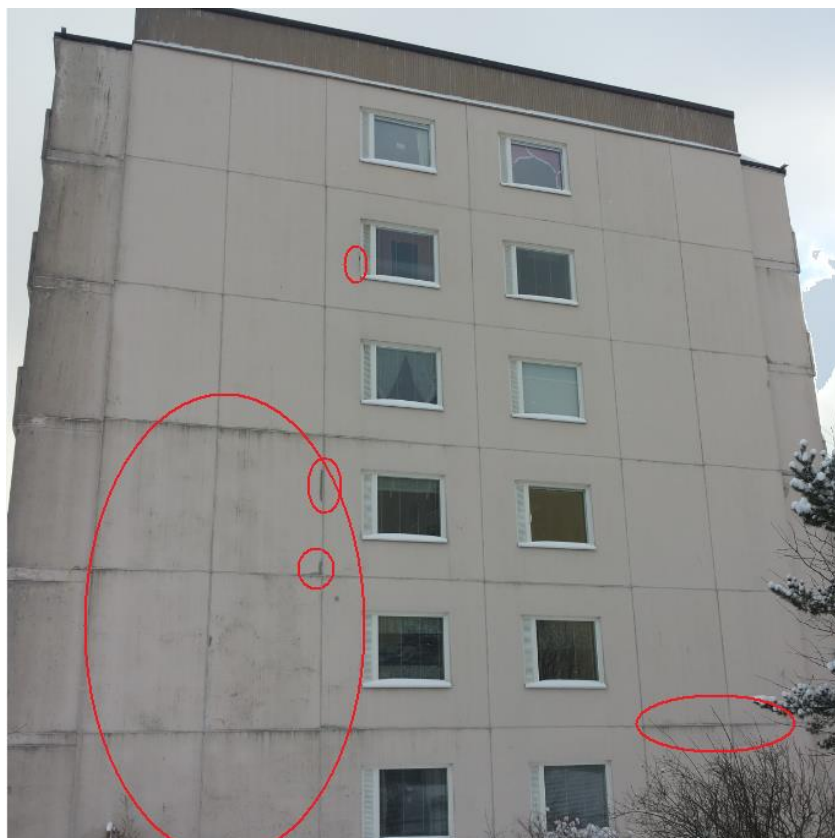
Bild 9 Nersmutsad fasad, kan vara tecken på frostvittring. Lappningar från 2010, kanten har lossnat vid fönstret på femte våningen. Inga större synliga skador.
