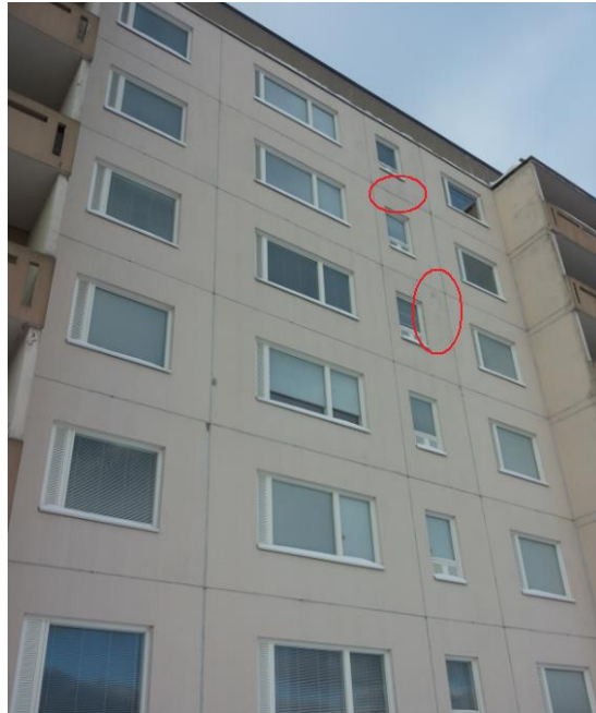
Bild 24 Början till frostvittring på fjärde och sjätte våningen annars inga synliga fel förutom några lappningar som gjorts.
