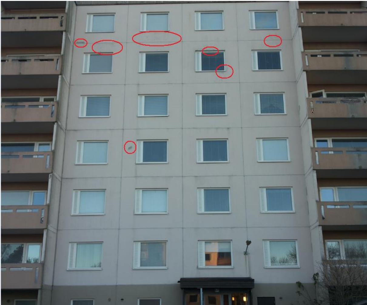
Bild 1 På östra fasaden av TALO A ser man inte så många synliga fel förutom att på femte och sjätte våningen ser man början av frostvittringsskador. På tredje våningen ser man en lappning som antagligen gjorts i samband med att elementfogarna förnyades 2010.
