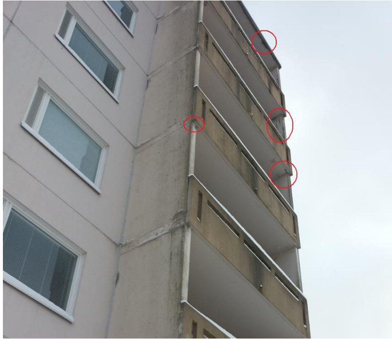
Bild 22 Undre kanterna av betongräcken är skadade och speciellt på femte våningen är sidoväggen skadad. Taket på sjätte våningen verkar också ha skador.
