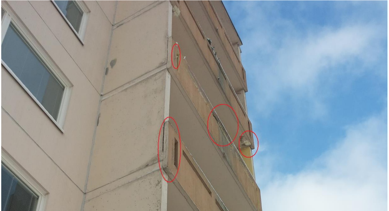
Bild 6 Närmare bild av skadorna på balkonerna. Man ser sprickor i räcken och bitar av betong som lossnar i hörnen och synlig armering. Räckena har dessutom börjat lossna från sidoväggarna.
