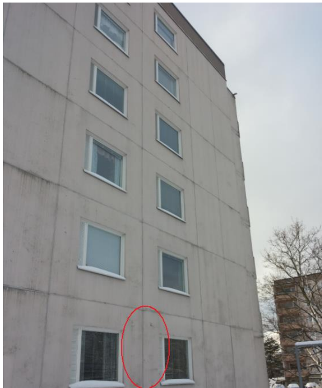
Bild 28 Början till frostvittring på första våningen och fasaden smutsig. ”Smutsen” kan också bero på frostvittring eller så kan det vara frågan om alger som börjat växa i elementfogarna.
