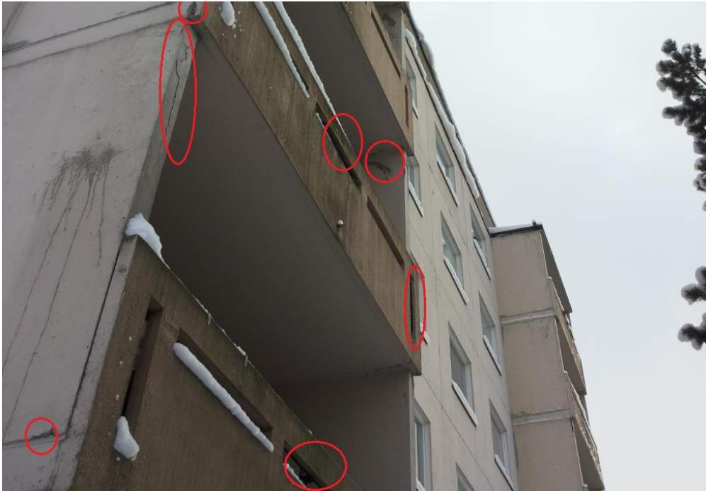
Bild 12 Närmare bild av skadorna på balkonerna. Man ser sprickor i räcken och bitar av betong som lossnar i hörnen och synlig armering. Räckena har dessutom börjat lossna från sidoväggarna. Sprickor i sidoväggarna.
