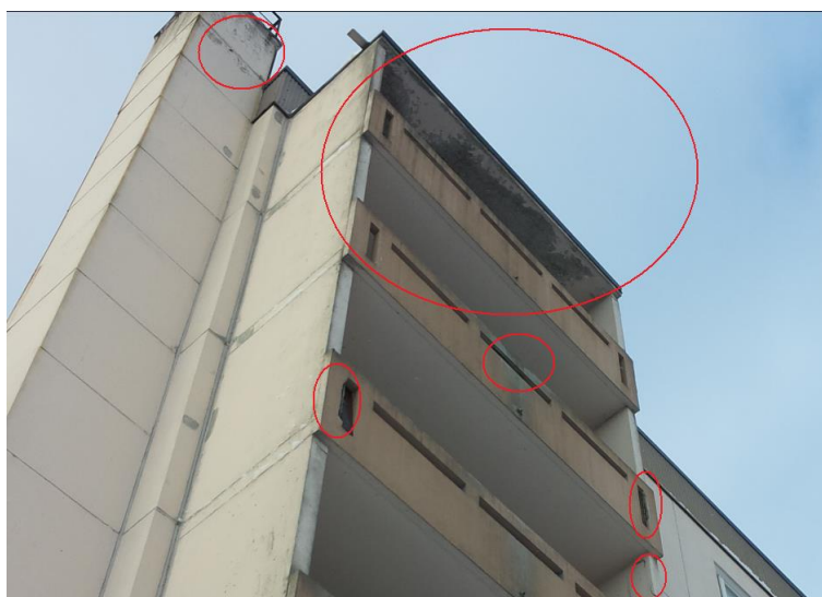
Figur 6. Motsvarande skador i balkongerna finns också i TALO B. På bilden syns skador i räcken där bitar av betong lossnat och lämnat efter sig synlig korroderad armering. På bilden syns även en större skada av balkongtaket. (bilaga 1) © Andreas Pettersson.
