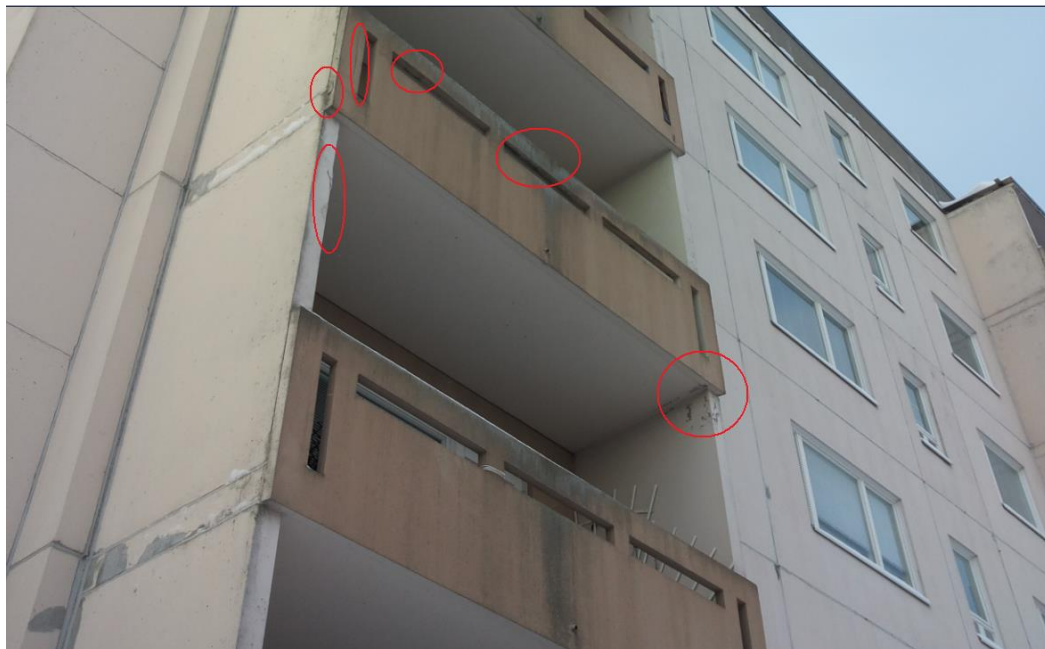
Bild 25 Sprickor på sidoväggarna på andra våningen. Hörnen under balkongräcket är skadade. Betongbitar har lossnat från balkongräcket på tredje våningen och armeringen är synlig.
