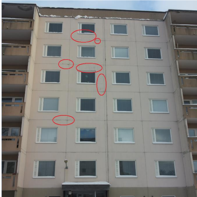
Bild 18 Bitar av betongelementen har lossnat på femte och sjätte våningen. Tecken på frostvittring syns på femte och sjätte våningen.
