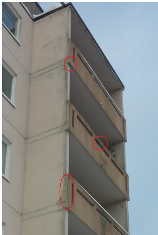
Bild 27 Spricka i räcket på fjärde våningen. Betongbitar av balkongräcket har lossnat på femte våningen och hörnet under räcket på sjätte våningen har början till frostvittring.
