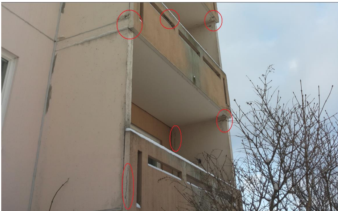
Bild 5 Närmare bild av skadorna på balkonerna. Man ser sprickor i räcken och bitar av betong som lossnar i hörnen och synlig armering.
