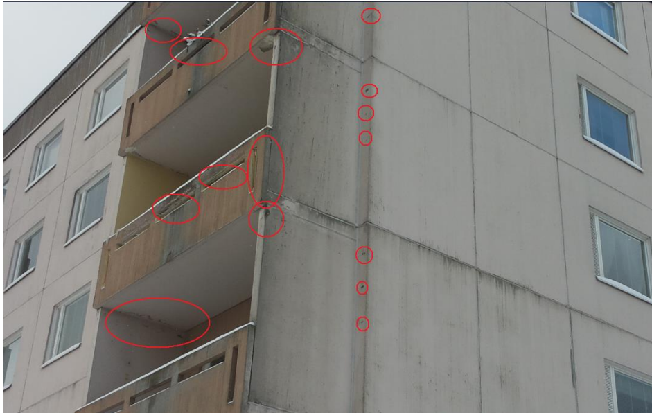
Bild 8 Närmare bild av skadorna på balkonerna. Man ser sprickor i räcken och bitar av betong som lossnar i hörnen och synlig armering. Räckena har dessutom börjat lossna från sidoväggarna. Armeringen är synlig på väggelementen mot norrfasaden. Färgen är svag och nersmutsad.
