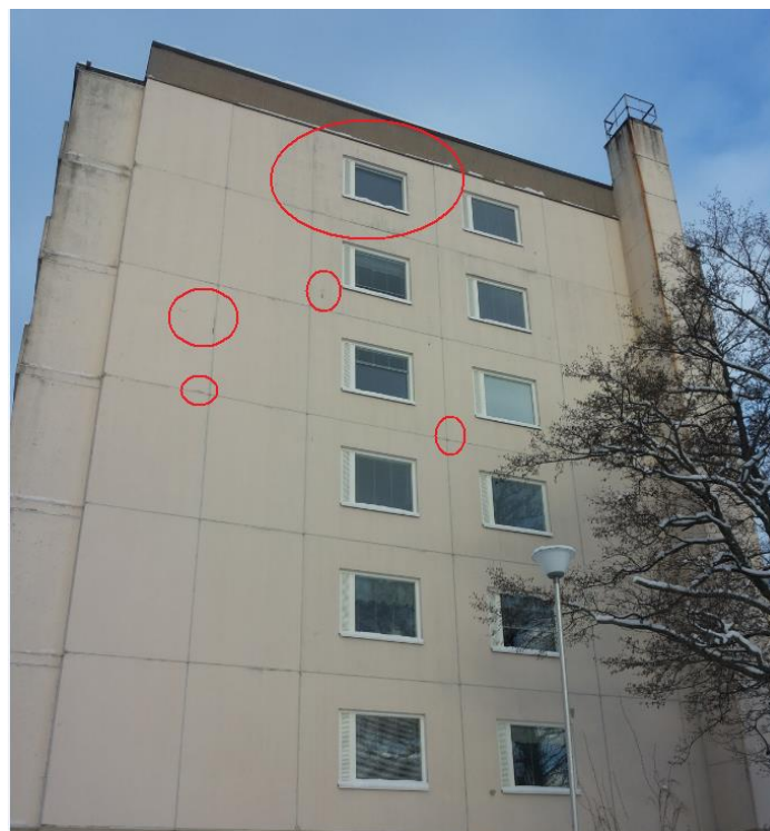
Bild 23 Sjätte våningen har början till frostvittringsskador. Enstaka sprickor i på femte och fjärde våningen.
