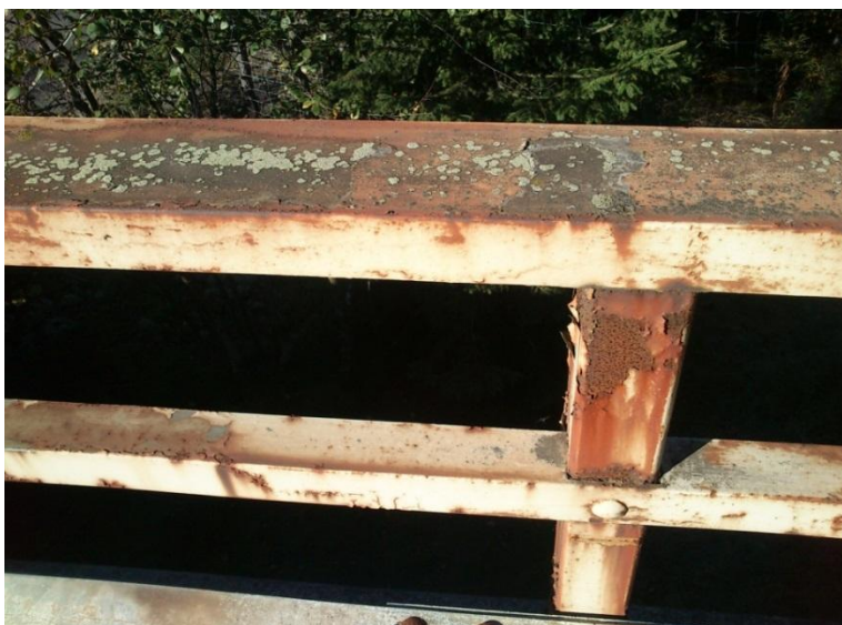
KUVA 11. Teräskaitteessa on pahoja ruostevaurioita (Kuva: Mauri Tommiska 2013)
