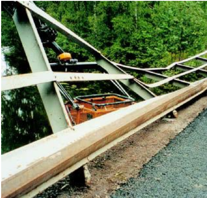
KUVA 7. Törmäyksessä vaurioitunut teräskaide (Silko 2.311, Tiehallinto, 2004, 1)
