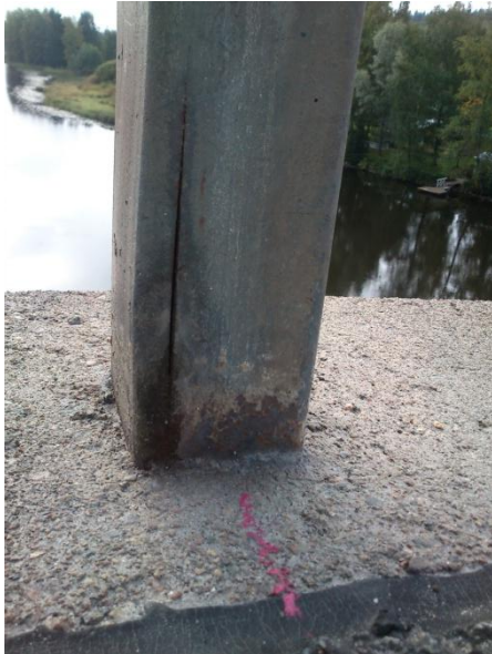
KUVA 8. Kaidepylväs, jossa pystyhalkeama juuressa (Kuva: Mauri Tommiska 2013)
