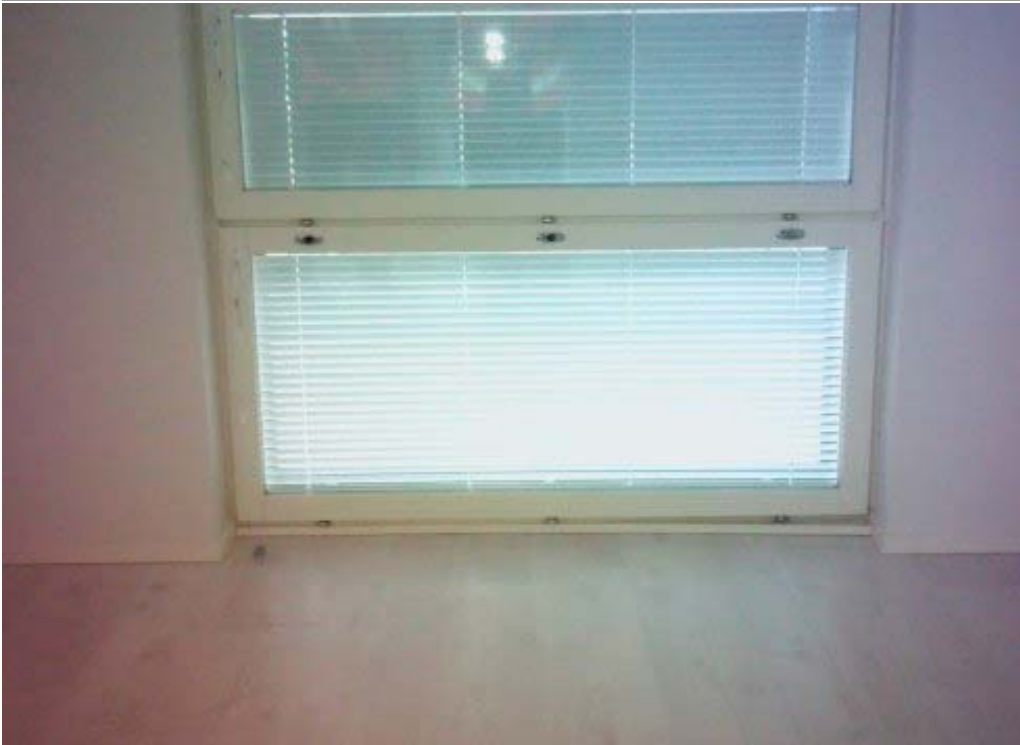
Ikkuna, lievä ilmavuoto karmin ja lattian välistä
