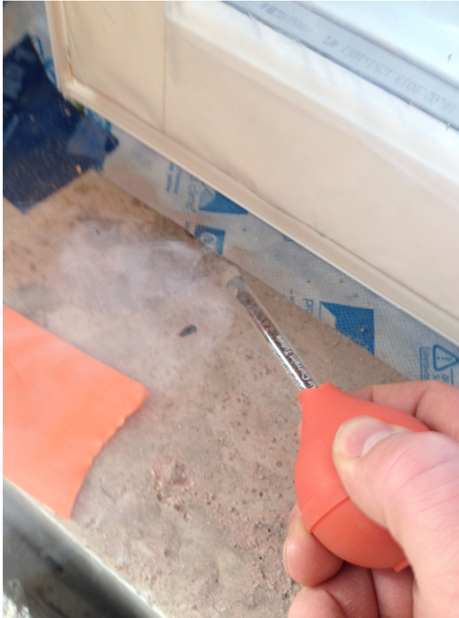
KUVA 24. Merkkisavulla havaittu vuotoilmakohta, ovikarmin ja alapohjan liitos.
