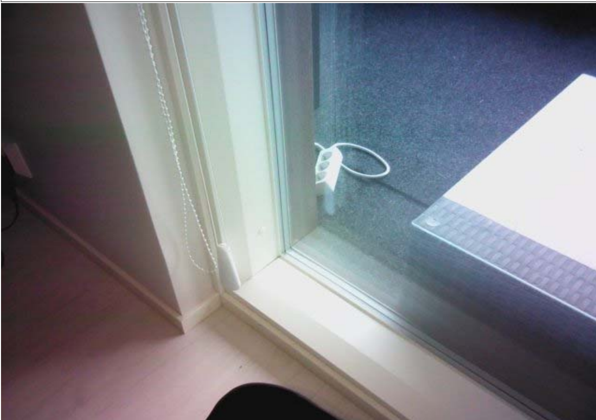
Kiinteä ikkuna, lievä karmivuoto
