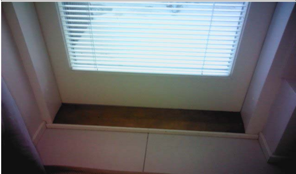
Parvekeovi, lievä ilmavuoto
