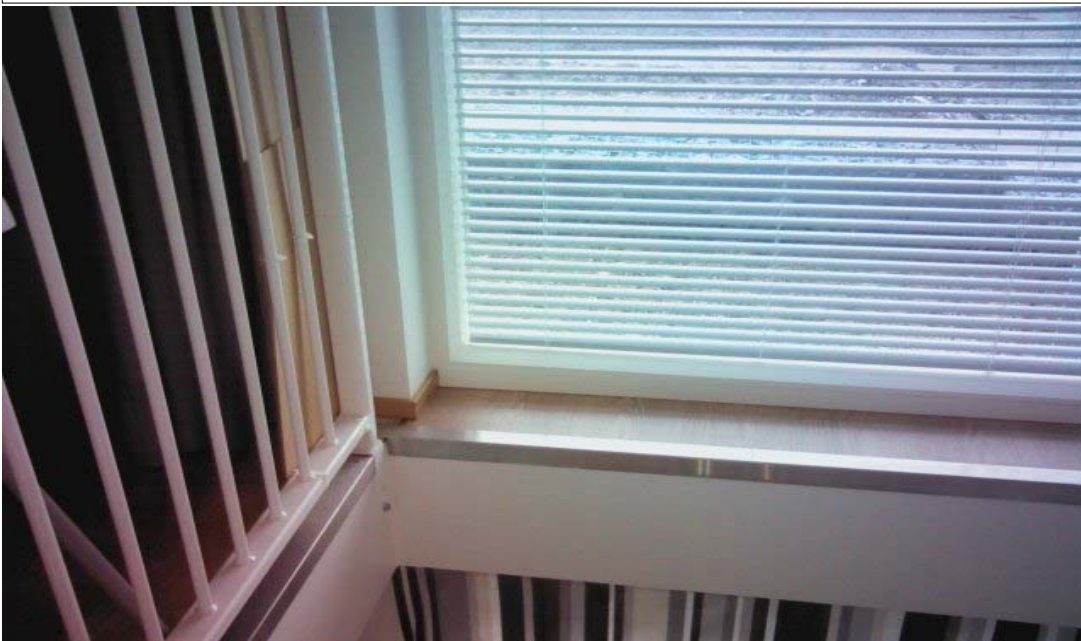
Kiinteä ikkuna, lievä ilmavuoto karmin ja lattian välistä
