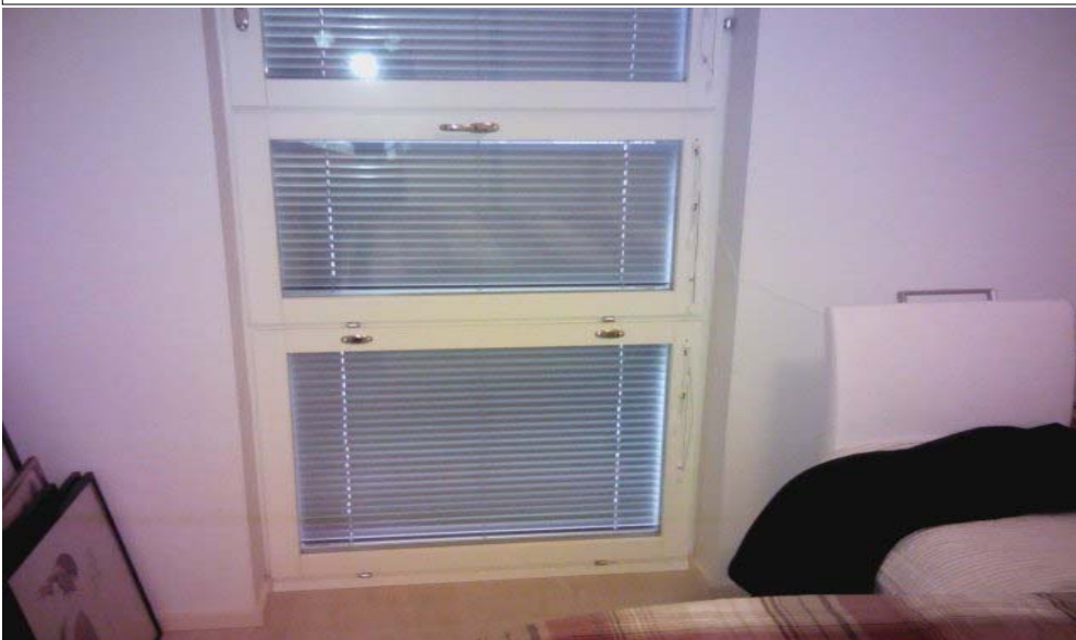
Ikkuna, laaja tiivistevuoto vasemmassa reunassa sekä oikeassa alakulmassa
