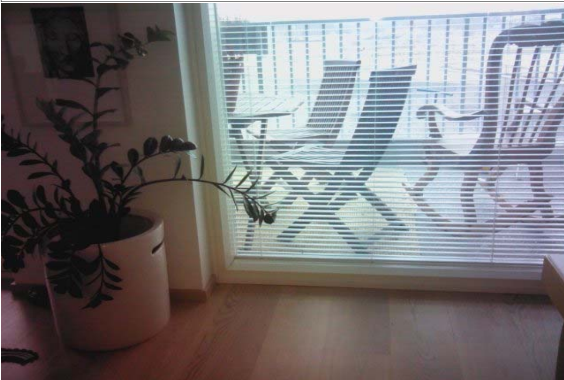
Kiinteä ikkuna, lievä ilmavuoto lasin ja karmin välistä
