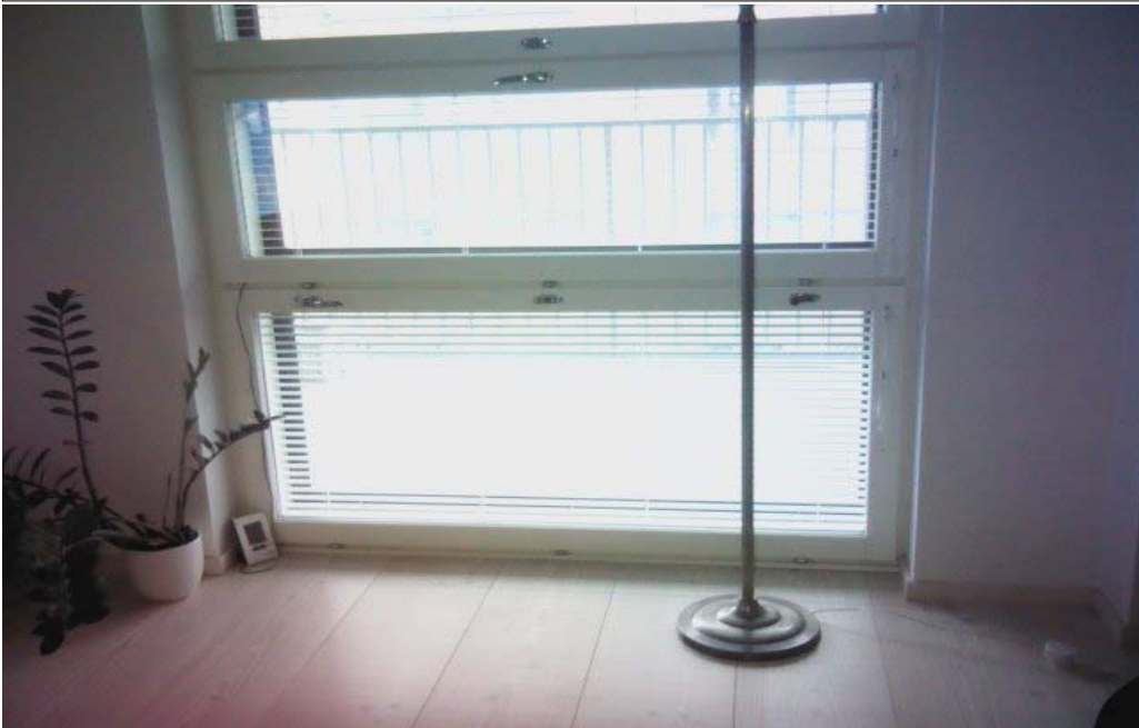
Ikkuna, viivamaista ilmavuotoa tiivisteiden sekä karmin ja lattian välistä
