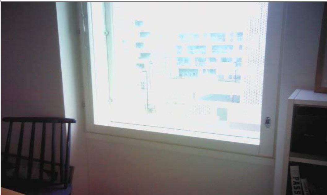
Ikkuna, lievä ilmavuoto lasin ja pokan välistä
