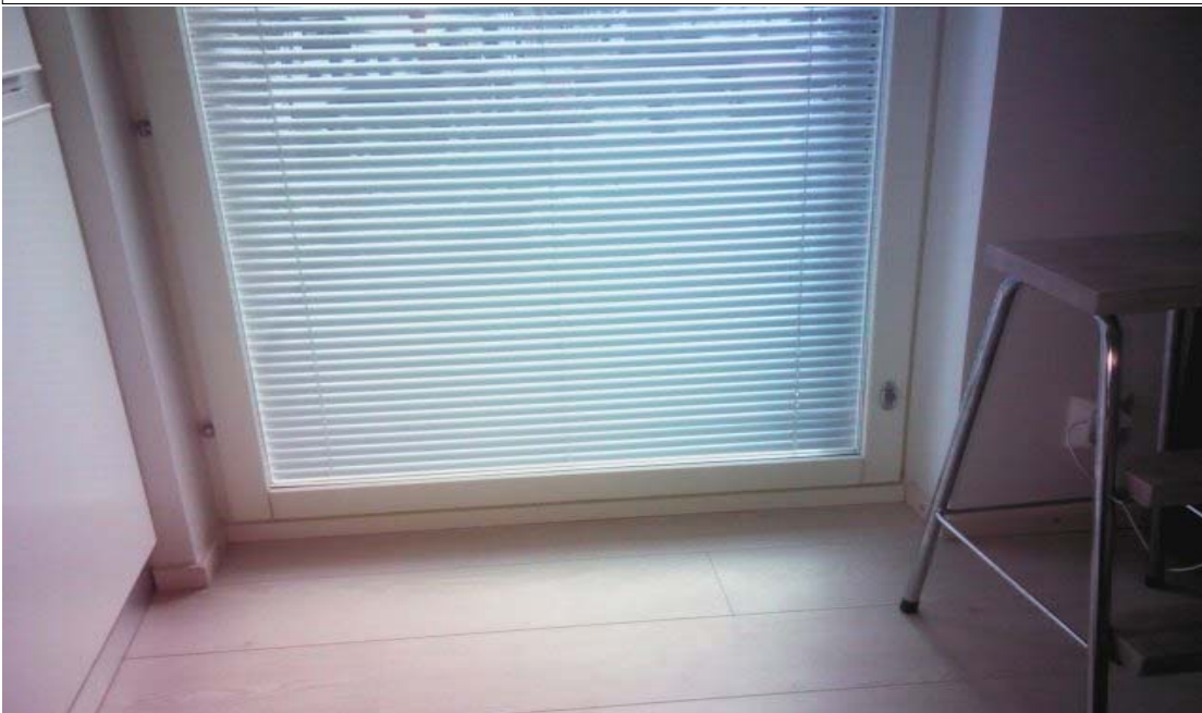
Ikkuna, lievä tiivistevuoto
