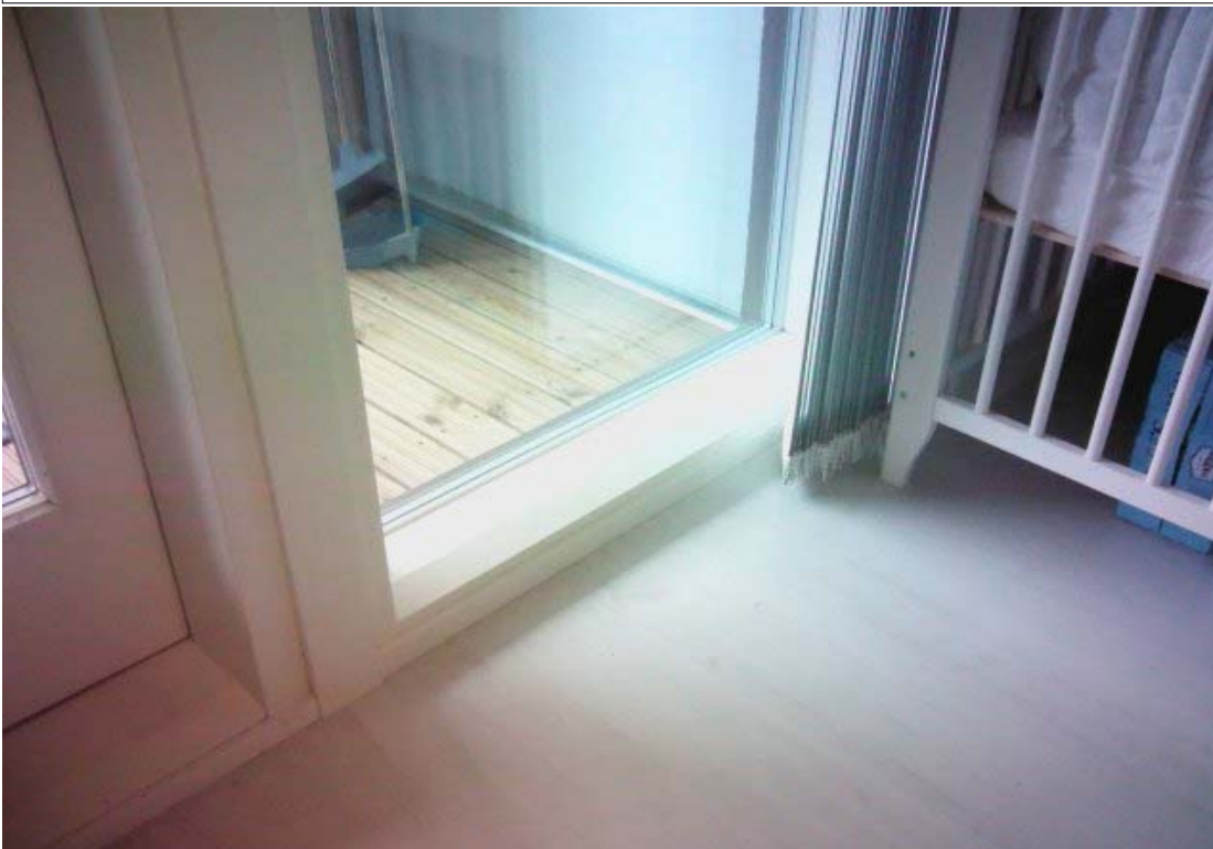
Parvekeovi, lievä tiivistevuoto
