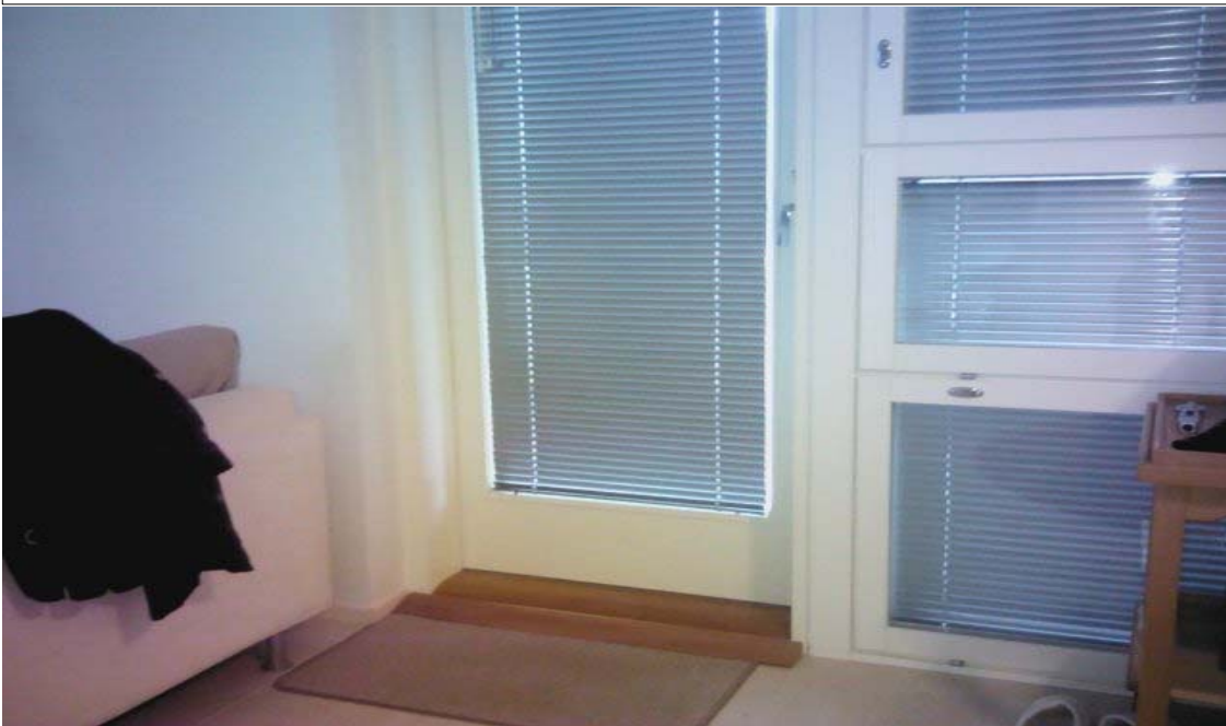
Parvekeovessa viivamainen tiivistevuoto alhaalla, ikkunan alakulmassa tiivistevuoto
