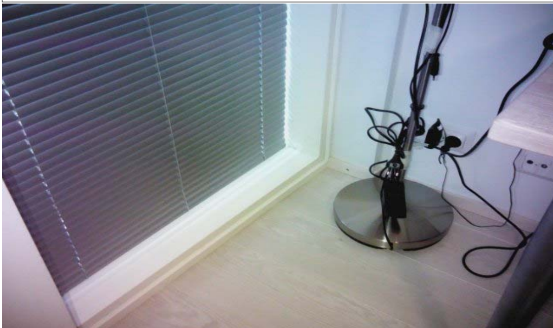
Kiinteä ikkuna, ilmavuoto karmin ja seinän välistä
