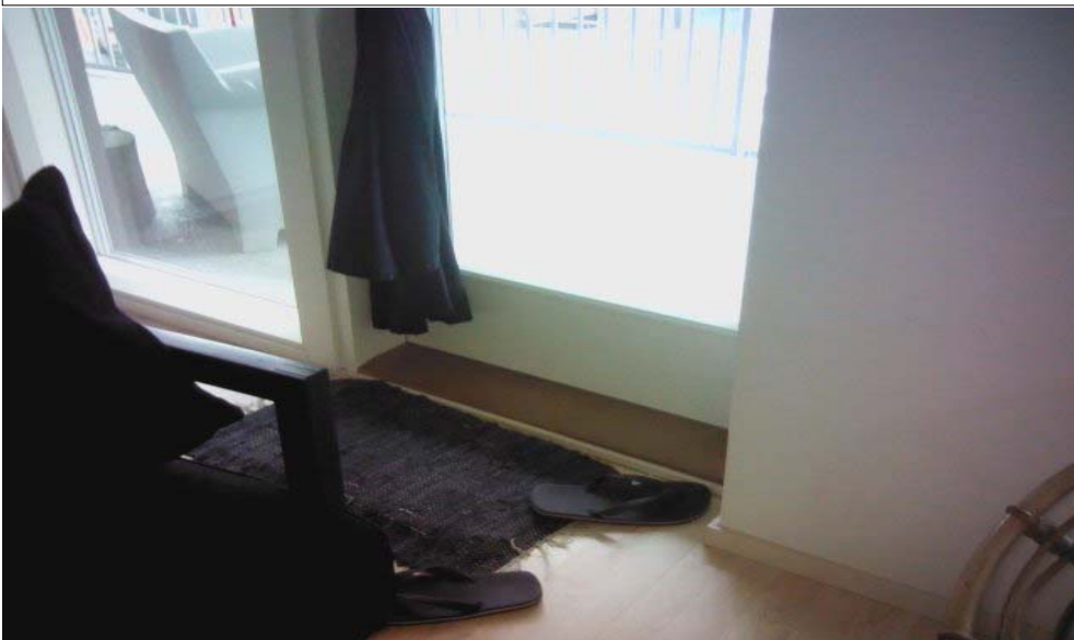
Parvekeovi, lievä tiivistevuoto
