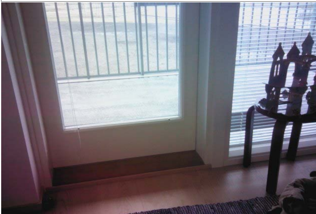
Parvekeovi, viivamainen tiivistevuoto
