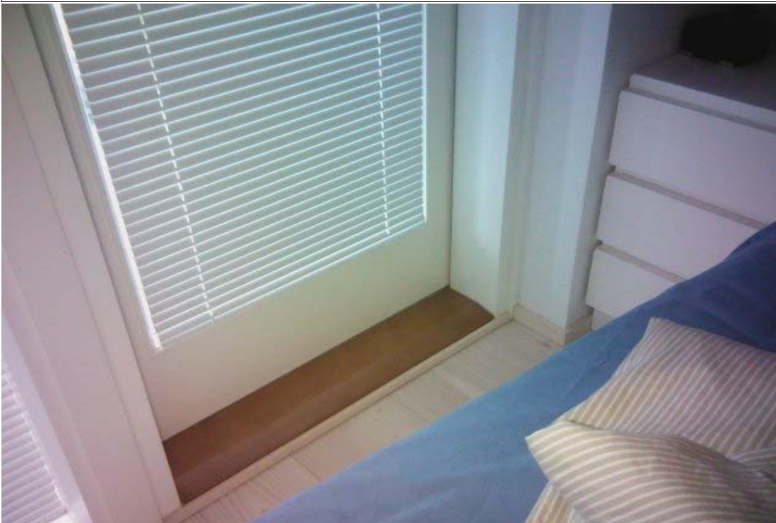
Parvekeovi, viivamainen tiivistevuoto
