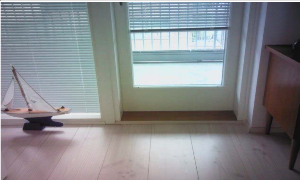
Parvekeovi, lievä tiivistevuoto
