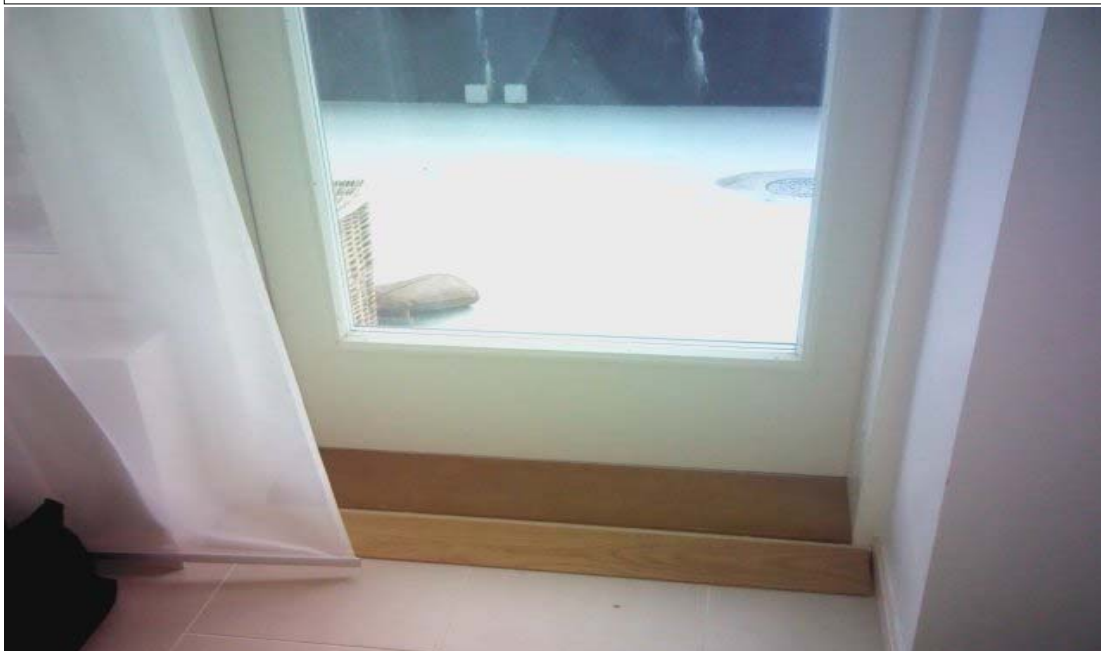
Parvekeovi, lievä tiivistevuoto
