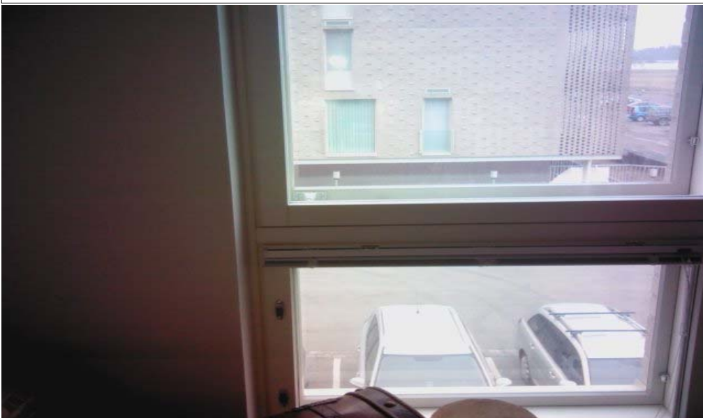
Ikkuna, kulmassa lievä tiivistevuoto
