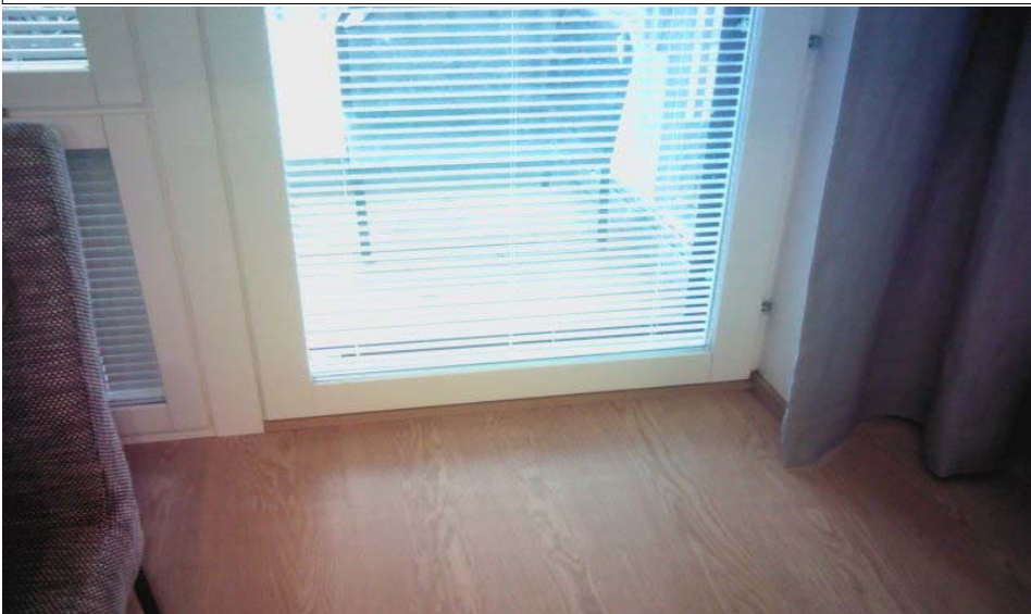
Ikkuna, lievä ilmavuoto karmin ja lattian välistä
