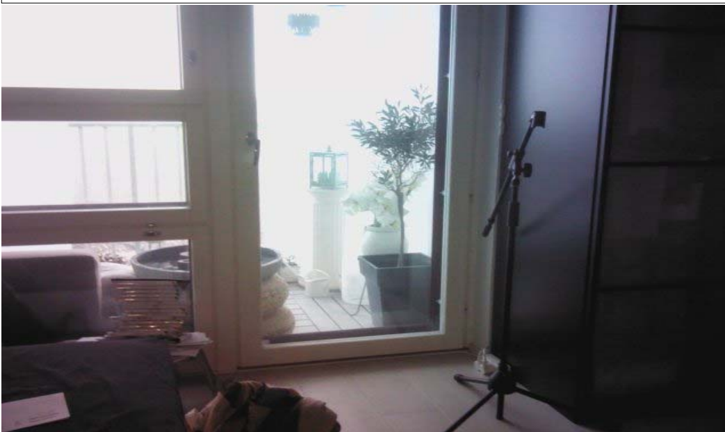
Parvekeovi, laaja viivamainen tiivistevuoto
