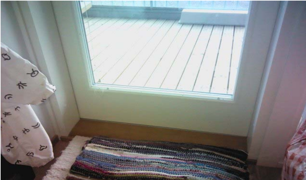
Parvekeovi, lievä tiivistevuoto
