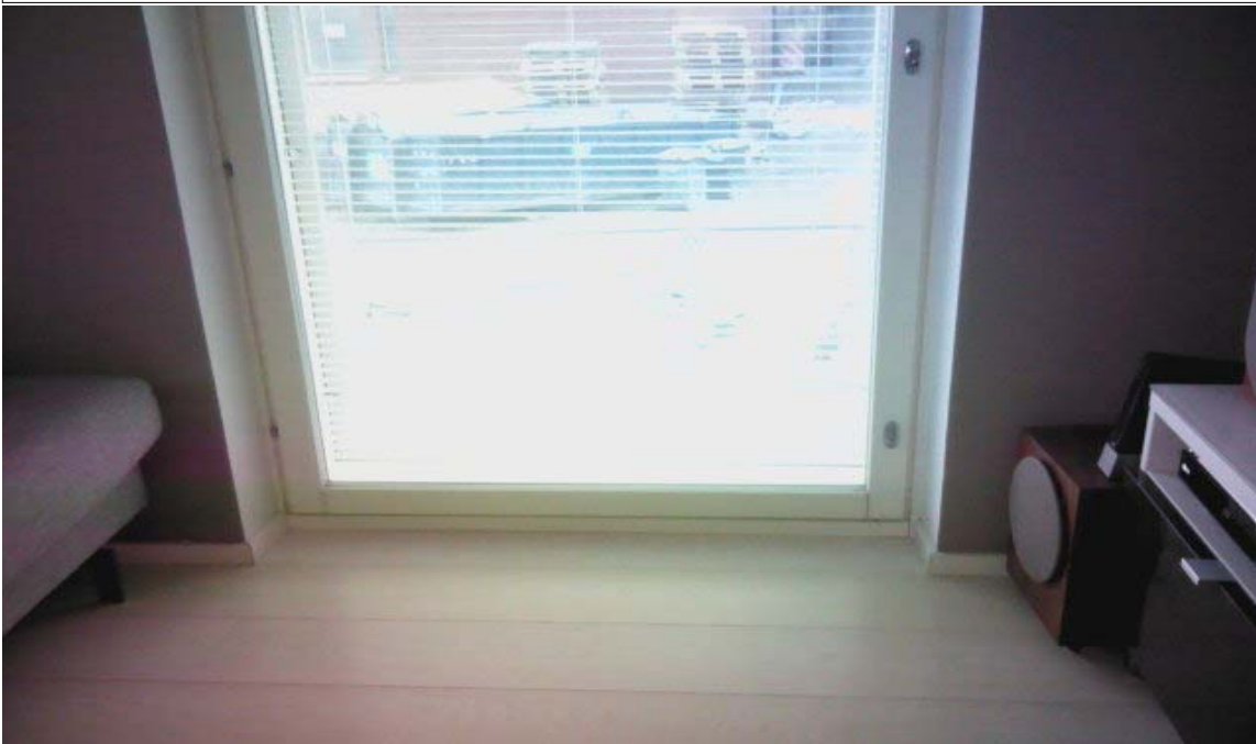
Ikkuna, vähäinen tiivistevuoto
