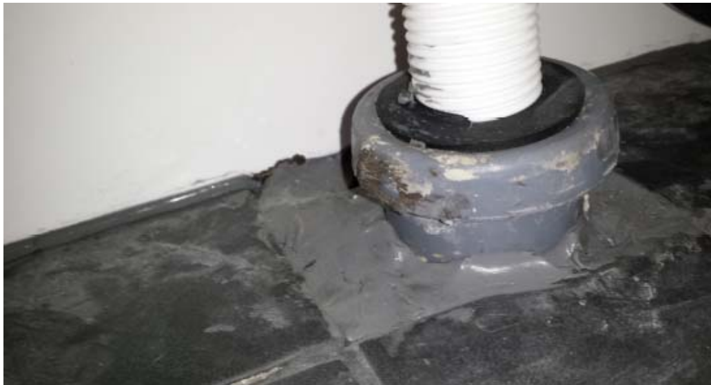
Kuva 12. Laatupoikkeama laatoitustyössä Hollolan Hannan työmaalla. (Kuva: Kristian Rantaharju 2014)
