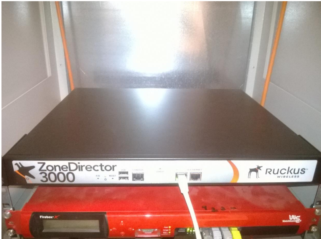
KUVA 3. ZoneDirector 3000 asennettuna ristikytkentäkaappiin.
