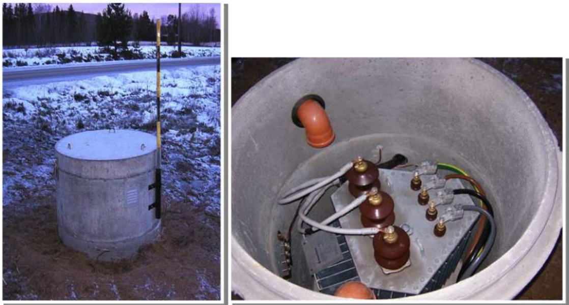
Kuva 11. Esimerkki kaapeliverkon uuden tyyppisestä jakelumuuntamorakenteesta (Lakervi & Partanen 2010, 175)
