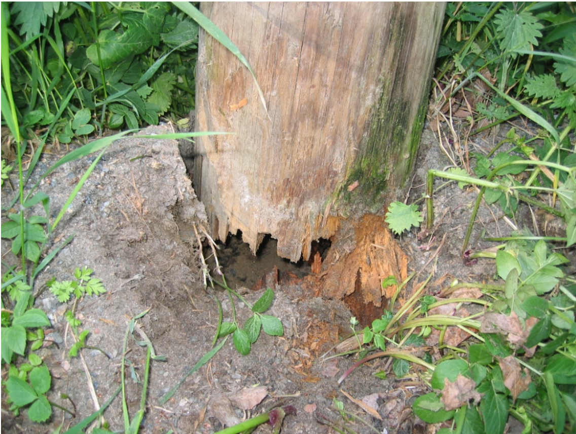
Kuva 6.2. Tarkempi kuva tukipylvään lahoisuusvauriosta.
