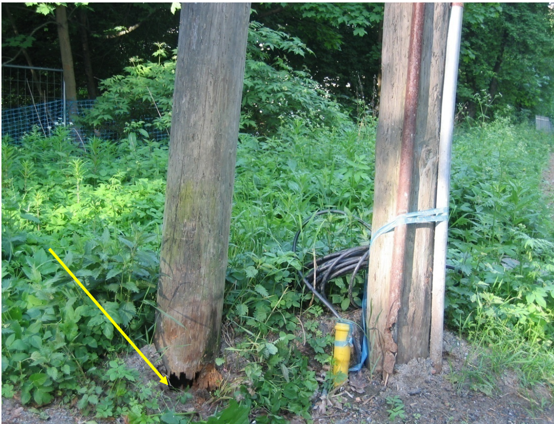
Kuva 6.1. Tukipylväs on katkennut lahoisuuden takia.
