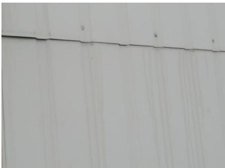
Kuva 12. Valumajälkiä levyjen saumassa (Kuntotutkimusseloste, 2011, 9)
