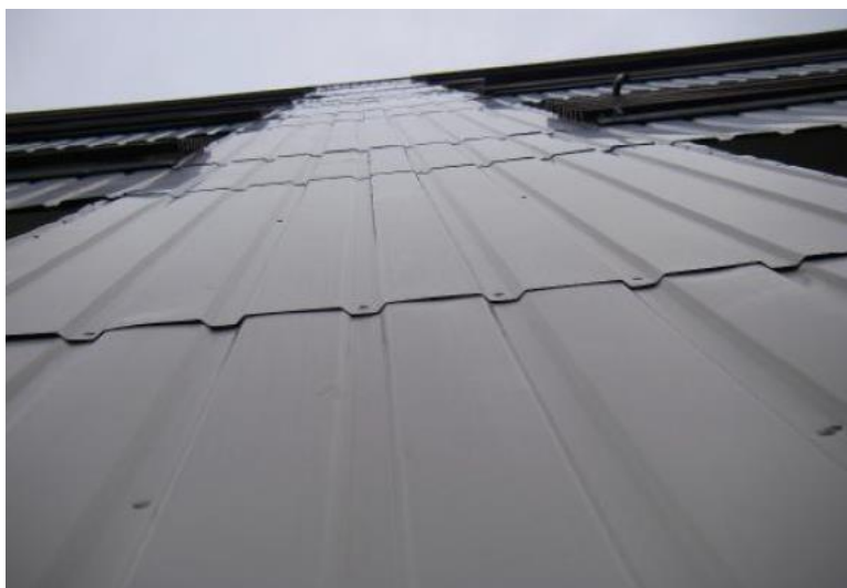
Kuva 11. Julkisivun profiiliteräslevyt ovat yhä pääosin hyväkuntoisia (Kuntotutkimusseloste, 2011, 9)
