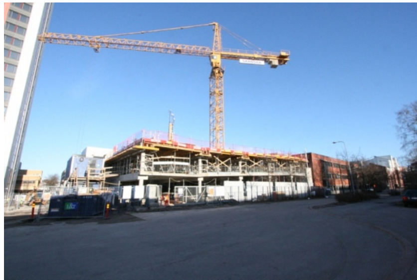
Kuva 3. Rakennushankkeen runkovaiheessa ison torninosturin kustannukset ovat todella merkittävä menoerä. Aikataulua voidaan nopeuttaa tehokkaan urakkatyön avulla ja näin kustannukset alenevat. [8.]
