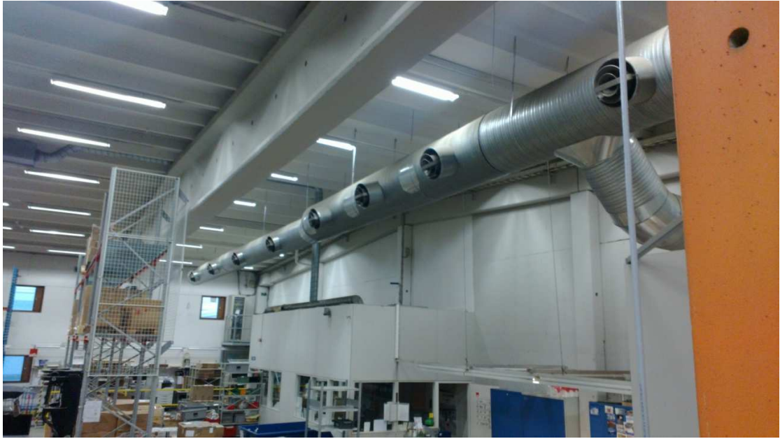
KUVA 12. Lähettämössä oleva vanha ilmastointikanava (17.10.2013)
