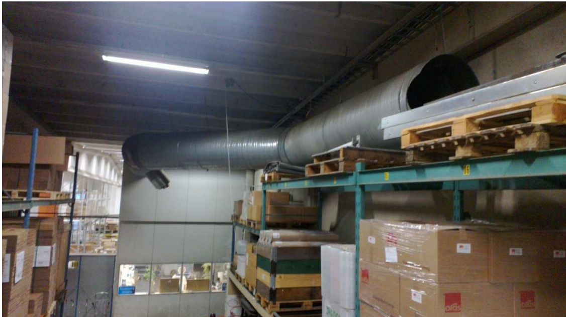
KUVA 11. Lähettämössä oleva vanha ilmastointikanava (17.10.2013)
