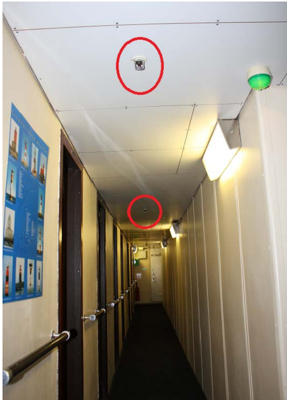
Kuva: Sprinklereitä aluksen asuinkäytävän katossa.
