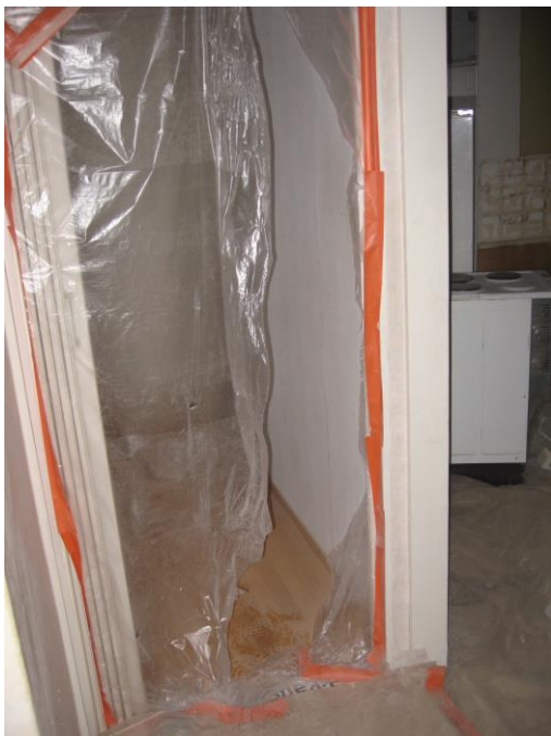
Kuva 6. Oviaukon rikkoutunut osastointi
