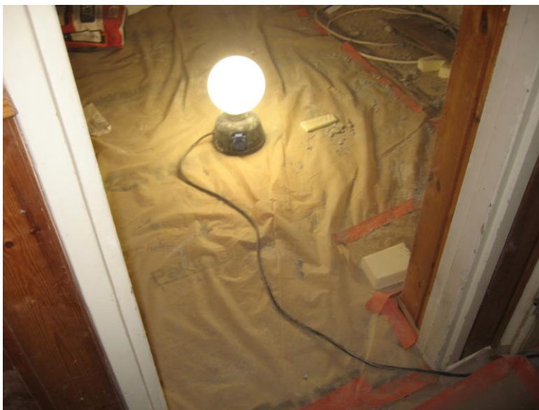
Kuva 8. Väärin sijoitettu työpistevalaisin
