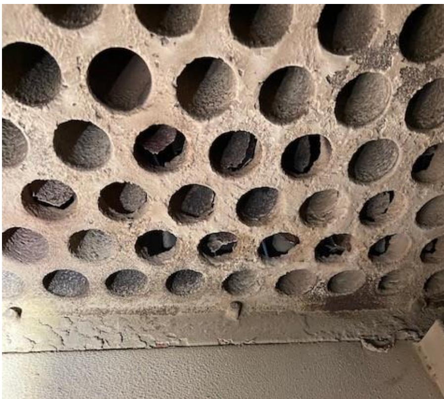
KUVA 7. Korroosion aiheuttamat vauriot putkilämmönvaihtimessa.
