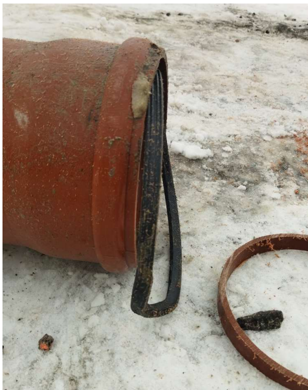
Kuva 15. Vioittunut tiiviste (Antti Löyttynen 2021).
