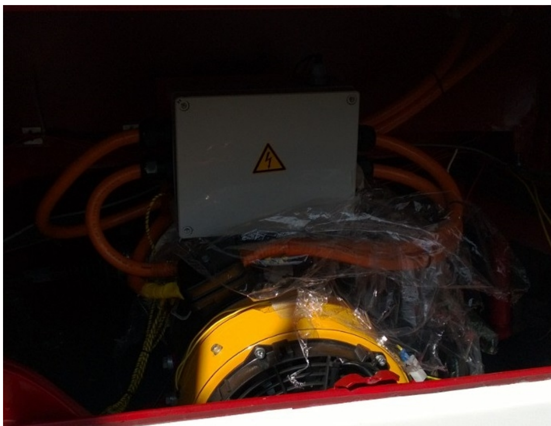
Kuva 2. Moottorin päällä on suunnanvaihtokontaktori koteloituna ja moottorin perässä sijaitsevat tuuletusritilä sekä moottoripuhallin. (Taberman 2013)
