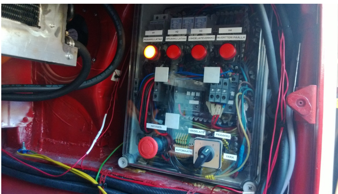
Kuva 7. OK01-latauksenohjauskeskus auton moottoritilassa lataamassa pääakustoa 230V Defa-pistokkeen kautta (Taberman 2013)
