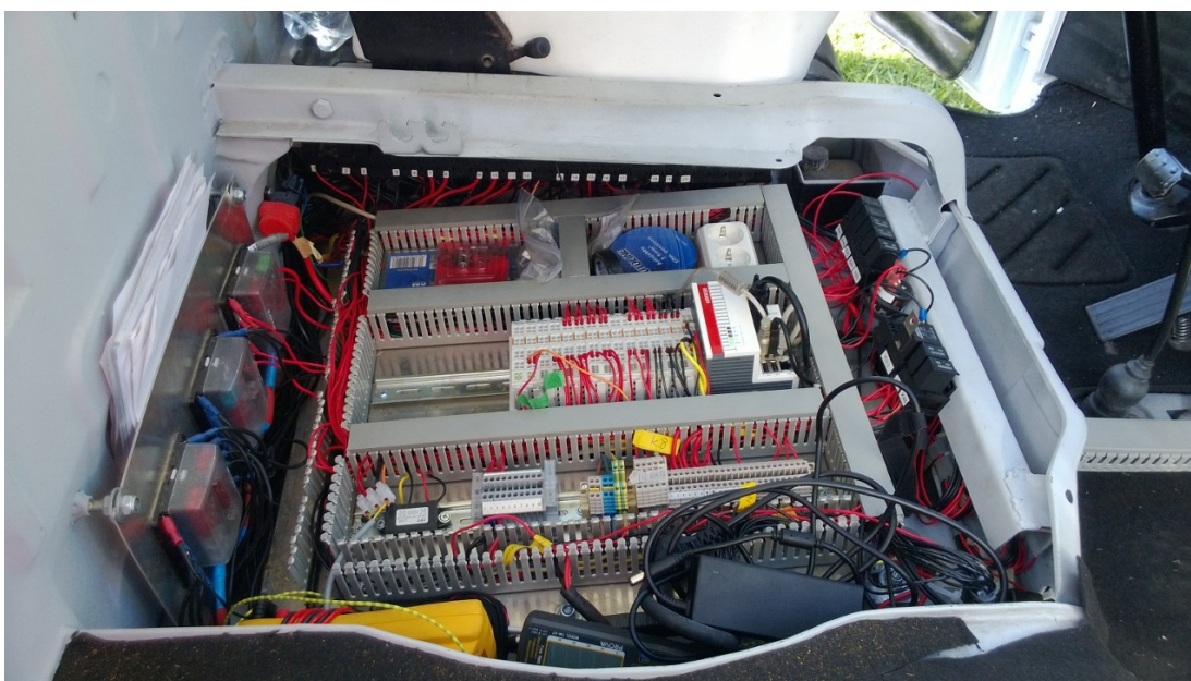
Kuva 10. OK02-keskuksen 12V- järjestelmän pääkomponentit etupenkkien alla (2013 Taberman)
