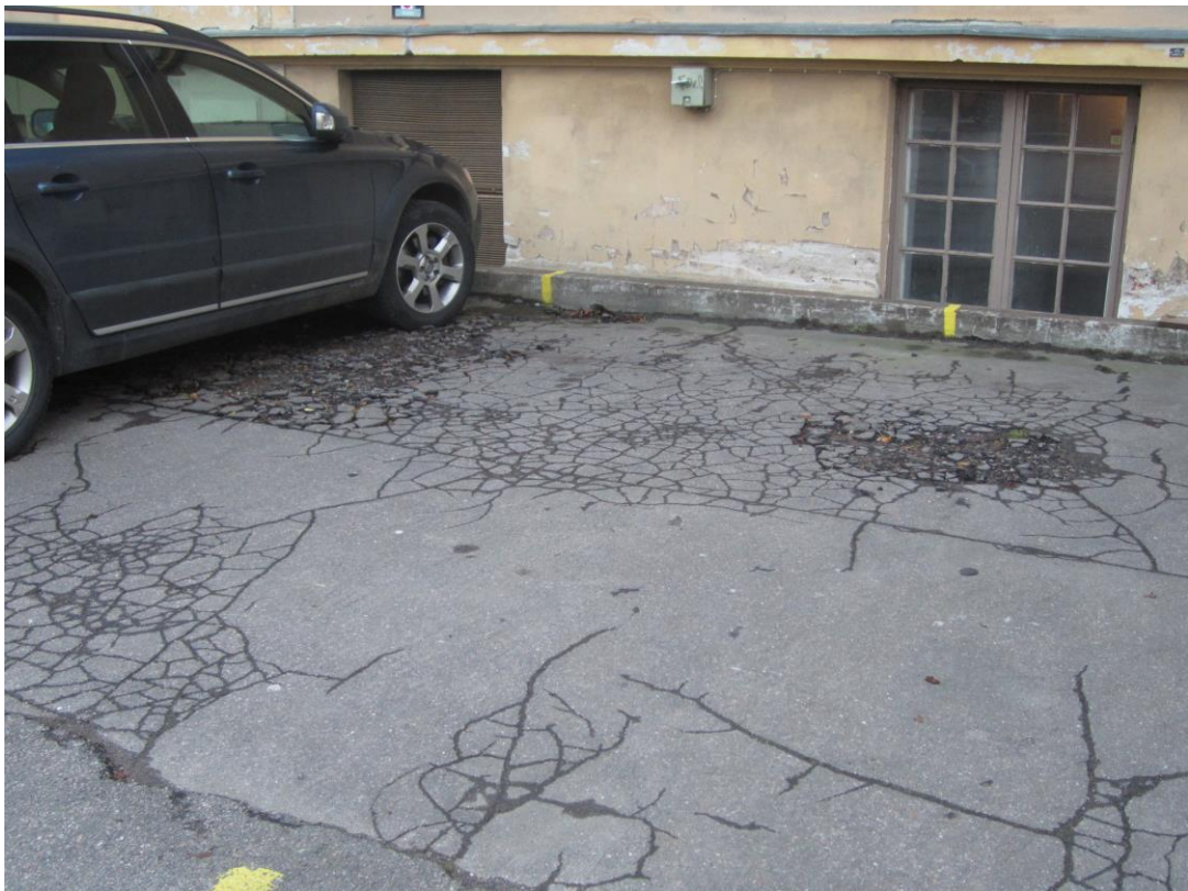
Kuva 17. Verkkohalkeilua parkkipaikalla. Syynä voi olla väsymisen lisäksi pakkaskatkeilua.
