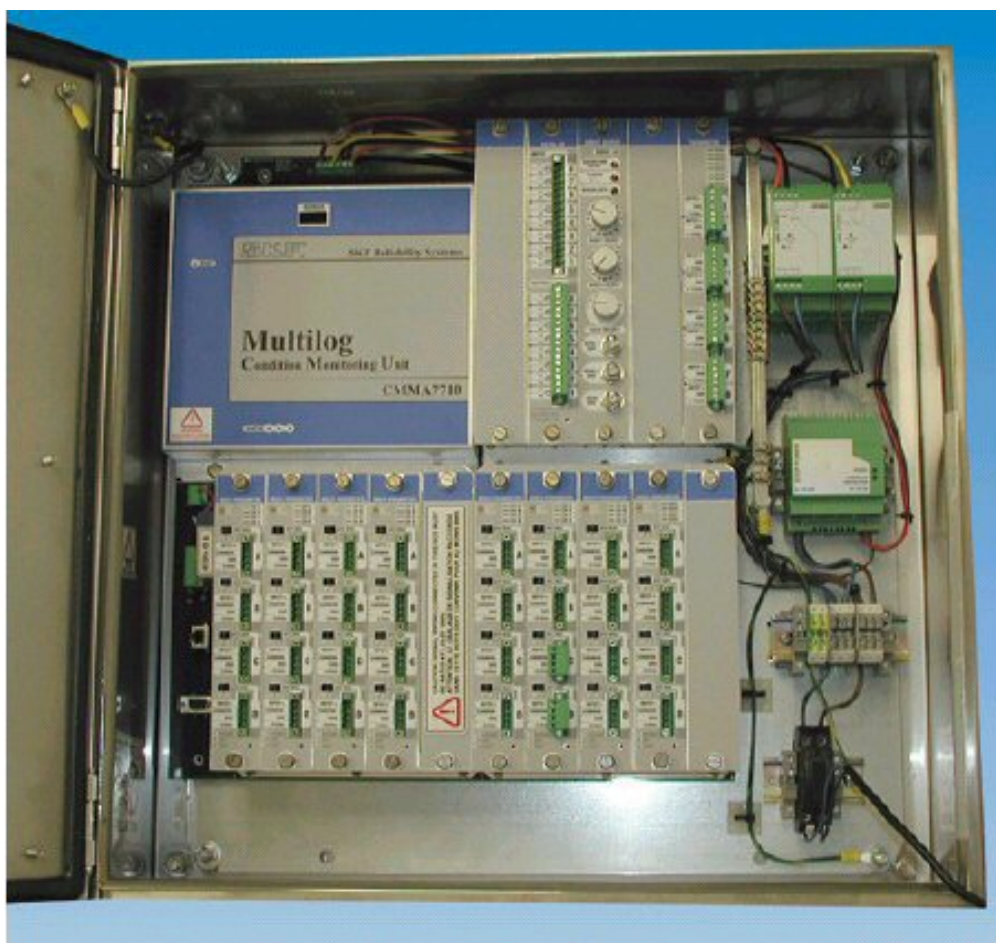
Kuva 42. SKF-valvontayksikkö (Local Monitoring Unit)
