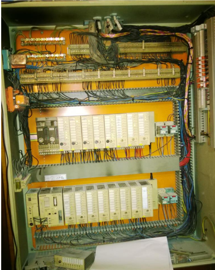
Kuva 7, Logiikkakaappi LG1 ja Siemensin Simatic S5 logiikka
