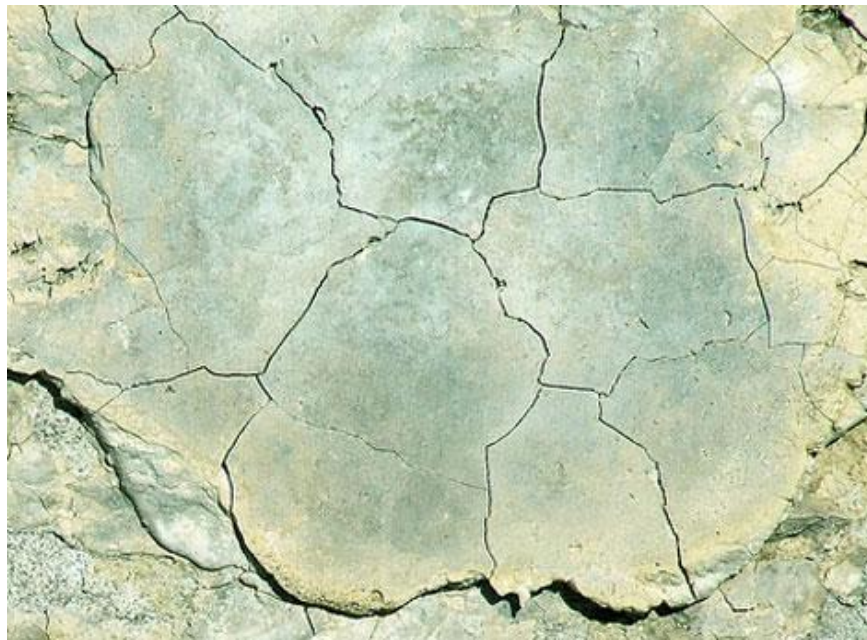
KUVA 14. Pakkasvaurioita betonissa (Popular Mechanics 2008.)
