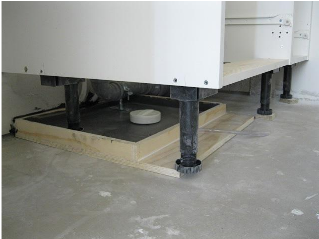
Kuva 11. LeakFence-vuotoallas asennettuna keittiökaapiston alle (Q Keittiöt, henkilökohtainen tiedonanto 2/2014).
