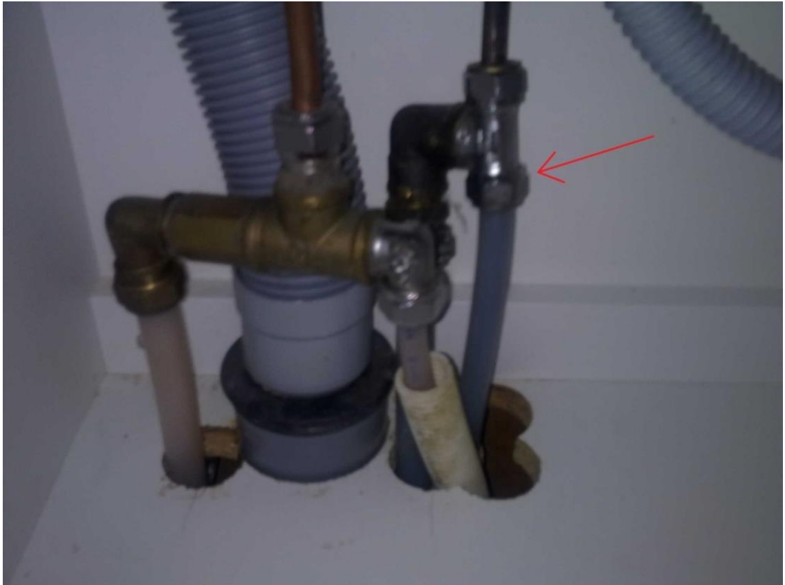
Kuva 6. Vuotokohta keittiökaapistossa (If Vahinkovakuutusyhtiö Oy, henkilökohtainen tiedonanto 12/2013).
