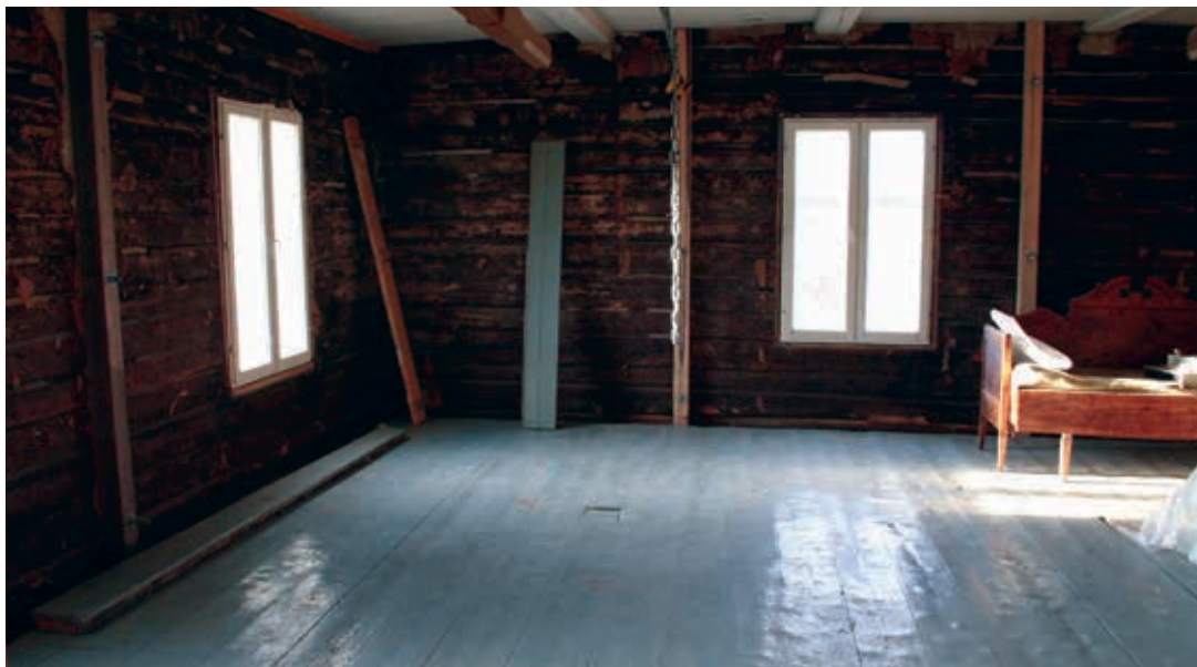
Kuva 9: Tuvan lattia ennen purkua. Lattian reunoilla kiertää irrotettavat lankut, joista multipenkkiin on voinut lisätä täytettä.
