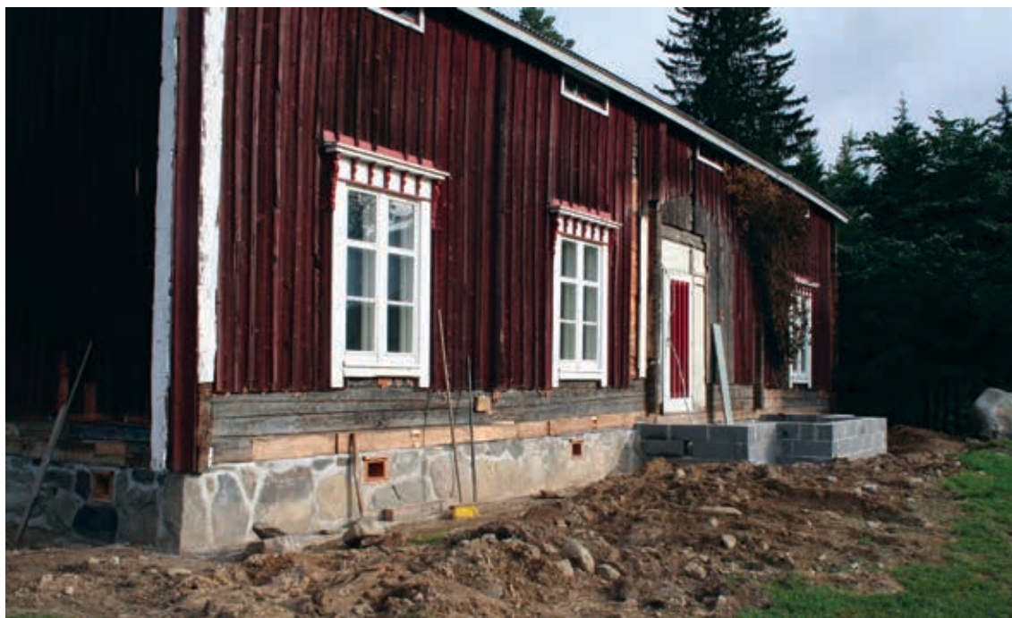
Kuva 8: Uusi kivijalka valmiina. Kivijalkaan tehtiin muurauksen yhteydessä uudet tuuletusaukot. Samalla lahovaurioiset alahirret vaihdettiin uusiin. Ylimääräinen maa poistetaan rakennuksen ympäriltä ja muotoillaan viettämään pois päin talosta.
