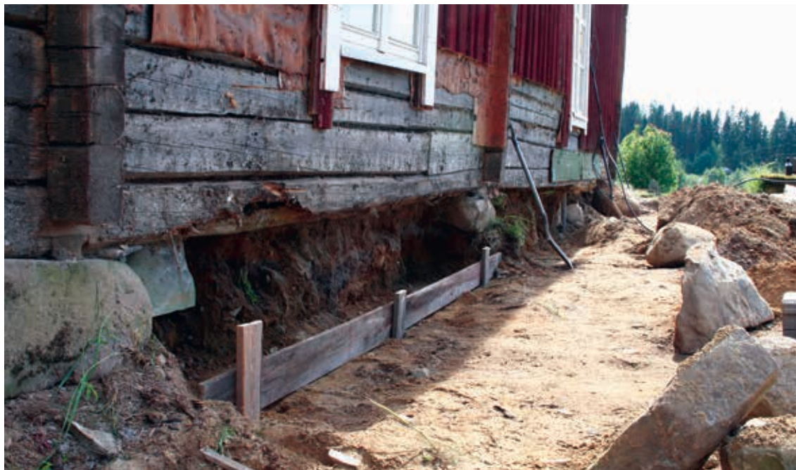
Kuva 7: Rakennuksen alle valetaan uutta anturaa, jonka päälle kivijalka muurataan. Kuvassa näkyy rakennuksen alla multipenkkimaata, joka poistetaan vasta lattian purkamisen jälkeen.
