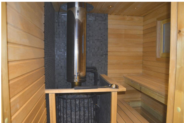
Kuva 3. Kiuas, joka on yhteydessä takkaan. Kiukaan yläpuolella on säiliö, jossa vesi lämpeää. (Kainiemen huvilat 2014.)
