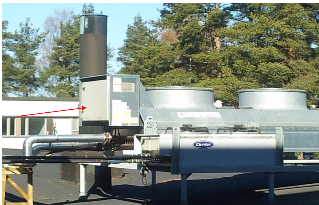
Kuva.1 Jäähdytysyksikkö, taajuusmuuttaja sijaitsee nuolen osoittamassa sähkökeskuksessa
