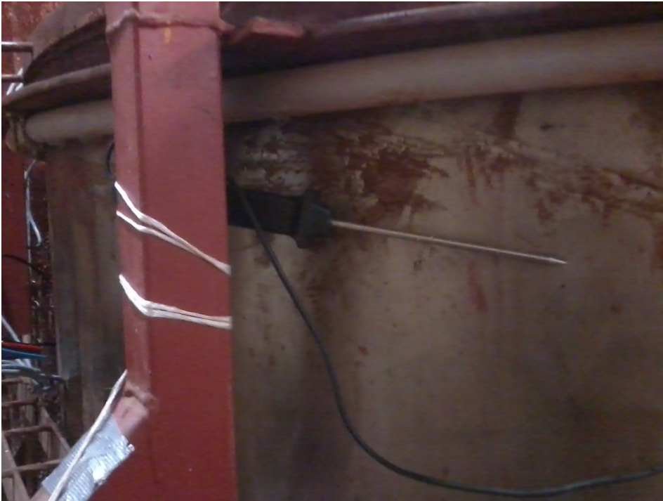
Kuva 6: Jäähdytysveden lämpötilamittaus, yläosa
