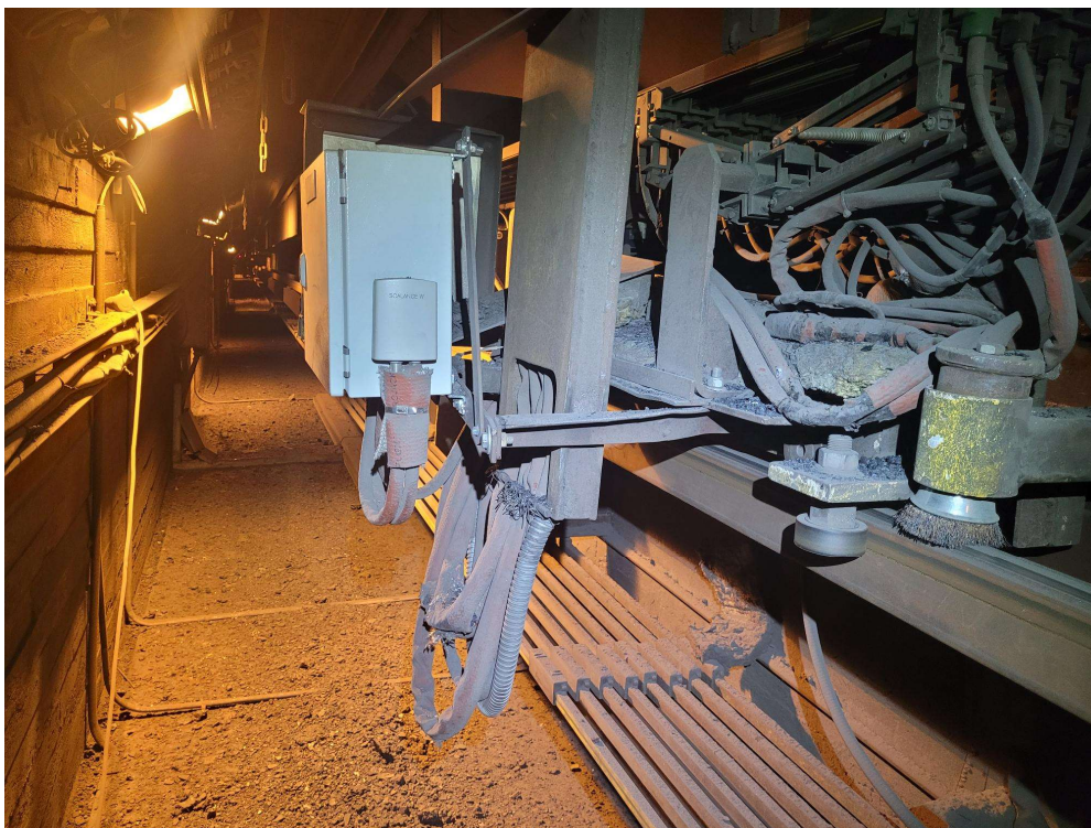
KUVA 21. Virranottovaunussa kiinni oleva Client-kotelo sekä Client-antenni
