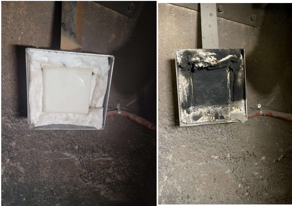
KUVA 20. Antennin suojakotelo ennen ja jälkeen konverterin puhkeamista
