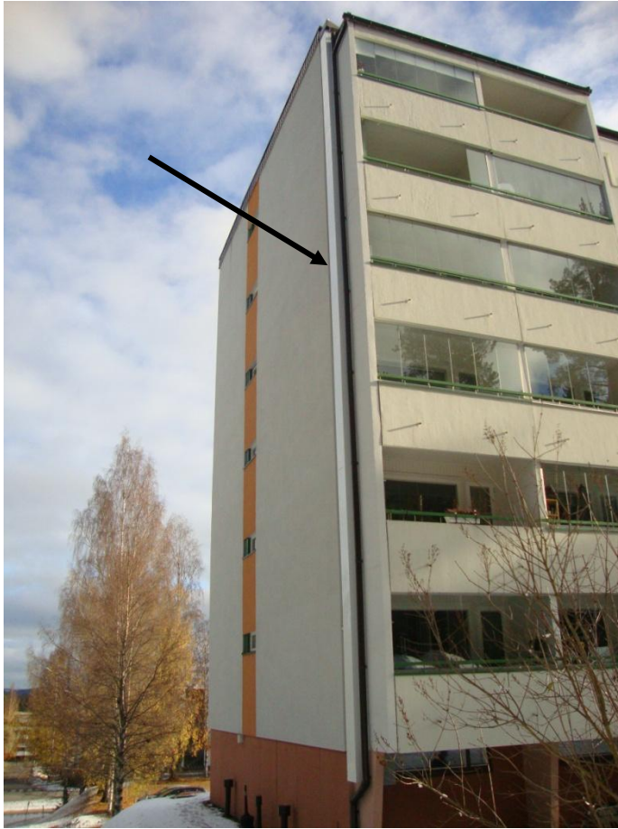
KUVA 7. Vuorikilven lämmönkeruuputkisto valkoisessa kotelossa ulkoseinällä
