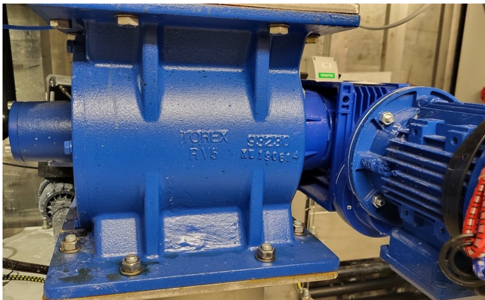
KUVA 14. Mobile EPSE™ -laitteistossa kemikaalisiilon pohjayhteen ja kemikaalisiilon kannen väliin asennettu Rotex sulkusyötin (Kivimäki 2022, CC BY-SA)
