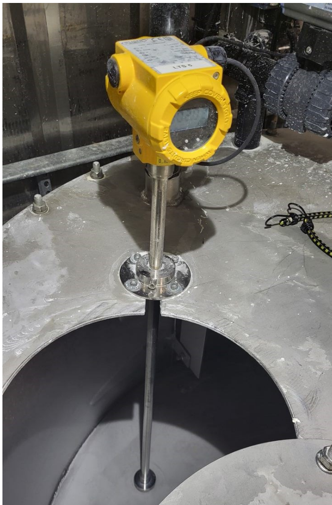
KUVA 9. Säiliön päälle asennettava Aplisens tyyppin APC-2000ALW/P painelähetin (Kivimäki 2022, CC BY-SA)
