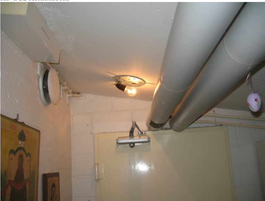
Kuva S3. Valaisimesta puuttuu kupu.
