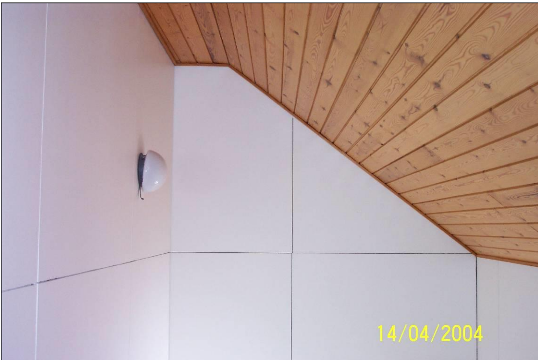
Kuva R3/7. Kesävierasmajan seinien lastulevyt sisältävät formaldehydiä. Seinäverhousten uusimisen yhteydessä joudutaan purkamaan osittain myös kattopanelointeja.
