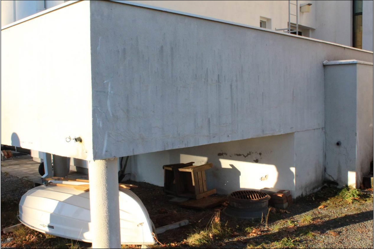
Kuva R1/1. Terrassin pintamateriaali on huonokuntoinen. Rappaus lohkeilee terrassin alapuolella.
