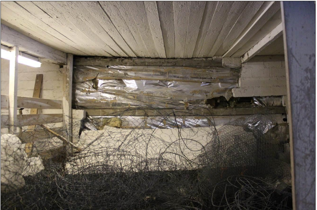
Kuva R5/2. Harkkoseinä kaatunut.
