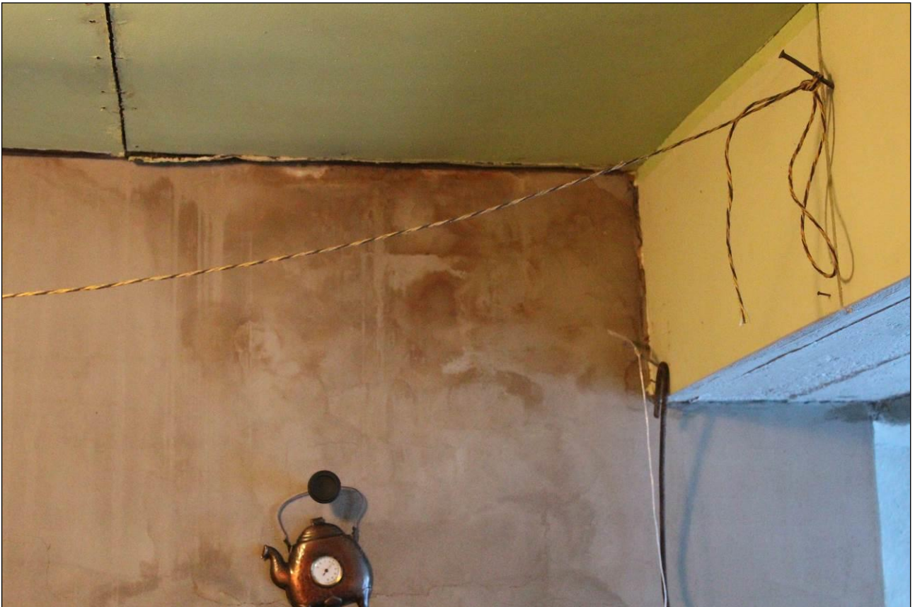
Kuva R5/5. Sisällä olevassa karjakeittiössä on kosteusvauriojälkiä seinissä.
