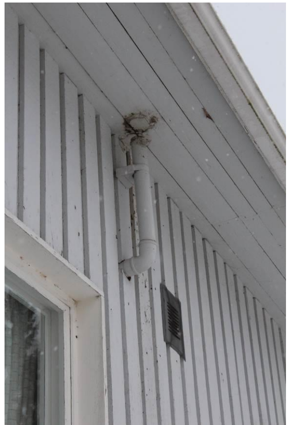
Kuva R4/7. Tuuletusputken päästä puuttuu hattu.
