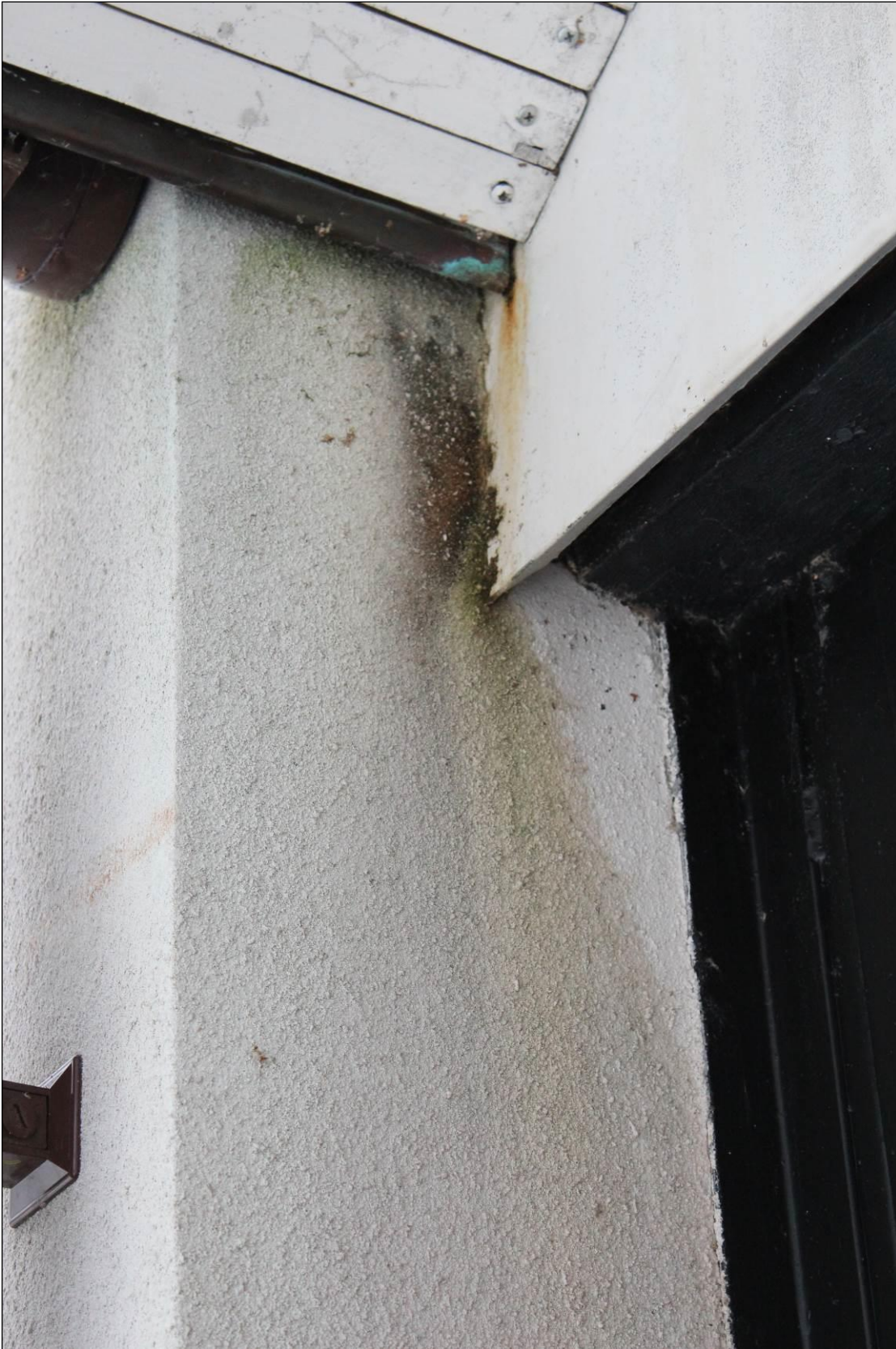
Kuva R1/8. Ruostejälkiä molemmin puolin pääovea.
