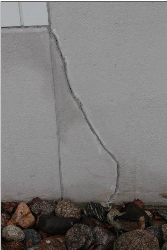
Kuva R2/3. Sokkelissa on halkeama.
