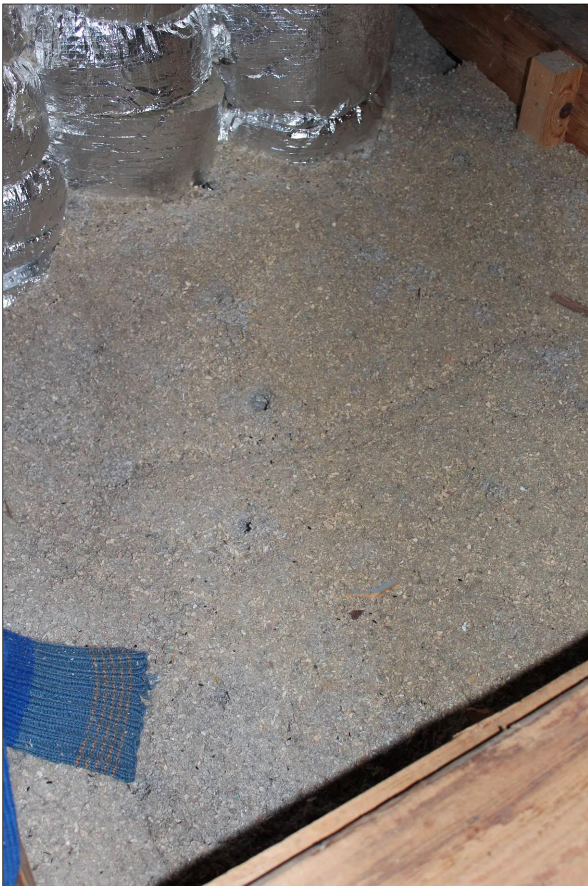
Kuva R6/7. Ullakkotilan eristeessä on hiirten tekemiä onkaloita.
