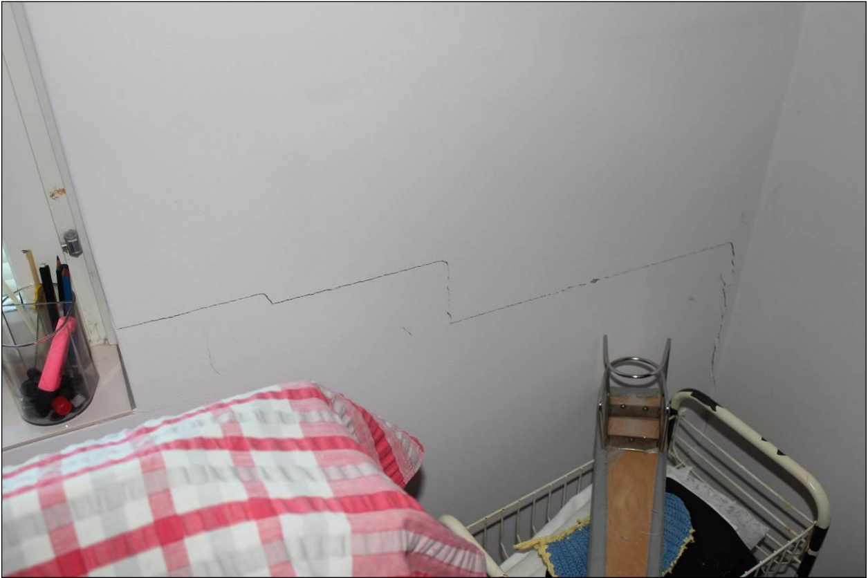
Kuva R1/9. Joissakin koljissa seinät halkeilleet.
