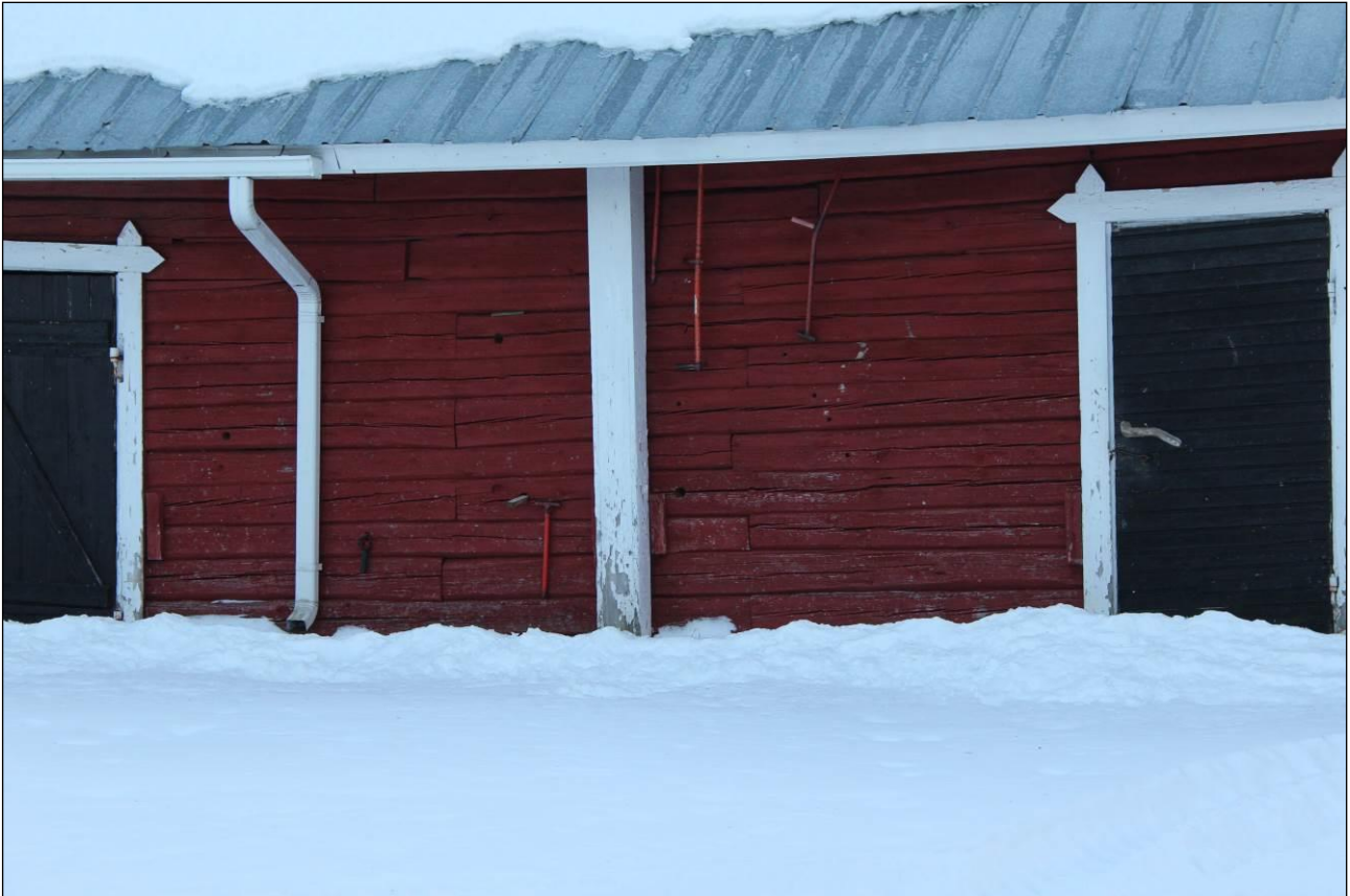
Kuva R5/6. Maalipinnat ovat huonossa kunnossa.
