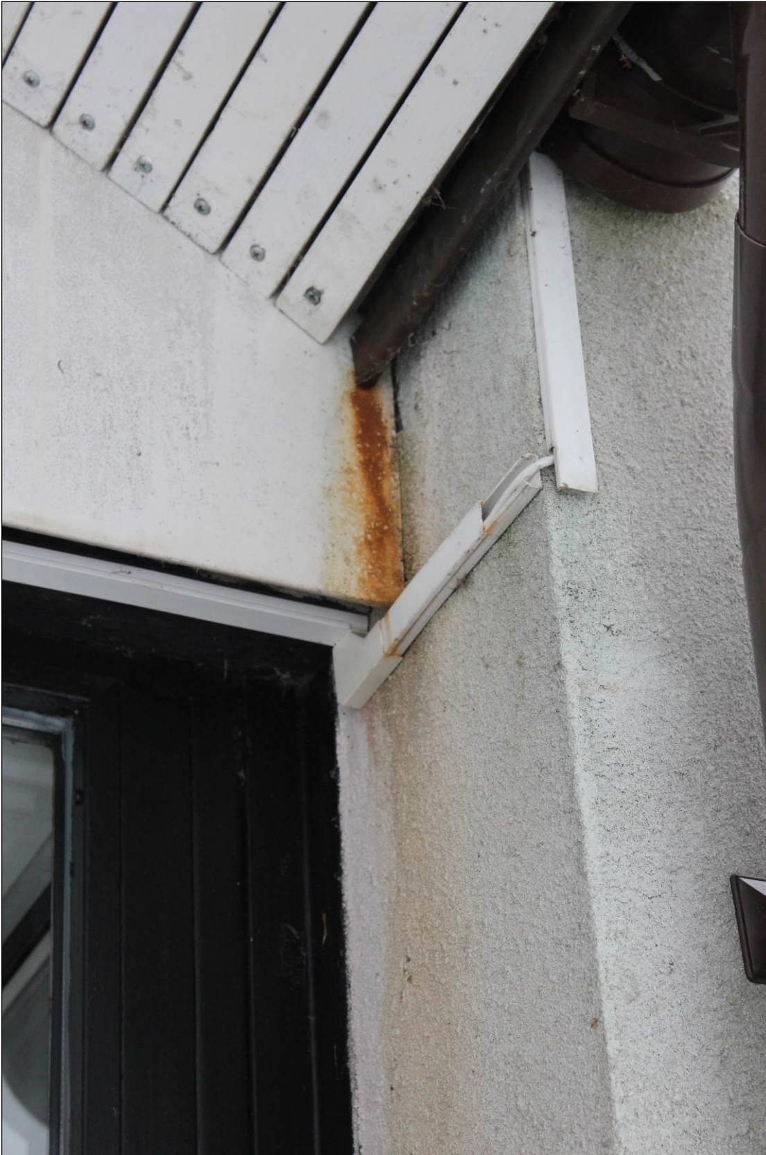
Kuva R1/7. Ruostejälkiä.
