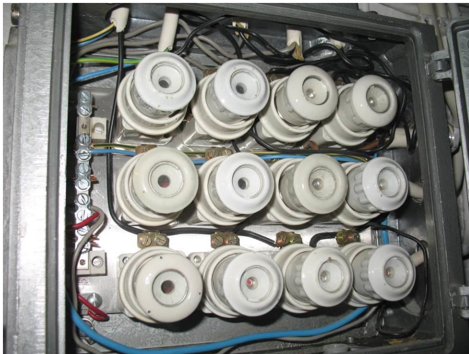
Kuva S1, Keskus RK4 kosketussuojaus puuttuu.
