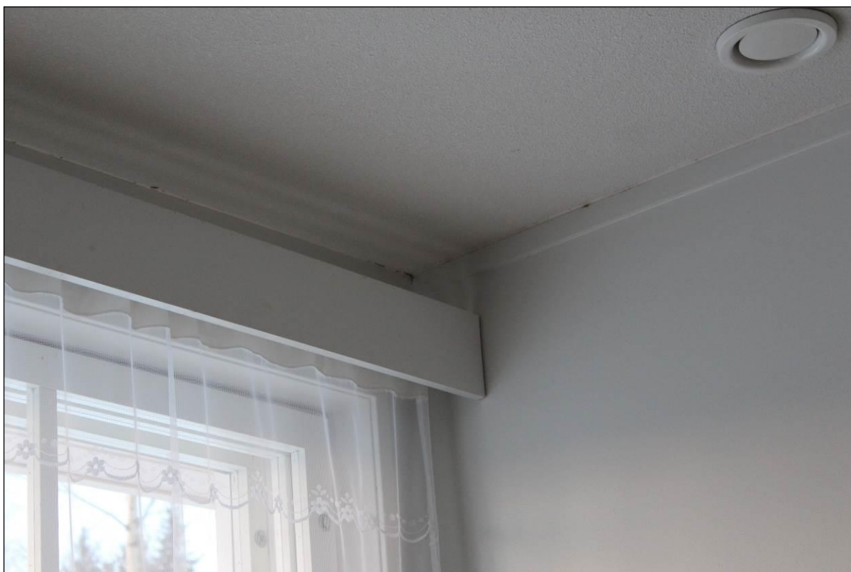
Kuva R2/5. Seinän ja katon rajapinnassa, sekä nurkassa näkyy vauriojälkiä.
