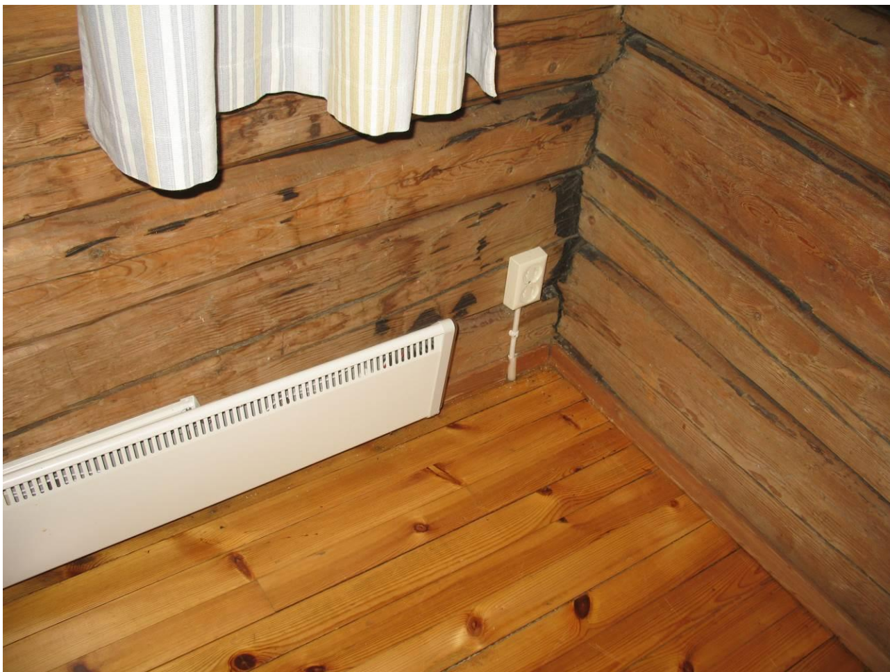
Kuva S3 Sähkölämmitin ja maadoittamaton pistorasia.
