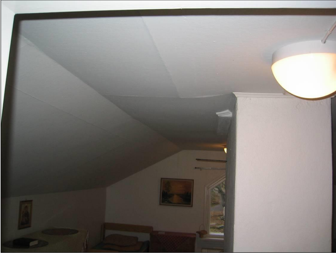
Kuva R4/1. Talkkoolaisten talon ylempi kerros on kesäkäytössä. Yläpohjan puukuitulevytyks on paikoin taipuillut.
