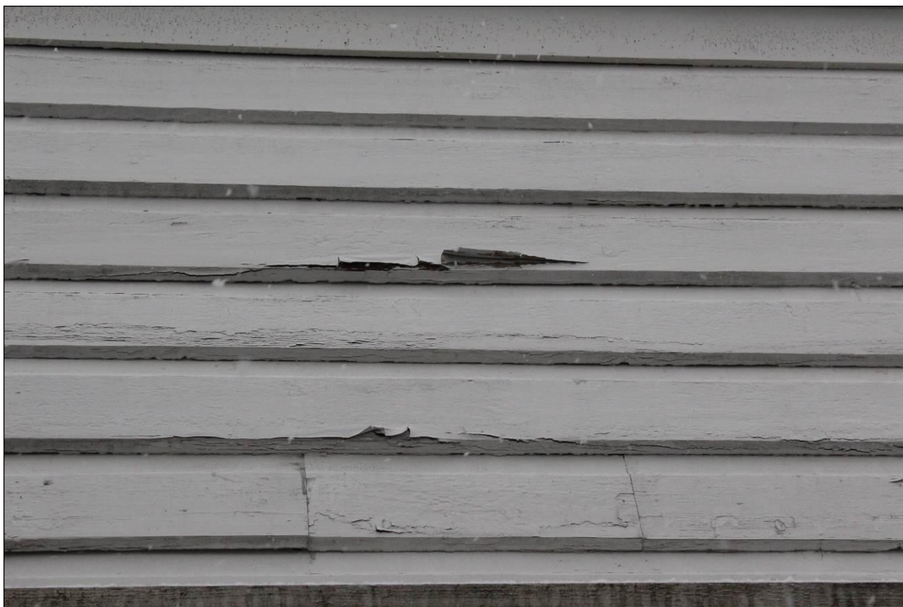
Kuva R6/6. Rakennuksen ulkopuolen maalipinta on huonokuntoinen.
