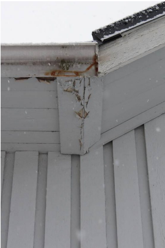
Kuva R4/6. Rästaskourun pääty vuotaa.
