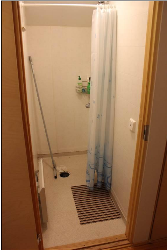
Kuva R3/8. Sosiaalitilojen kunto muuten hyvä, paitsi lattia- ja seinäpinnoitteen rajakohta vaikuttaa epätiiviltä ja siihen on tullut värjäjäkiä.
