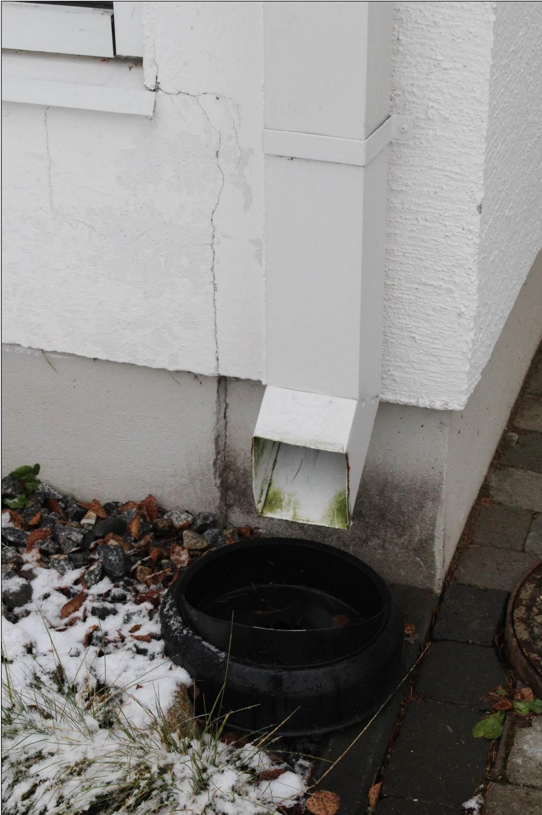
Kuva R1/5. Tummumista sokkelin pinnassa sekä halkeama rappauksessa.
