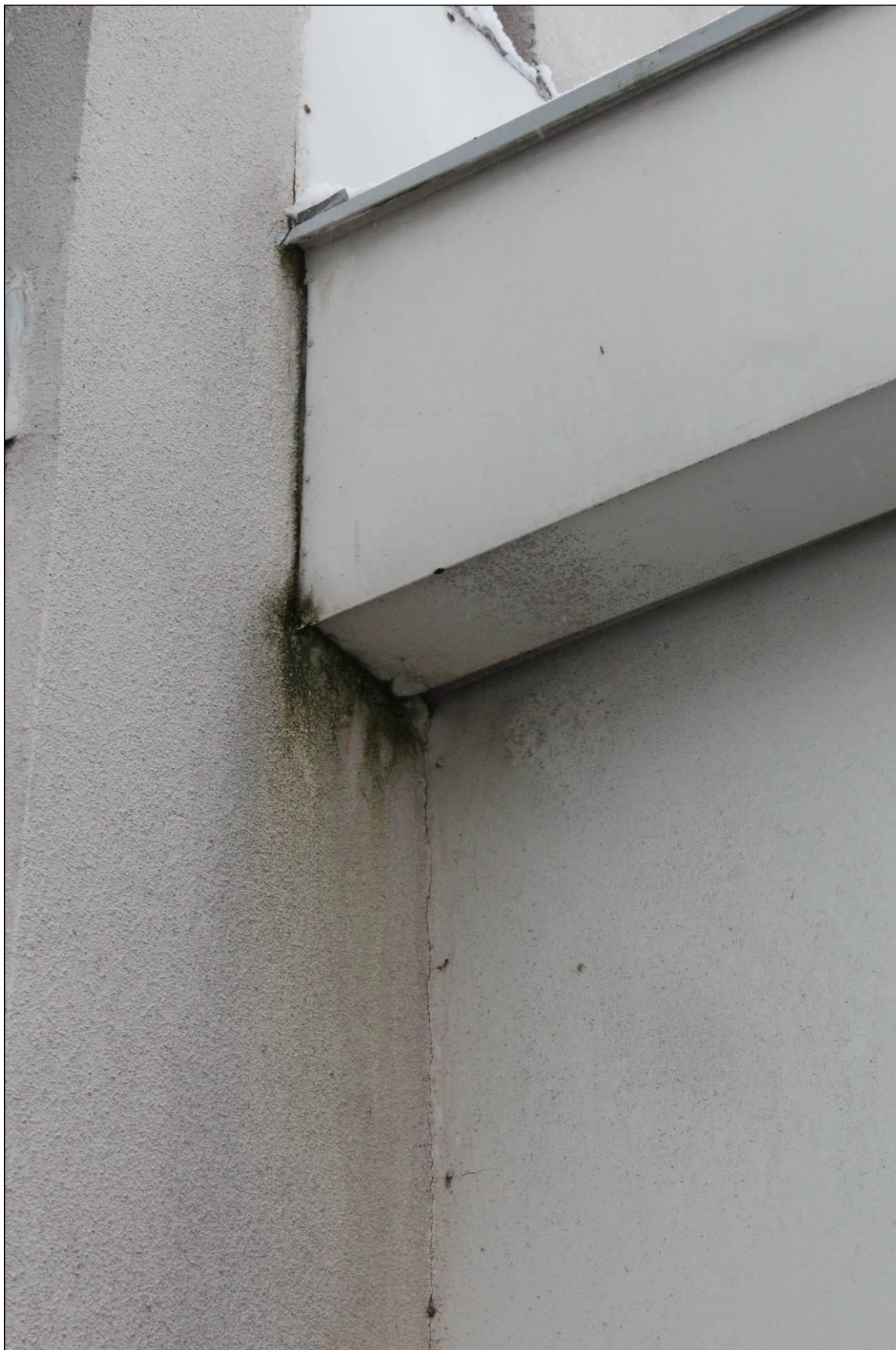
Kuva R1/6. Värjälkiä rappauksen pinnassa.
