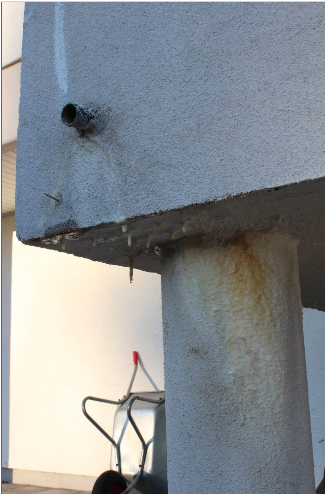
Kuva R1/3. Terassin vedenpoisto putki aiheuttaa kalkkeutumista rakenteisiin.
