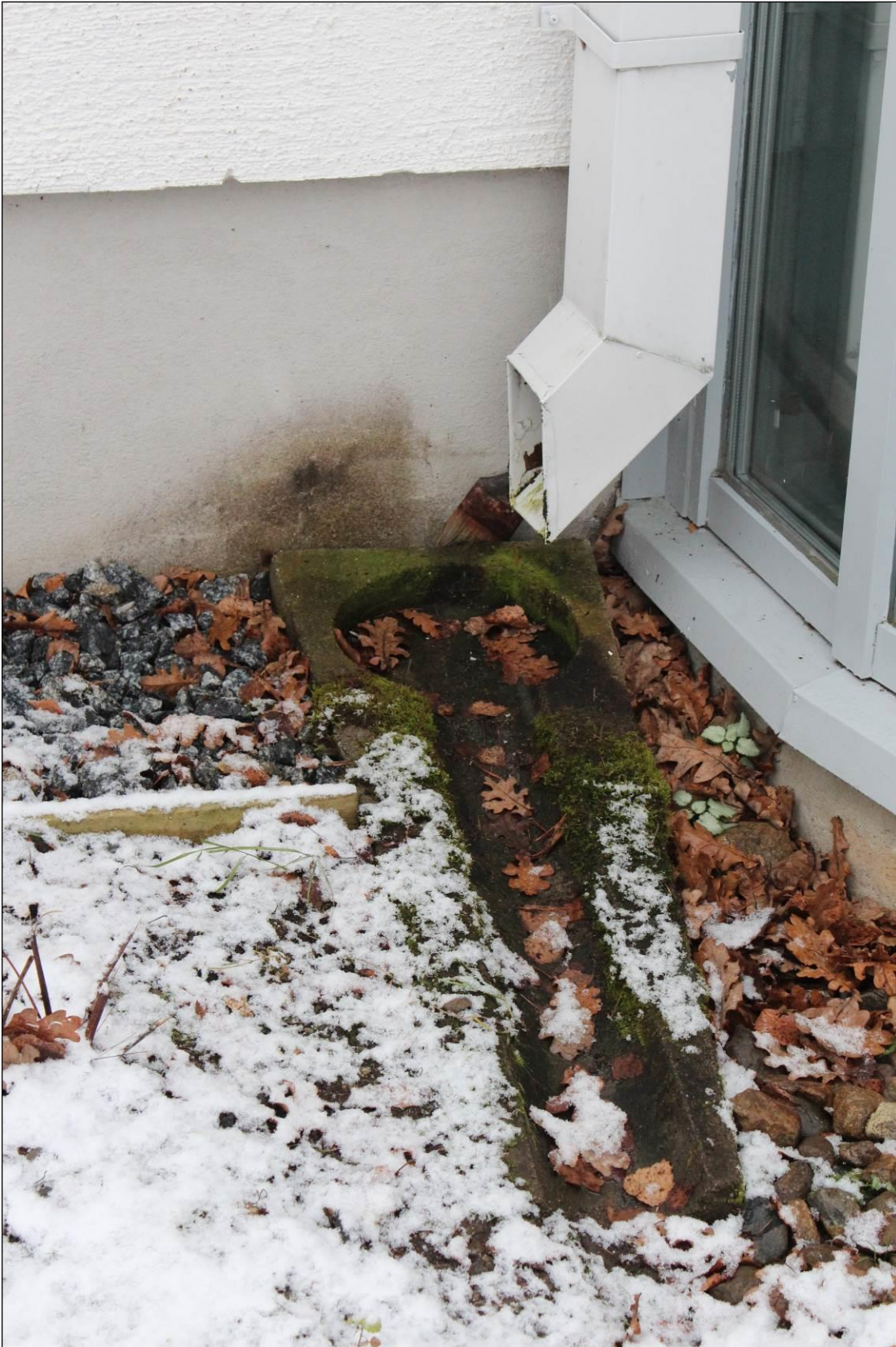
Kuva R1/4. Syöksyputkesta tuleva vesi pääsee roiskumaan sokkelin pintaan.
