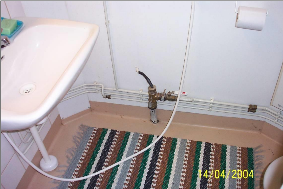
Kuva R4/3. Talkoolaisten talon wc:stä puuttuu lattiakaivo
