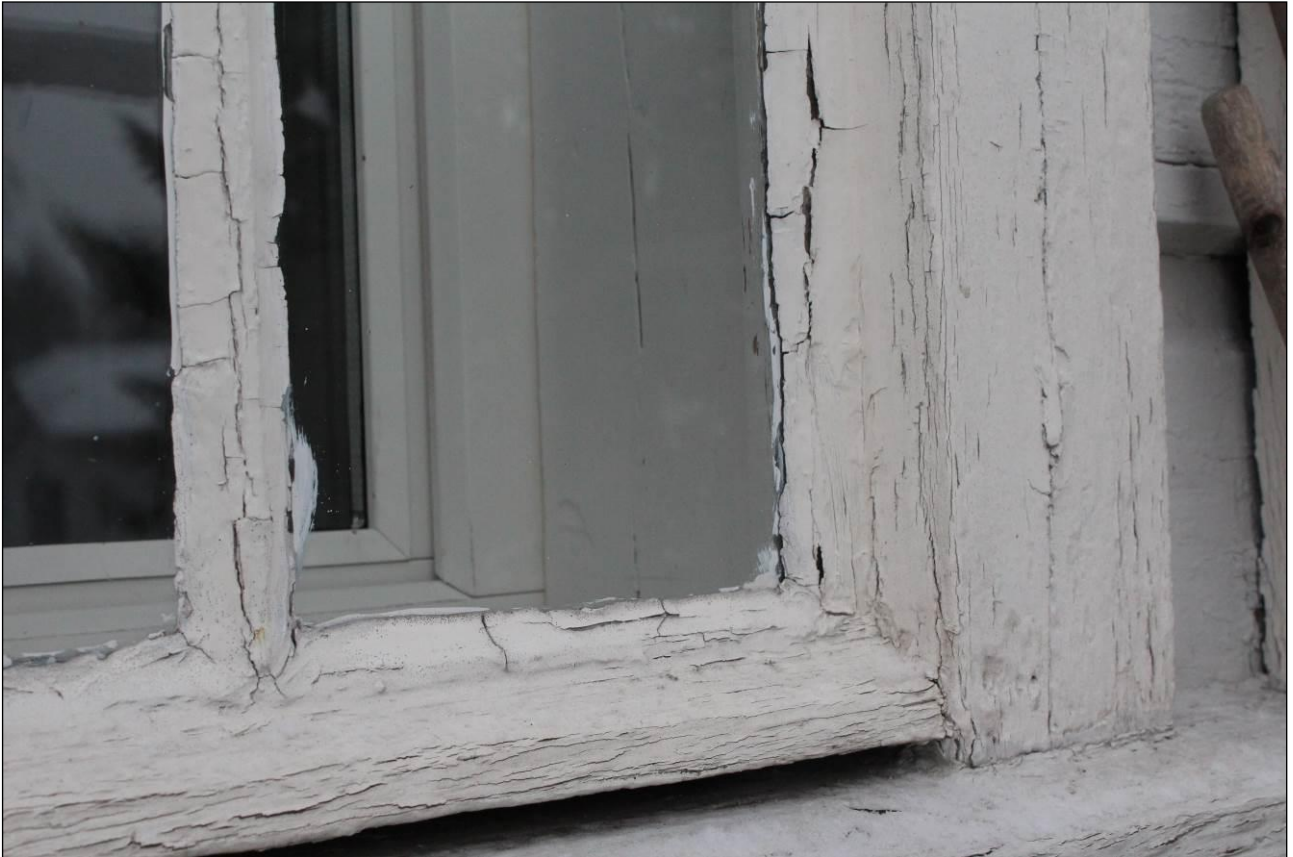
Kuva R6/3. Ikkunoiden maalipinta huonokuntoinen myös ulkoa.
