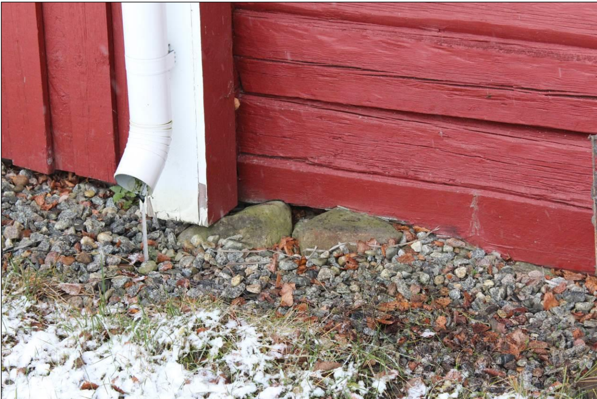
Kuva R3/5. Sadevesiä ei ole viemäroity. Alin hirsi makaa lähestulkoon maanpäällä.
