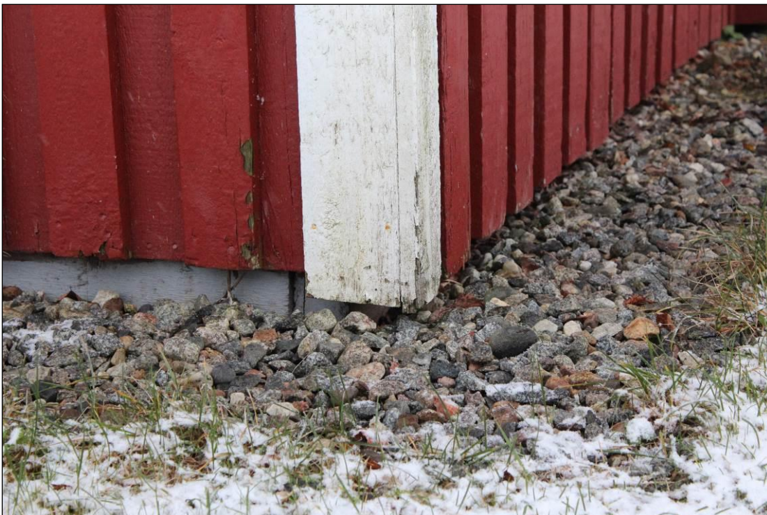
Kuva R3/3. Sokkelien vierustalle on asennettu sepeliä, mutta seinille roiskuu silti vettä, joka vaurioittaa pintaverhousa.
