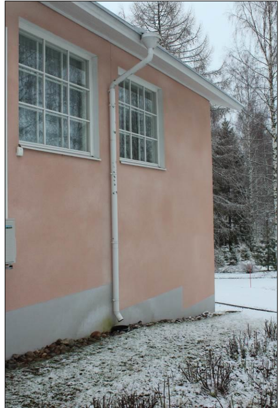
Kuva R2/2. Syöksytorven maalipinta huono.
