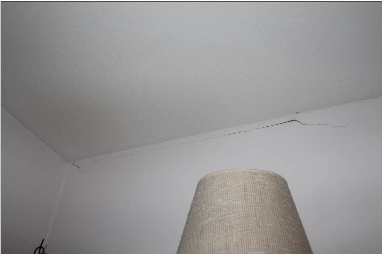
Kuva R1/10 Koljissa on myös halkeilua katon ja seinän rajassa, sekä kynttilöiden poltosta aiheutunutta tummumista katossa.
