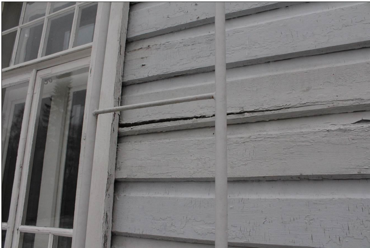
Kuva R6/5. Osa ulkopuolen paneeleista on haljenneita.
