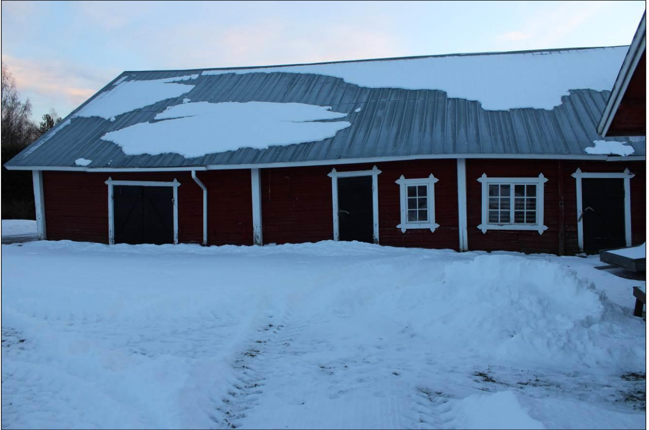
Kuva R5/4. Rästäävät ovat aalloilla koska kantavat ulkoseinät ovat painuneet epätasaisesti.
