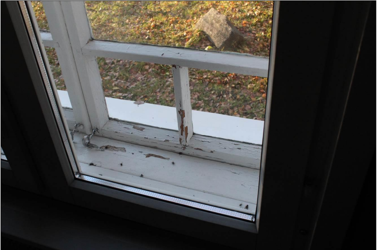
Kuva R6/1. Ikkunoiden maali on huonokuntoinen sisältä.
