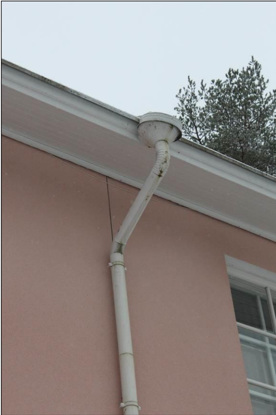
Kuva R2/1. Syöksytorven vauriot.
