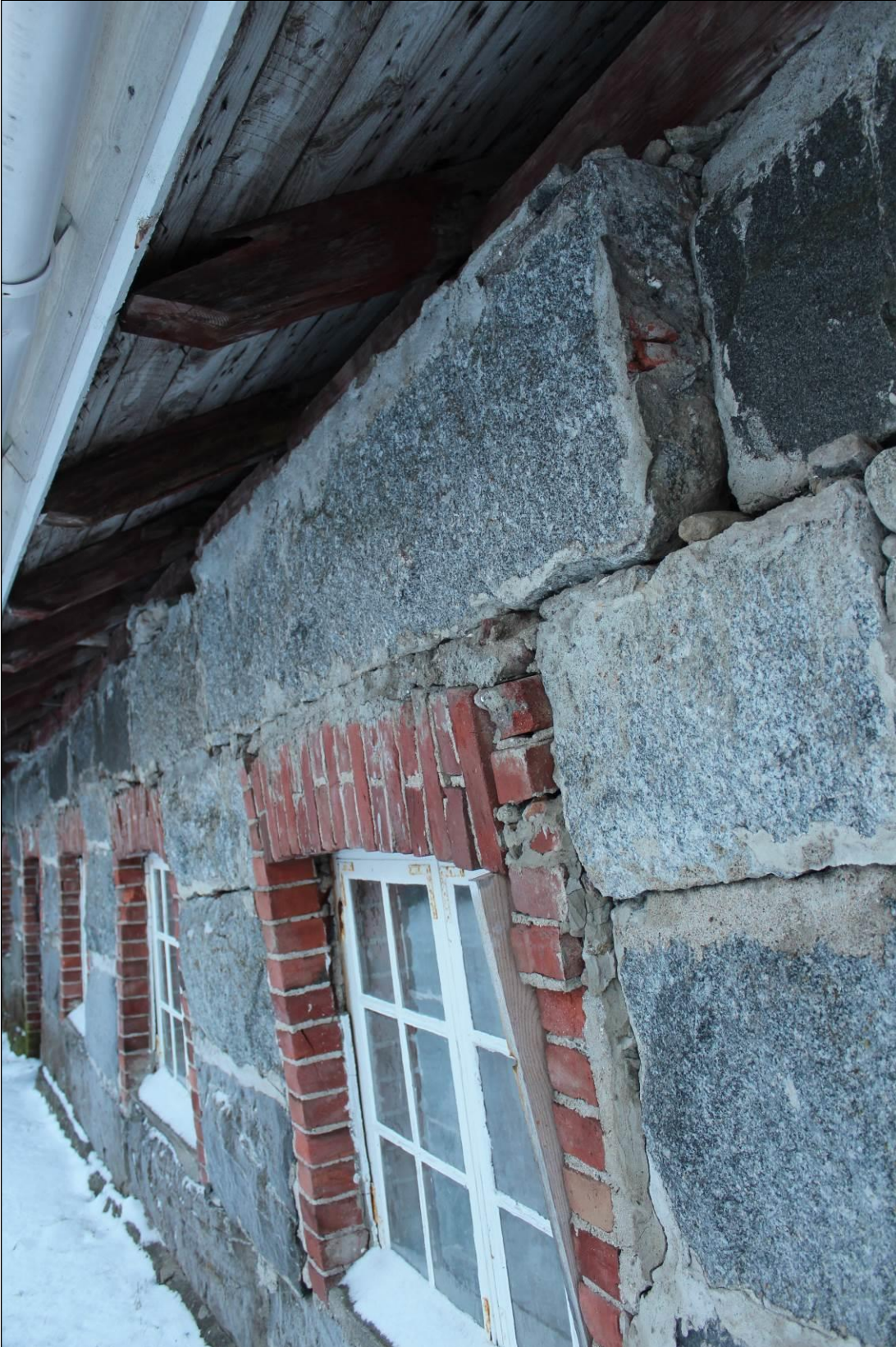
Kuva R5/3. Kiviseinä on paikoin kallellaan ja sauma-ainekset on murentuneet pois.
