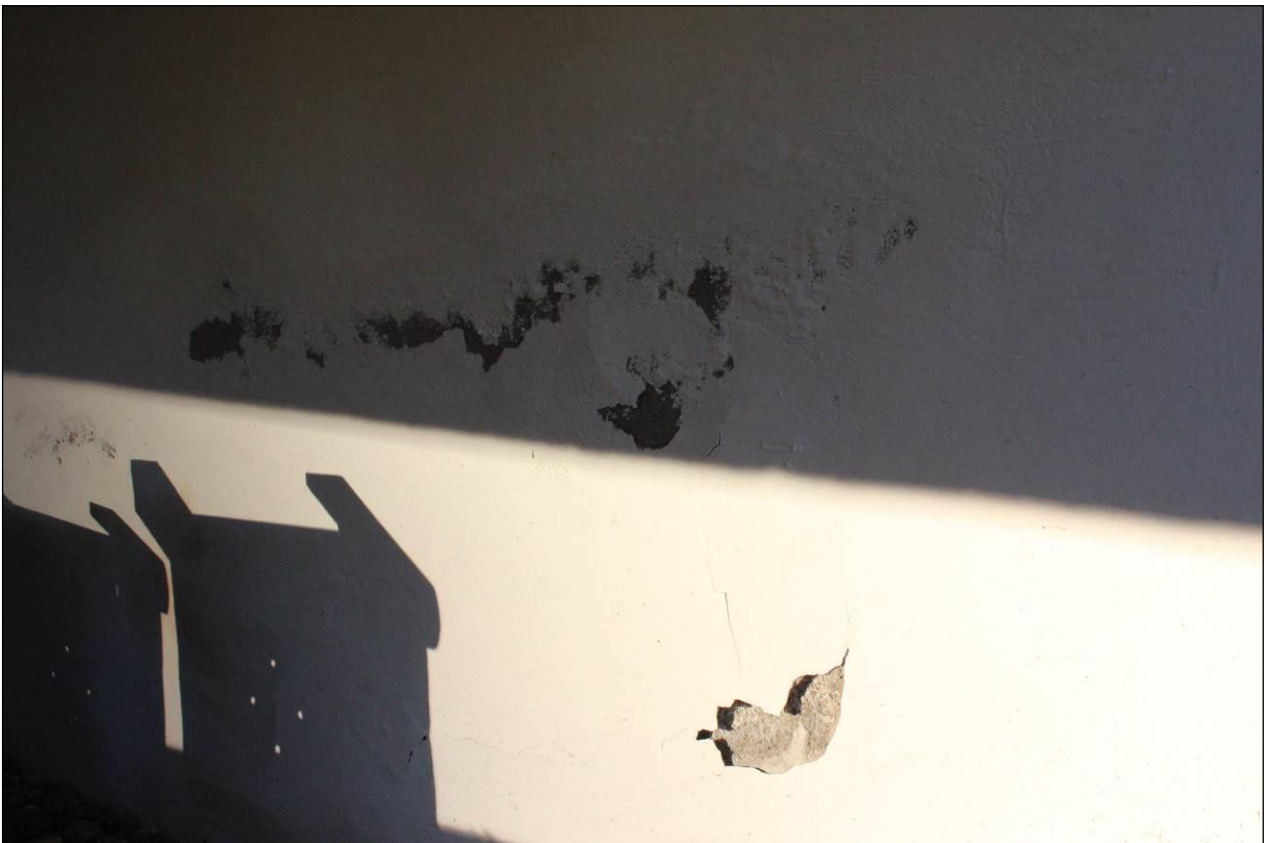
Kuva R1/2. Terrassin alapuolella vaurioita rappauksessa.
