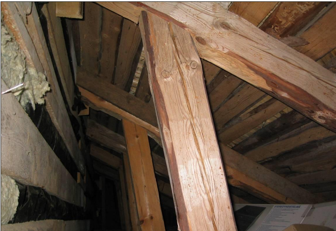
Kuva R4/4. Sivu-ullakolta on nähtävissä vesikatteen rakennetta ja kuntoa. Vuotoja ei ole tällä sivulla ollut.
