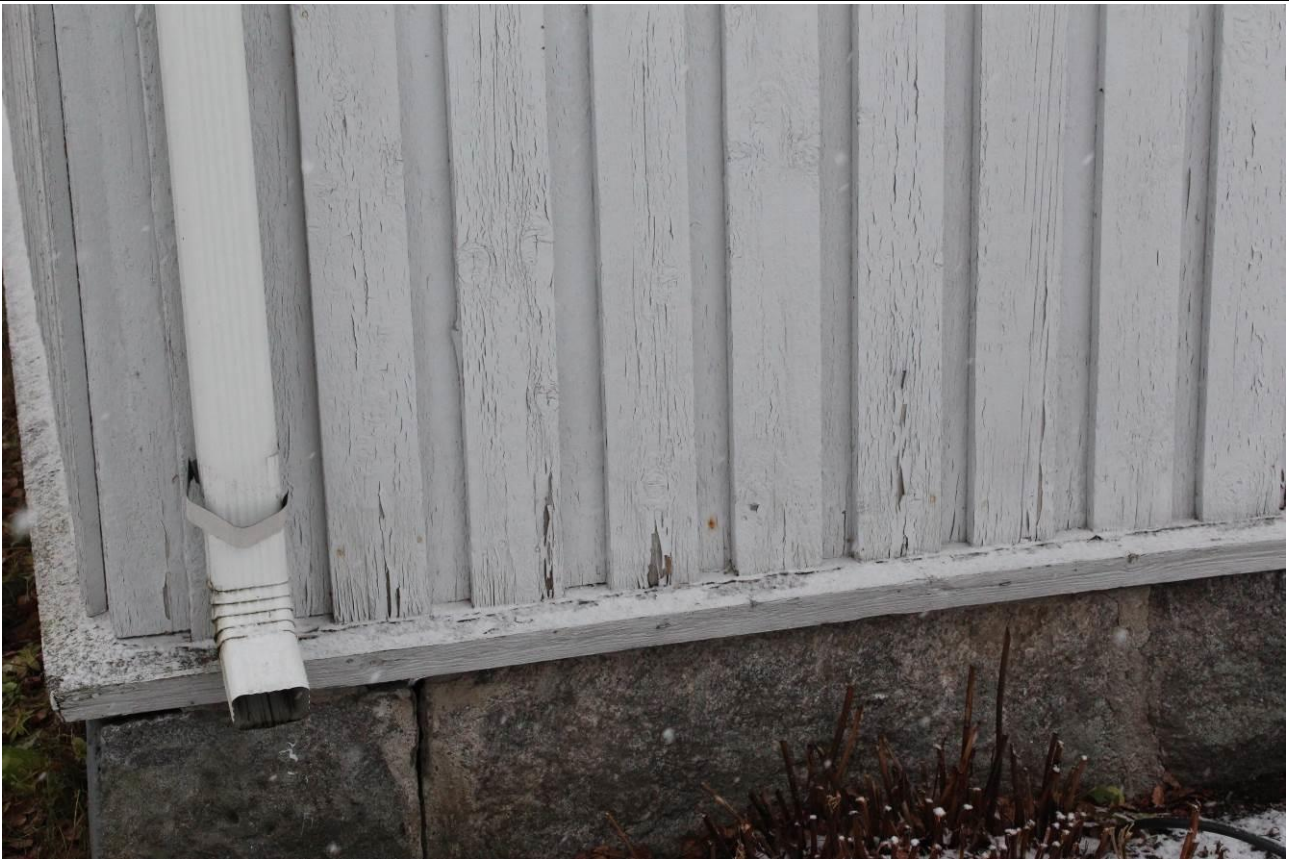
Kuva R4/5. Rakennuksen ulkoverhouksen maalipinta on huonokuntoinen. Syöksytorven kiinnike on auennut.
