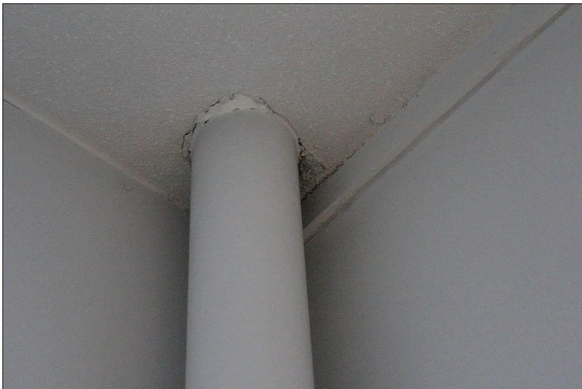
Kuva R2/6. WC-tilassa olevan viemärintuuletusputken ja katon liitos on epätiivis.
