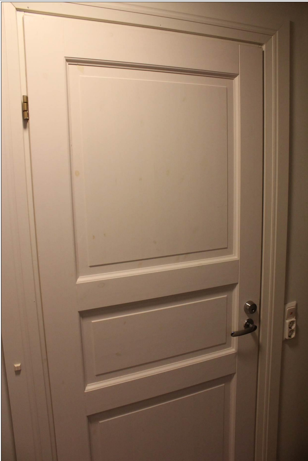
Kuva R6/8. Väliovissa oksankohdat kuultavat maalin läpi.
