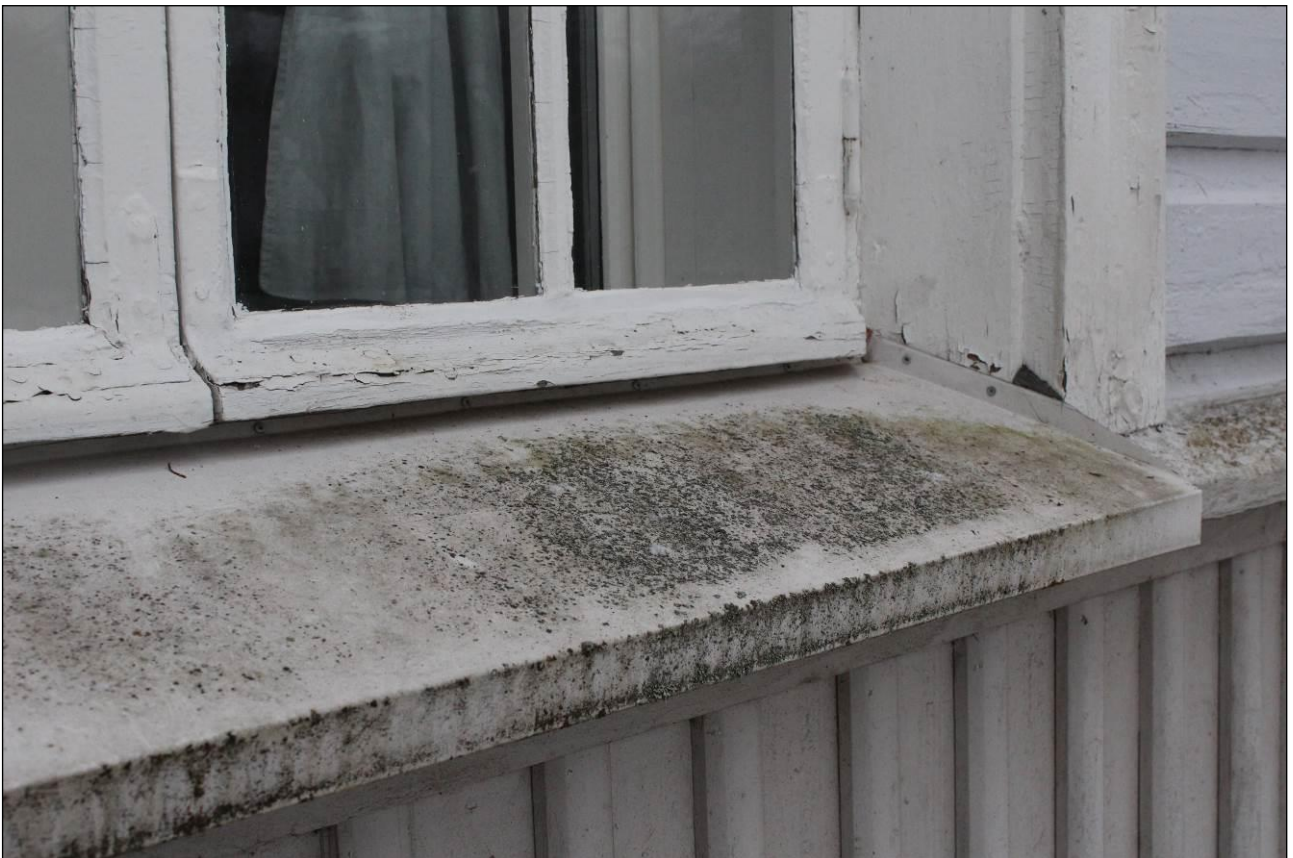
Kuva R6/4. Ikkunapellit tummuneet orgaanisesta kasvustosta.
