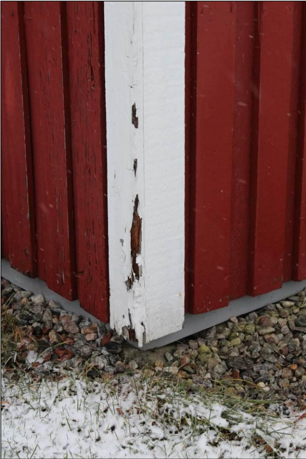
Kuva R3/1. Nurkkalaudat lahonneet ja maalipinta kärsinyt.
