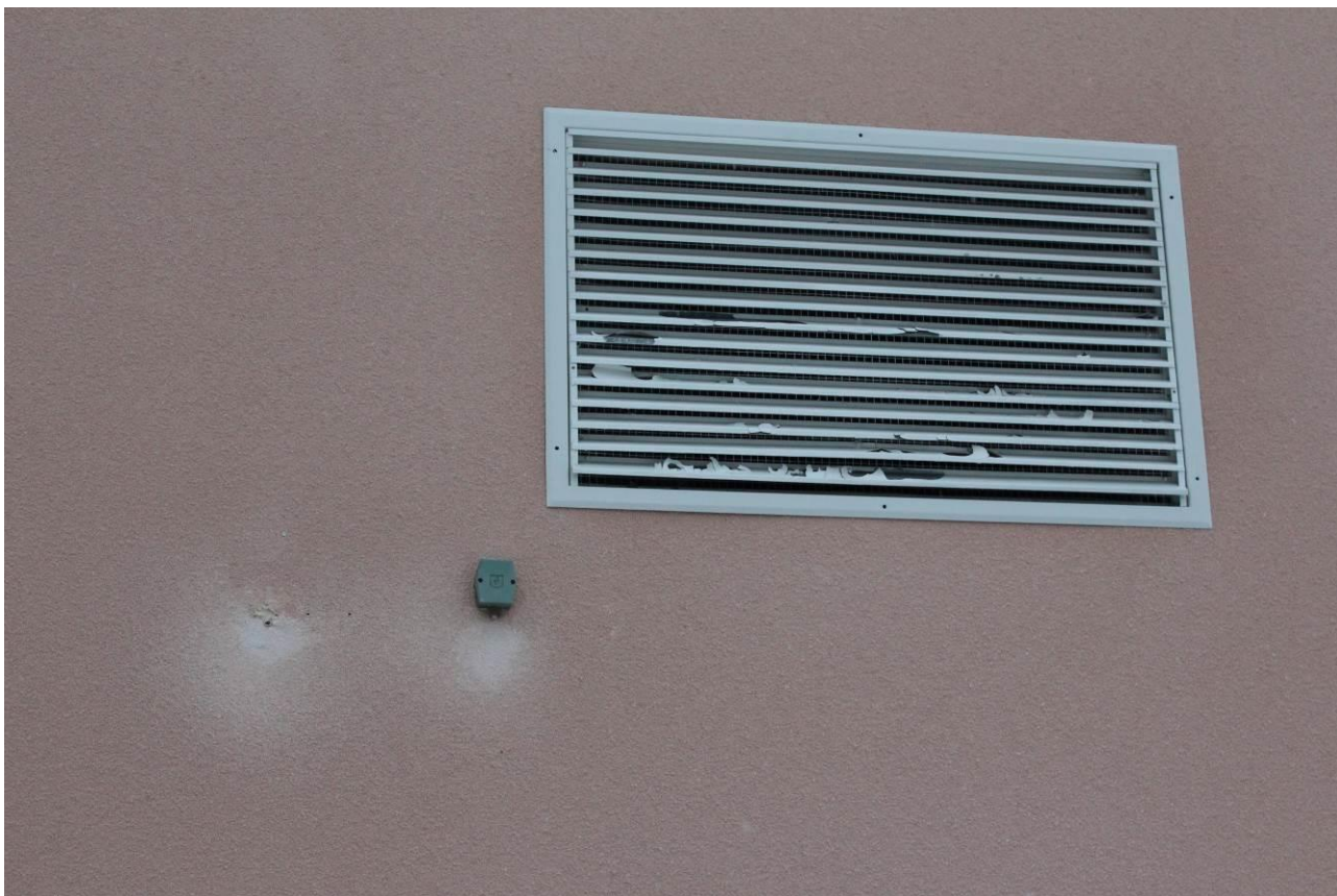
Kuva R2/7. IV-hormin suojaritilän maalipinta hilseilee.
