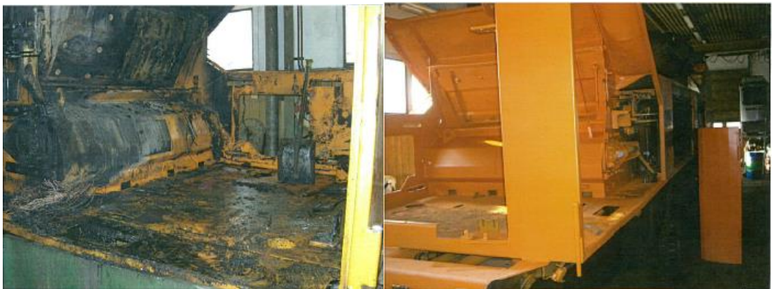
Kuva 4. Moottoritila ennen huoltoa vasemmalla, sekä huollon jälkeen oikealla. (Pohjaset Oy, palovahinkoraportti pdf, 20.5.2012)
