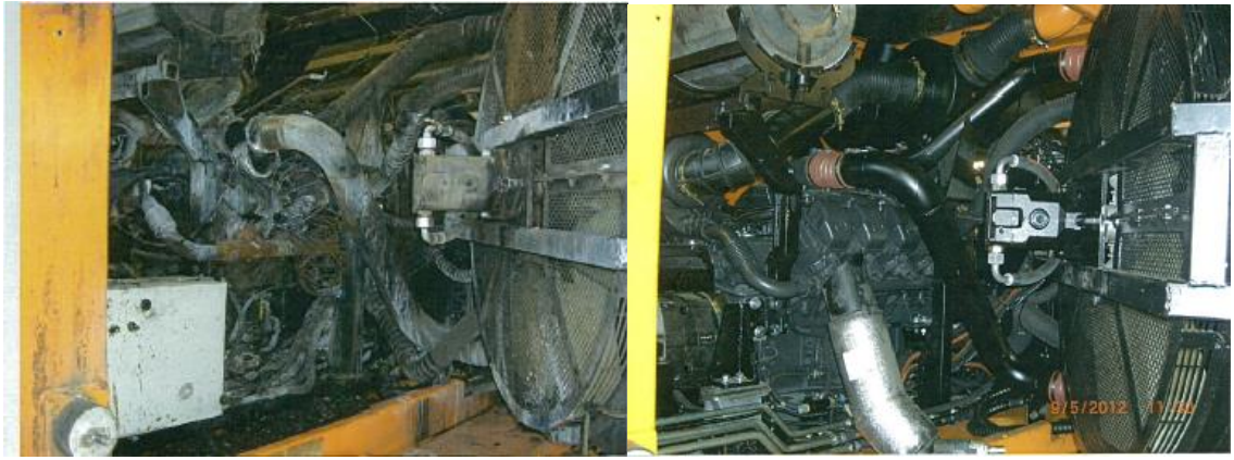
Kuva 5. Moottoritila takaapäin. Ennen huoltoa(vasemmalla), sekä huollon jälkeen(oikealla). (Pohjaset Oy, palovahinkoraportti pdf, 20.5.2012)
