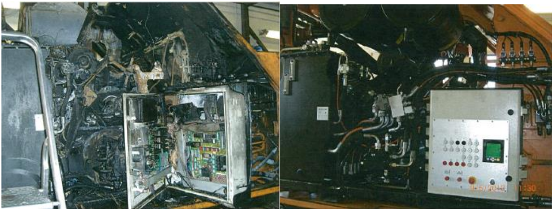
Kuva 6. Moottoritalan sähkökeskus ennen huoltoa(vasemmalla), sekä huollon jälkeen(oikealla). (Pohjaset Oy, palovahinkoraportti pdf, 20.5.2012)
