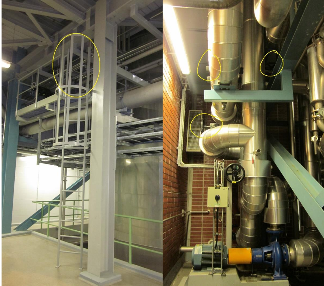
Kuvio 7. Esimerkkejä puutteellisesta luokse päästävyydestä ja turvallisuudesta. Kohdat merkitty keltaisella.
