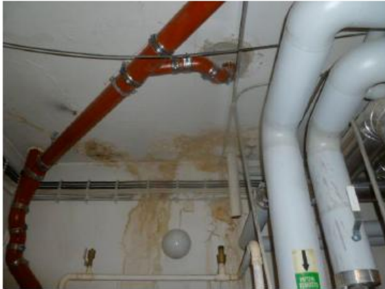
Vuotopaikan alapuolella pannuhuoneessa vuotoveden kastelemia rakenteita.
