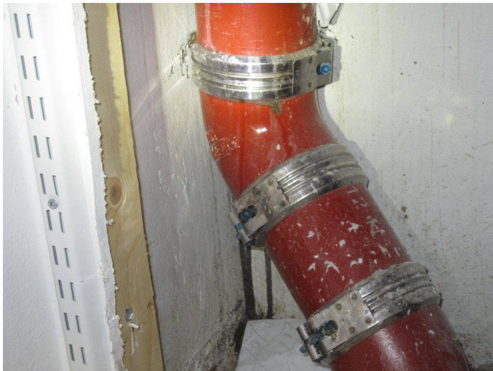
Kuvio 2. Vuotanut viemäriputki
