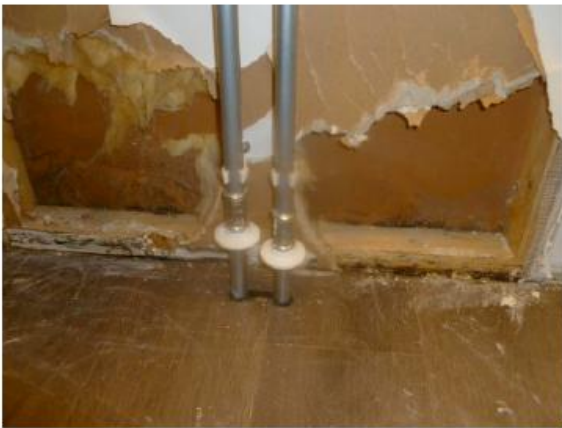
Varaston ja naisten vessan väliseinä kastunut. Seinärakenteessa mustumista.
