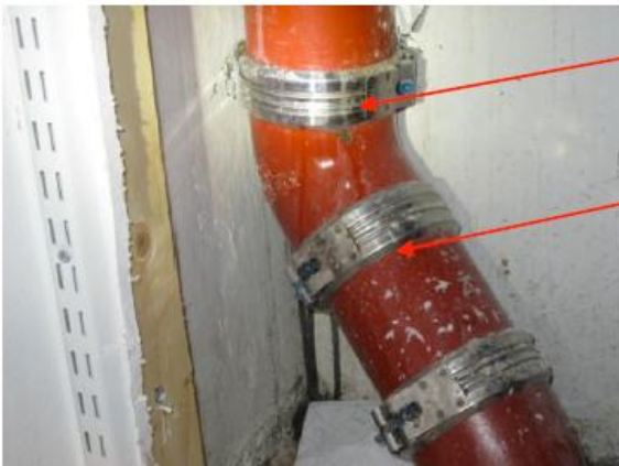
YIT:n työntekijöiden kertoman mukaan viemärin pantaliitoksesta tippassut vettä kun yläkerran vessanpönttö vedetty.
