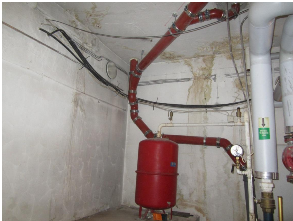
Kuvio 4. Teknisen tilan vaurioituneet katto- ja seinärakenteet
