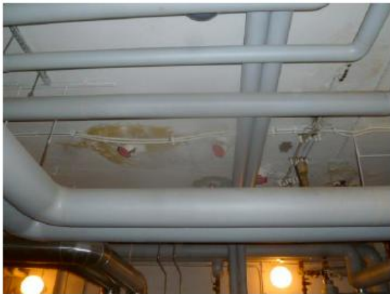
Pannuhuoneessa vanhojen läpivientien kohdilla vuotoveden aiheuttamia jälkiä. Kohdat yläpuolella olevien vessojen kohdilla.
