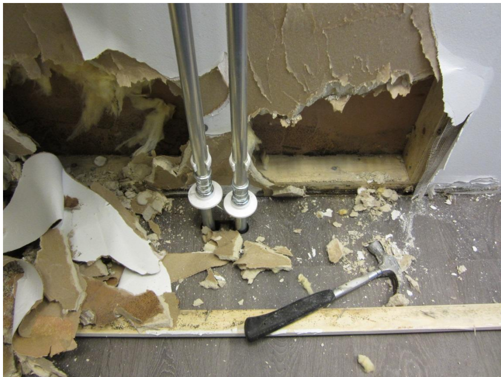
Kuvio 3. Kuiva-ainevaraston vaurioituneita rakenteita
