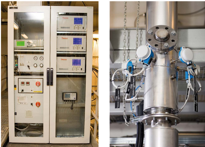
Kuva 1. Savukaasuanalysointilaitteisto ja savukaasumittauksissa tarvittavia antureita/sondeja (Biotalousinstituutti).
