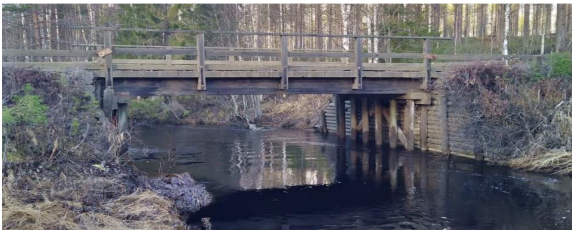
Kuva 3. Liimapuinen palkkisilta (Timo Pisto).
