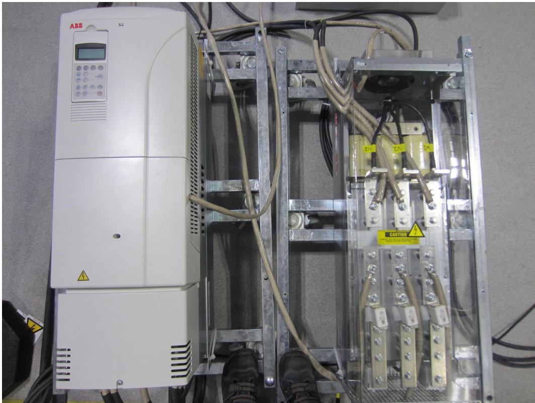
Kuva 7. Saarekekonverteriksi muokattu ACS800-11 sekä sen ulkopuolelle lisätty saarekeverkon puoleinen LCL-suodatin
