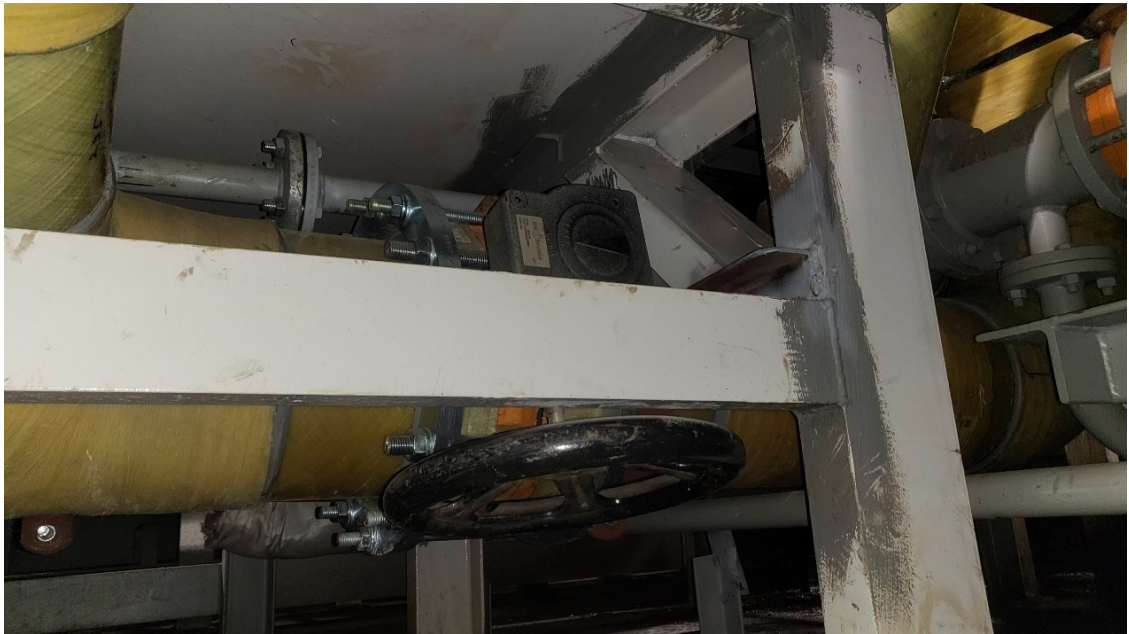
Kuva 4. Jäähdytysvesilinjan sulkuventtiili (Holmberg, 2023).
