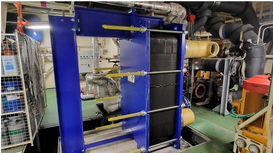
Kuva 2. Kelvion levylämmönvaihdin asennettuna (Holmberg, 2023).
