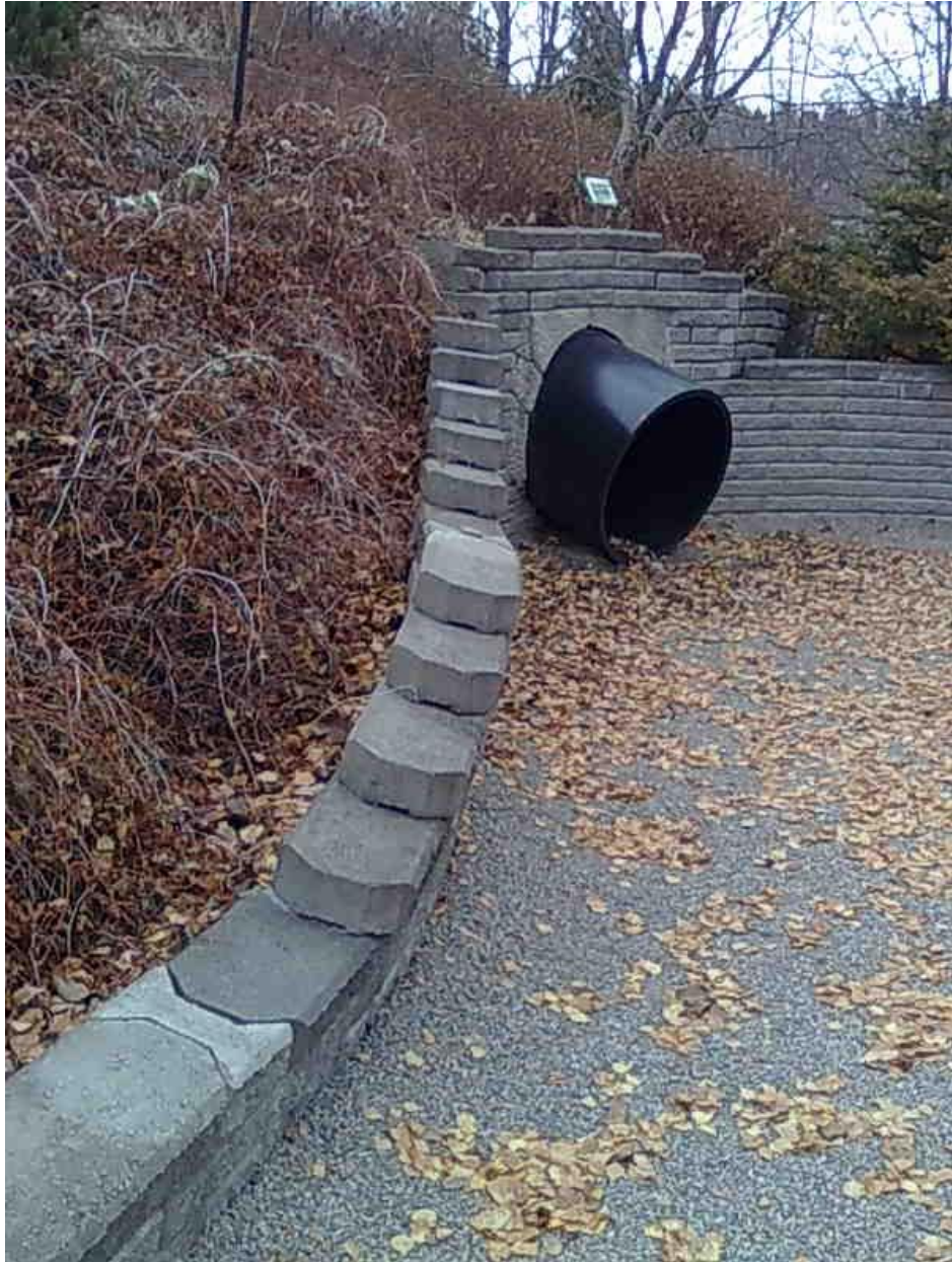
KUVA 23 Kallistunut tukimuuri ennen korjausta (Minna Hiekkola 2010)
