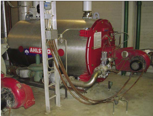
Kuva 12 Lämpökattila Lahdessa, Kariniemen jätevedenpuhdistamolla./10/
