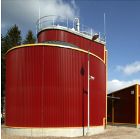
Kuva 6 Biokaasureaktori ja biokaasumoottorirakennus Riihimäen puhdistamolla/15/
