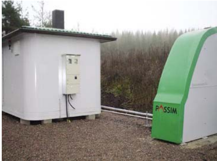
Kuva 11 Mikroturbiinikontti ja soihutupoltin/10/
