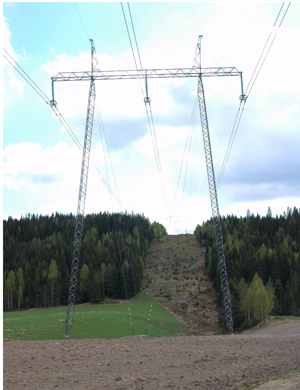
Kuva 6 400 kV harustettu voimajohtopylväs
