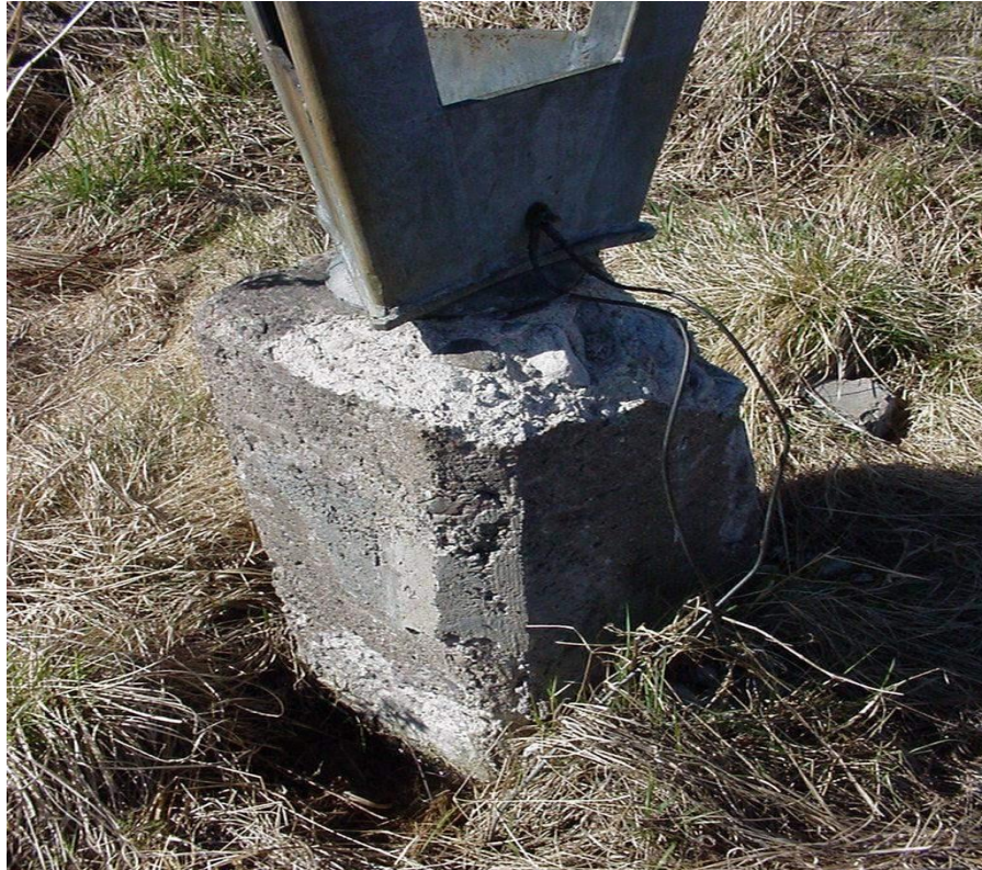
Kuva 7 Esimerkki rapautuneesta pylväsperustuksesta
