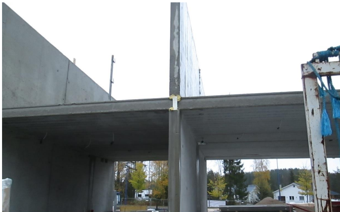
KUVA 9. Kantavat betoniseinät sään armoilla. (Hakkarainen 2015-03-10.)
