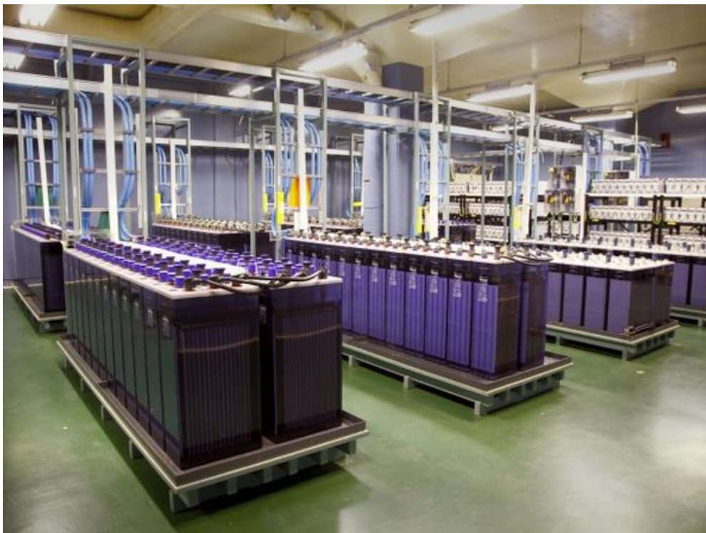
KUVA 2. Varavoima-akusto (Suomen Erillisverkot Oy 2014)
