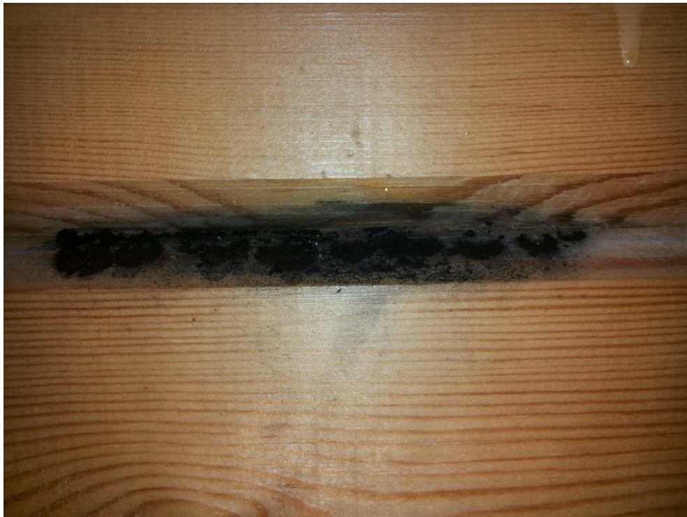
Kuva 20. Kattovuodon seurauksena syntynyttä mikrobikasvustoa hirsirakenteen sisäpinnassa
