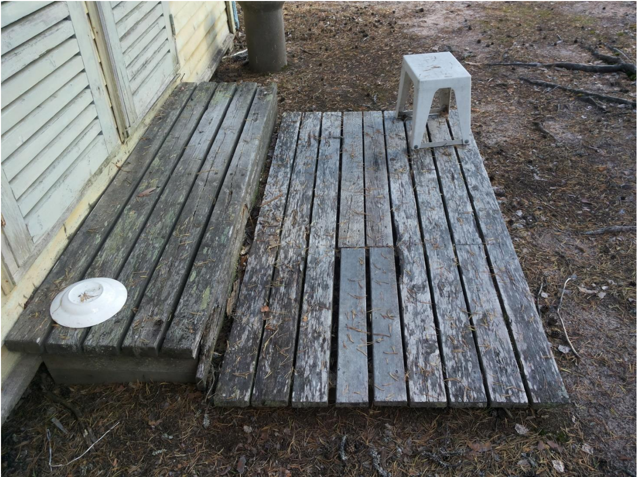
Kuva 5. Portaat ovat lahot ja huonokuntoiset.
