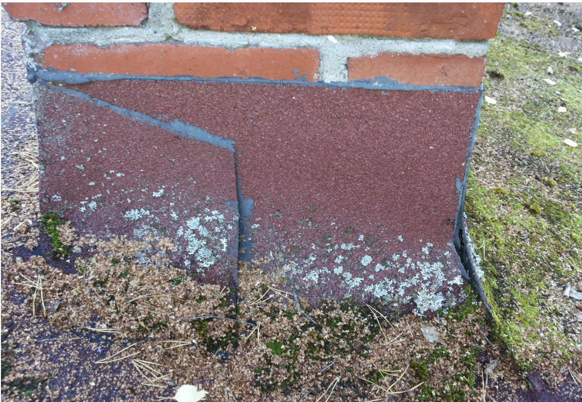
Kuva 7. Huopa on repeillyt piipun juuresta ja katolla kasvaa runsaasti sammalta.
