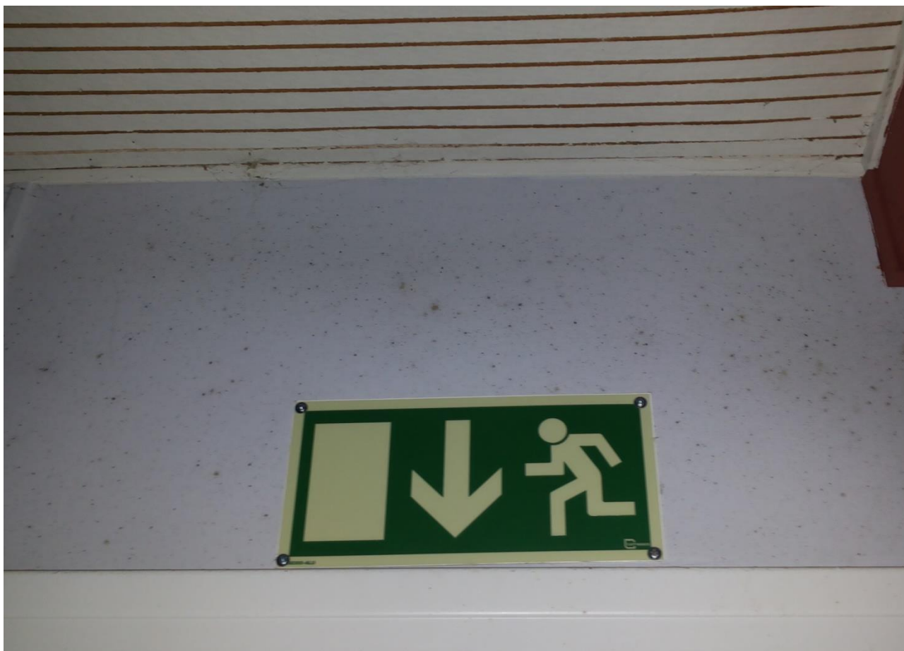
Kuva 10. Ruokasalin seinässä on ylimääräisen kosteuden aiheuttamia mustia pilkkuja.
