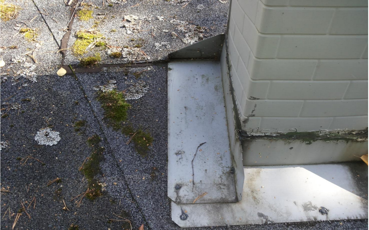
Kuva 4. Piipun pellityksien saumaukset ovat huonokuntoiset.
