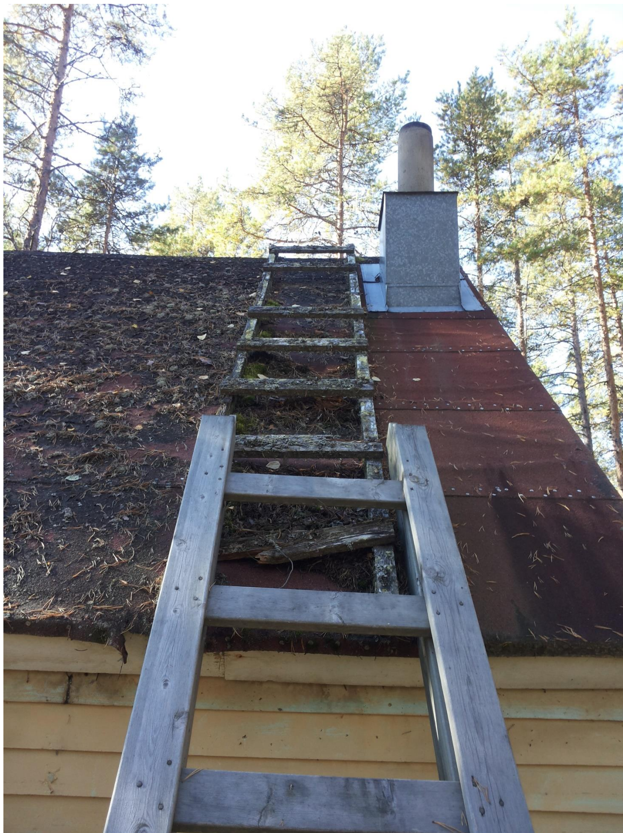
Kuva 10. Lapetikkaat ovat lahot ja huonokuntoiset.
