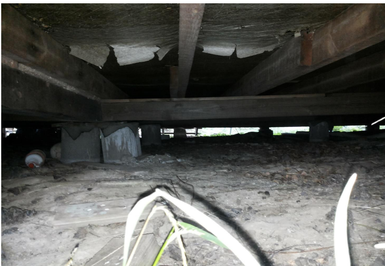
Kuva 3. Alapohjan tuulensuojapaperi on paikoitellen irti.
