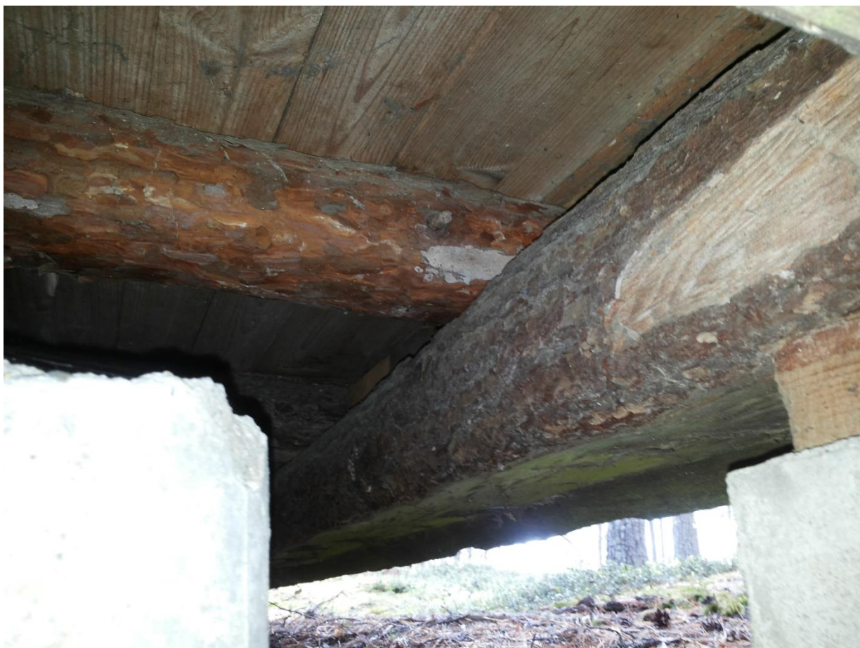
Kuva 2. Kapillaarikatko puuttuu perustuksen ja alapohjarakenteen välistä.
