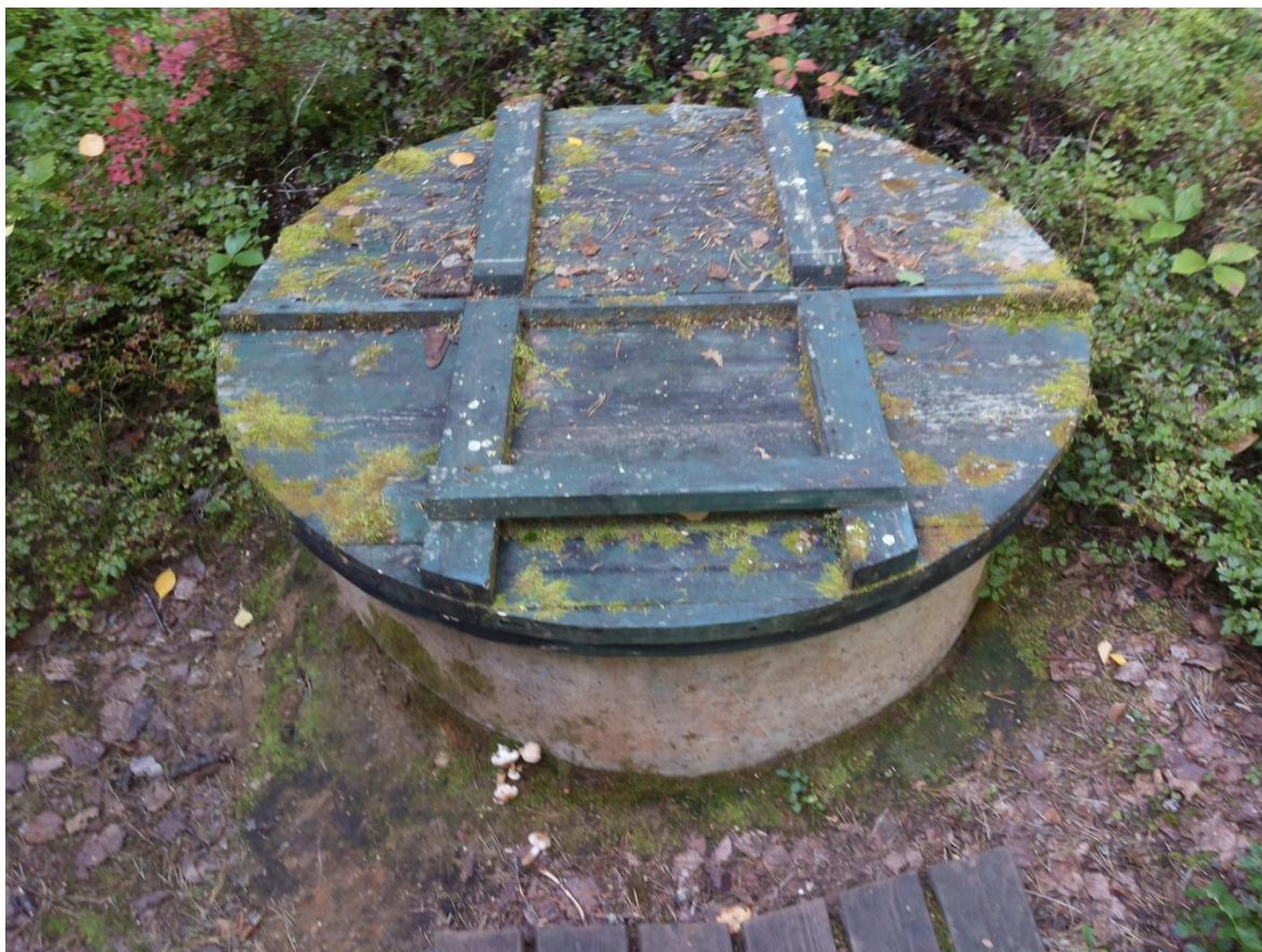
Kuva 7. Kylmäkellarin kansi on värjäytynyt liiasta kosteudesta vihreäksi ja siinä kasvaa sammalta.
