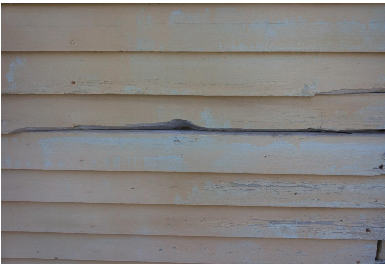
Kuva 3. Halkeamia ja reikiä on paikoin julkisivulaudoituksessa.
