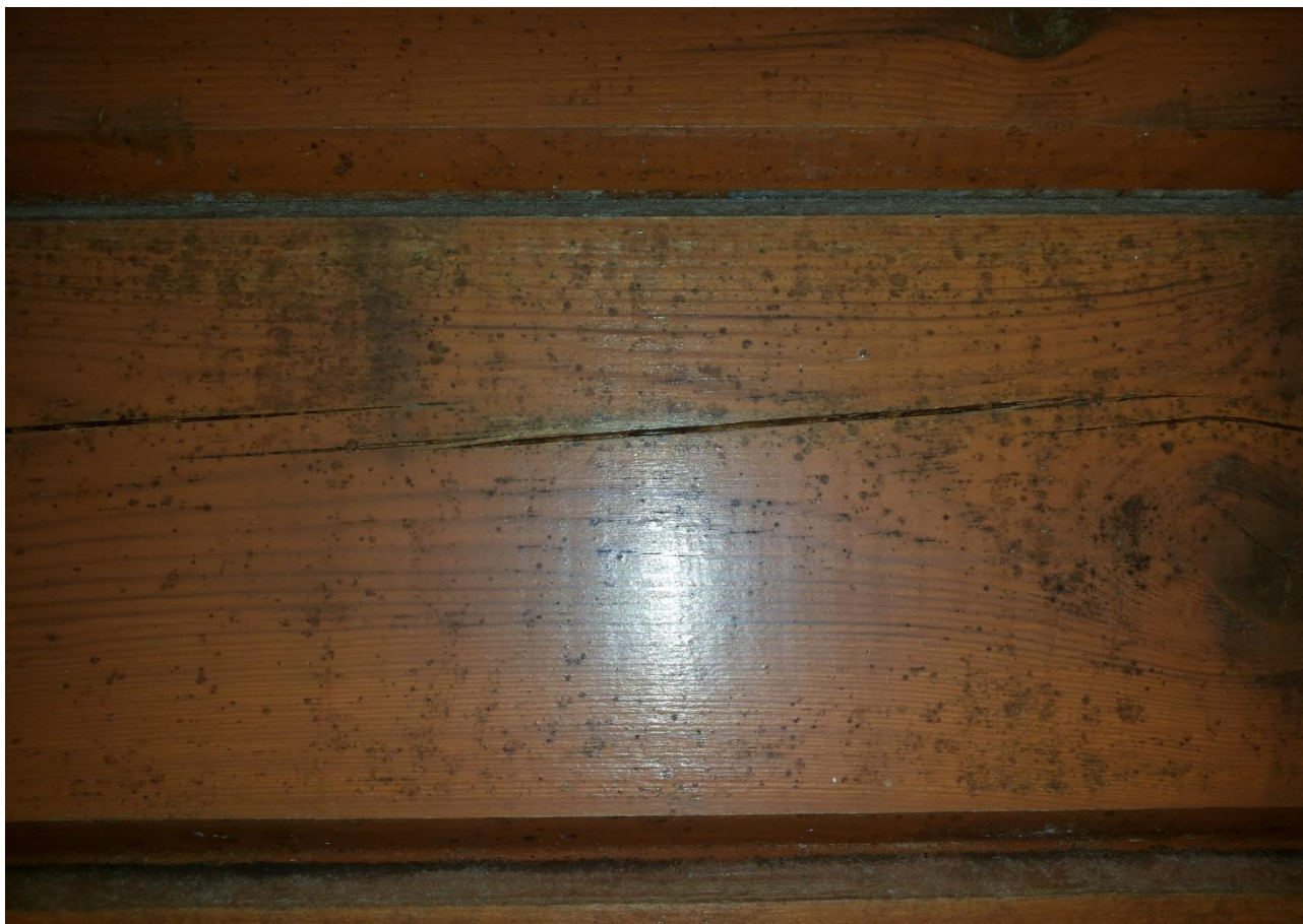
Kuva 2. Ulkoseinän pinnassa on nokihometta.
