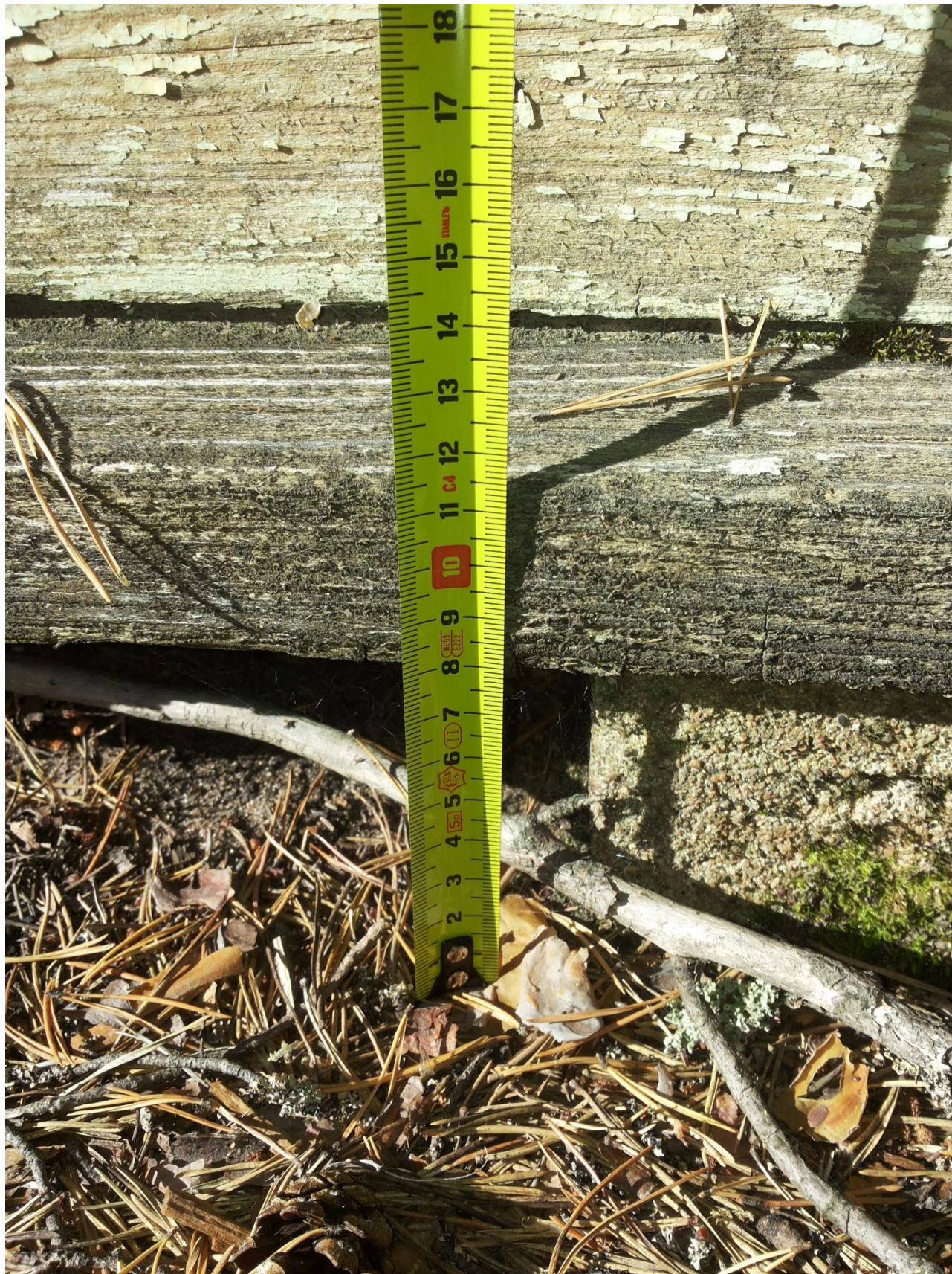
Kuva 1. Rakennuksen alapohjan tuuletus on puutteellinen.
