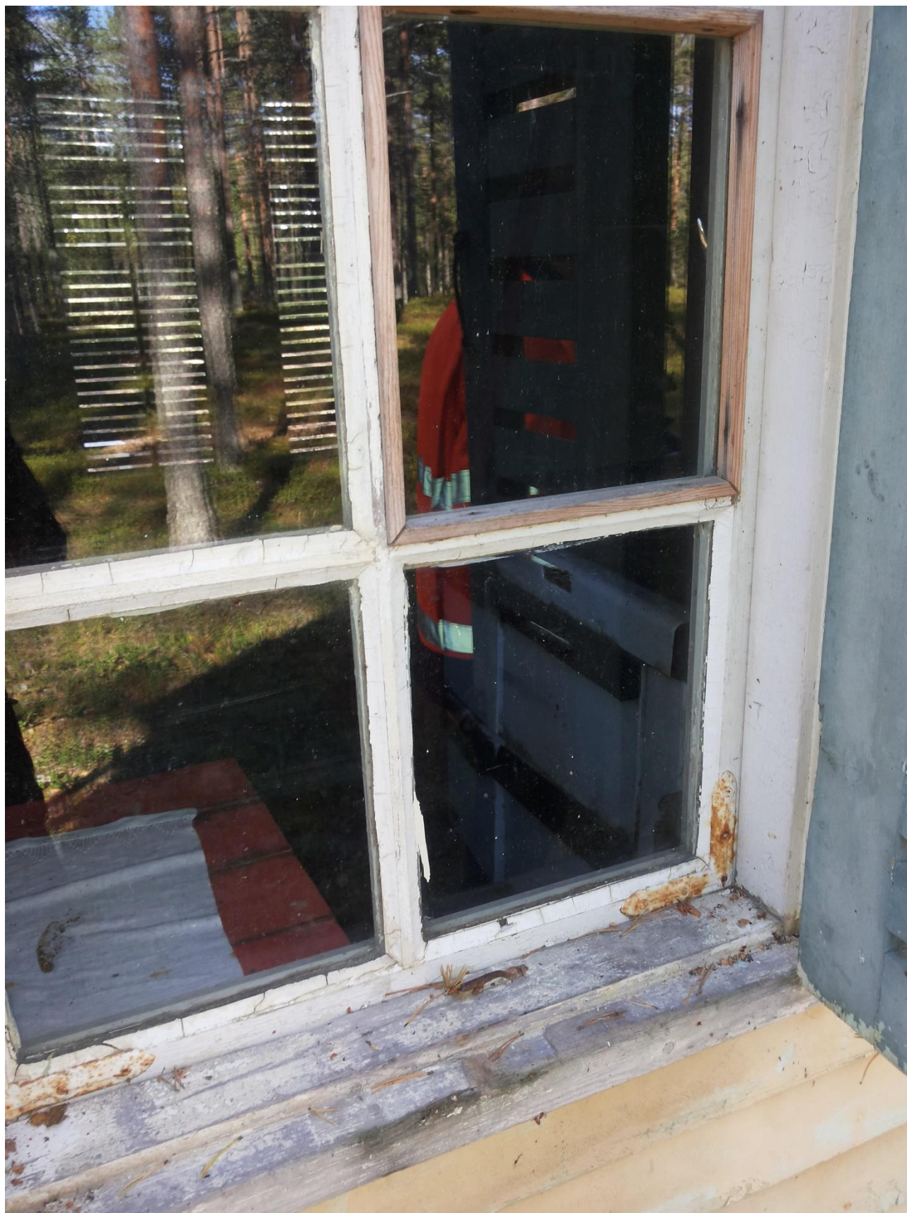
Kuva 7. Ikkunanpuitteet ovat huonokuntoiset.
