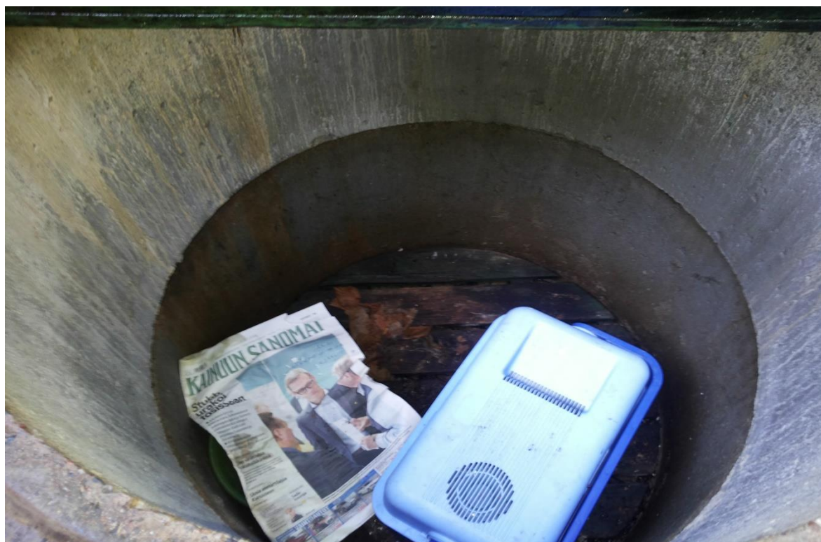
Kuva 8. Kylmäkellarin pohjaritilän aluspuut ovat vaurioituneet liiasta kosteudesta.
