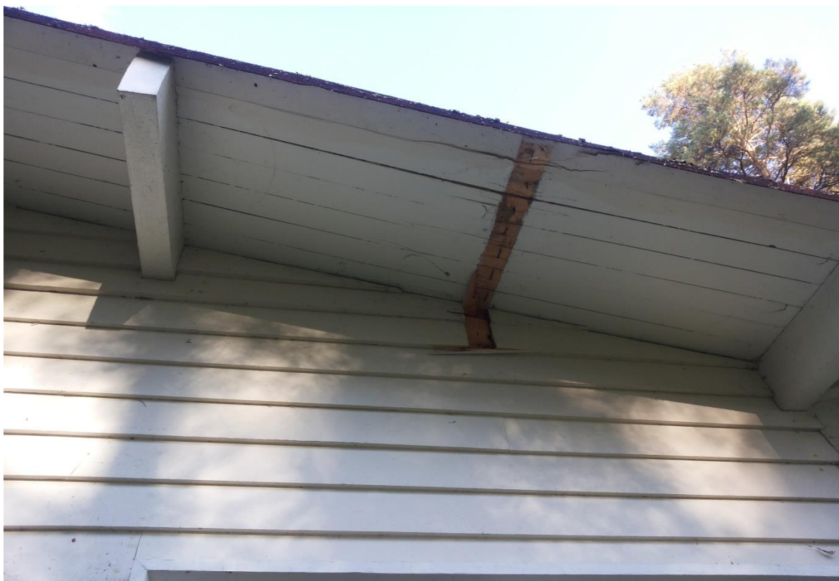
Kuva 8. Yksi vesikattorakenteen aputuenta puuttuu päätystäältä.
