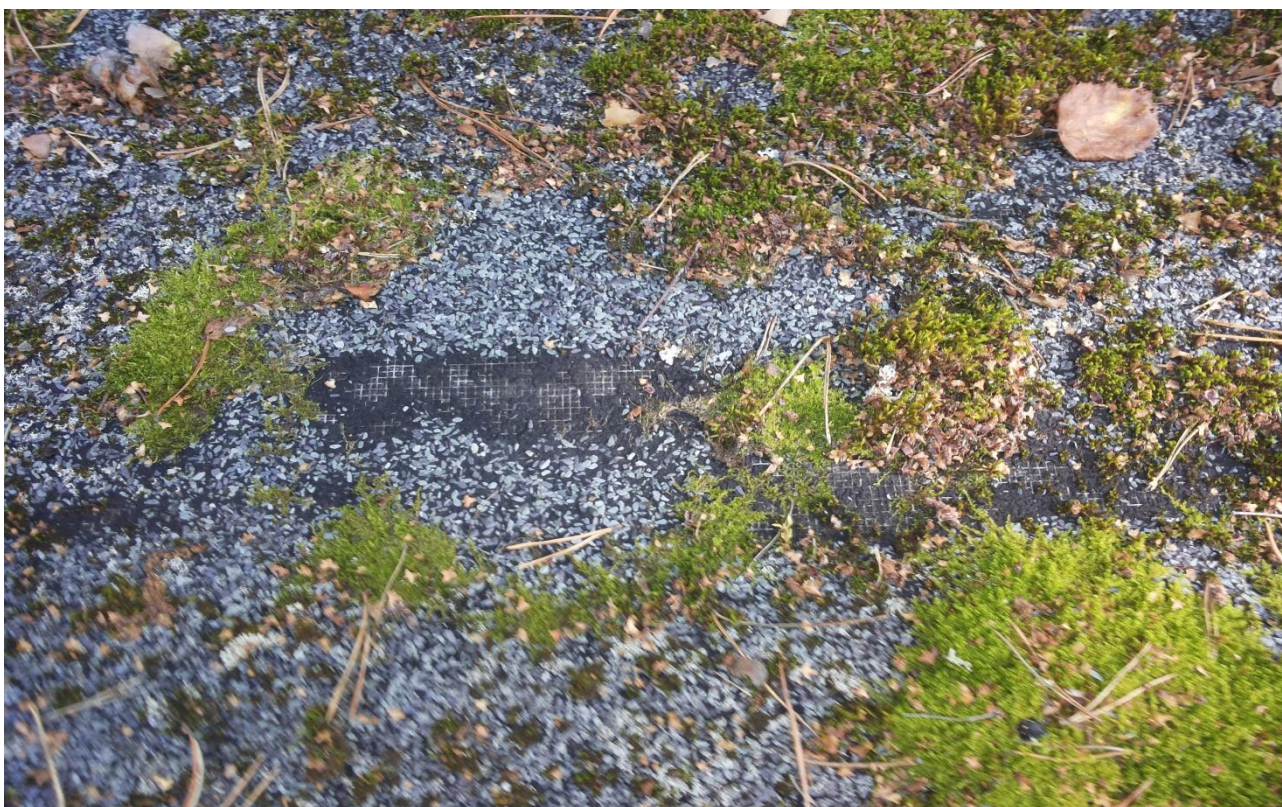
Kuva 3. Kattohuopa on vaurioitunut ja siinä kasvaa sammalta.
