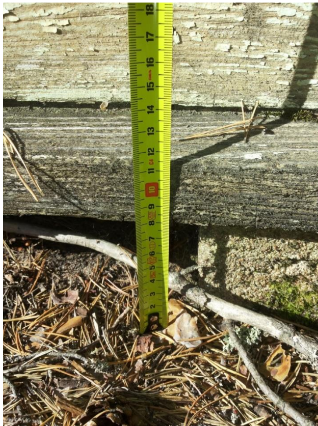
Kuva 15. Rakennuksen riittämätön tuuletus.
