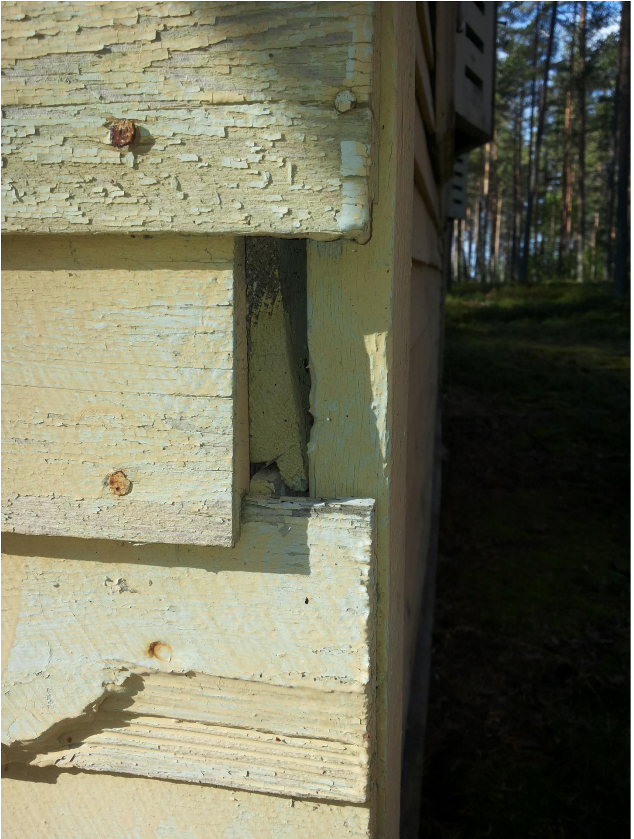
Kuva 4. Julkisivulaudoitus ei ole rakennuksen kulmaan saakka.
