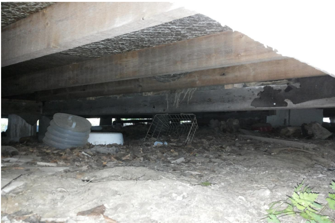
Kuva 2. Alapohjan tuuletustilassa on roskaa.
