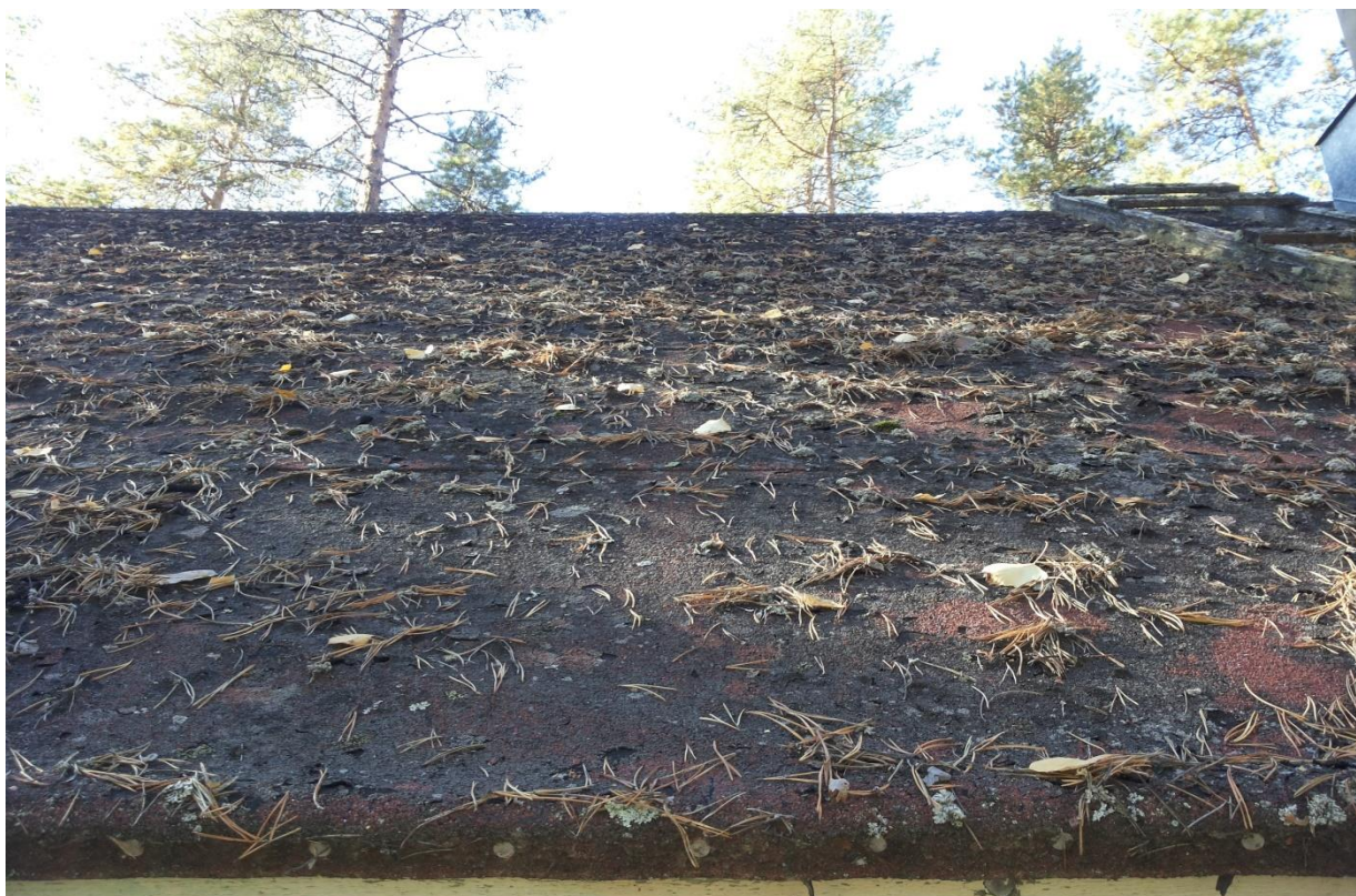
Kuva 8. Katolla on paljon sammalta ja havunneulasia.
