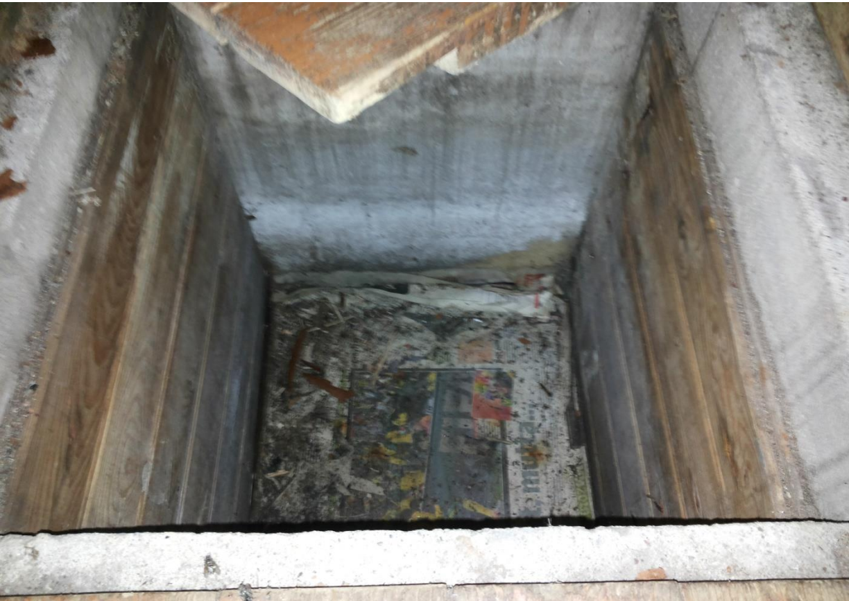
Kuva 12. Kylmäsäilytystila on käynyt kosteana. Puupaneelit kahdella reunalla.
