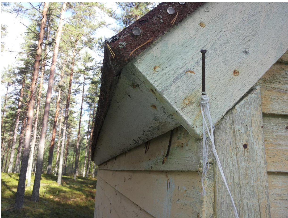
Kuva 9. Räystäältä puuttuu tippanokka.
