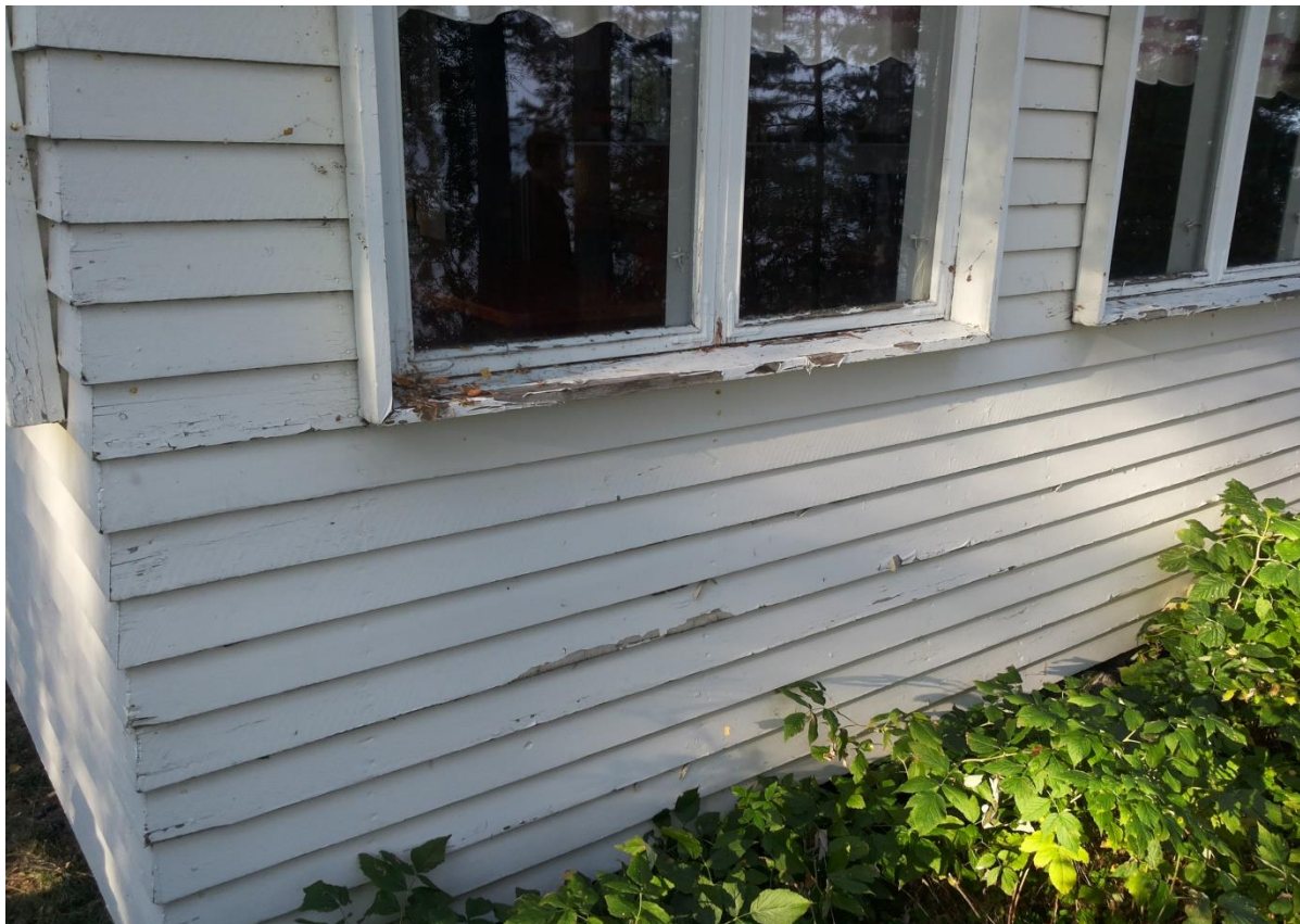
Kuva 5. Maalipinnat ovat huonokuntoiset ja kasvillisuutta on liian lähellä rakennusta
