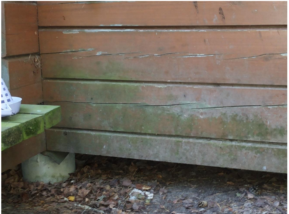
Kuva 21. Leväkasvusto hirsirakenteen pinnalla
