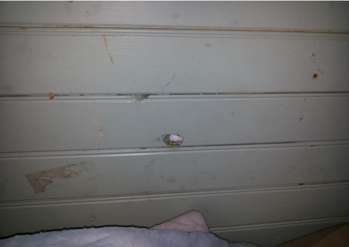
Kuva 11. Maalipinta on kulunut. Paneelissa reikä.
