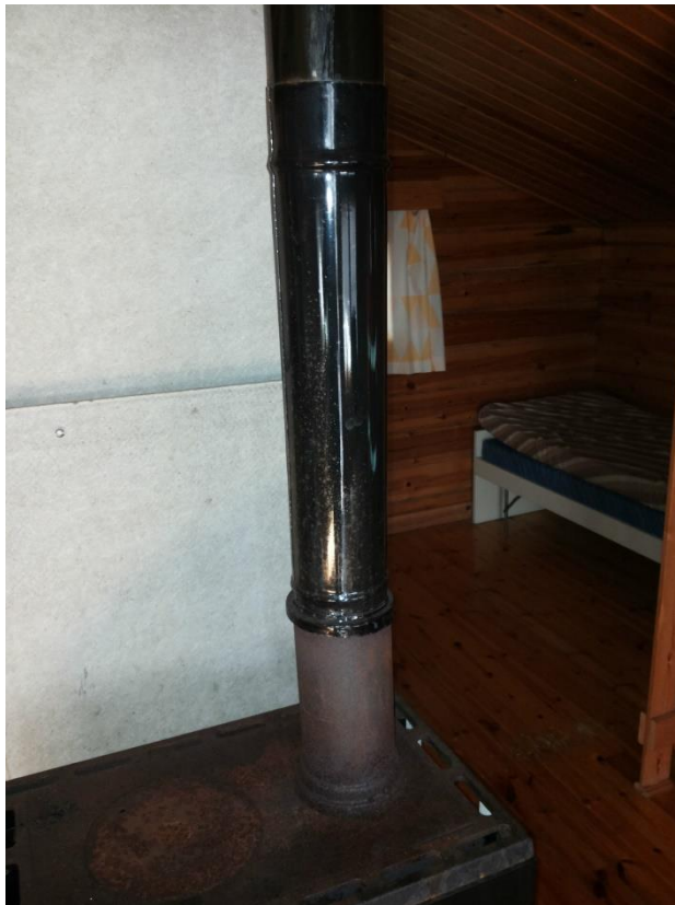
Kuva 16. Piipun muhviosan ylemmän jatko-osan virheellinen limitys
