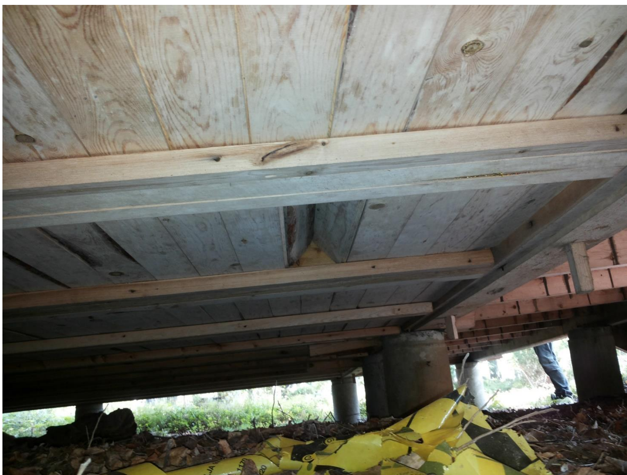
Kuva 1. Alapohjassa lämmöneristeen kannatuslaudat ovat kääntyneet sisäänpäin.
