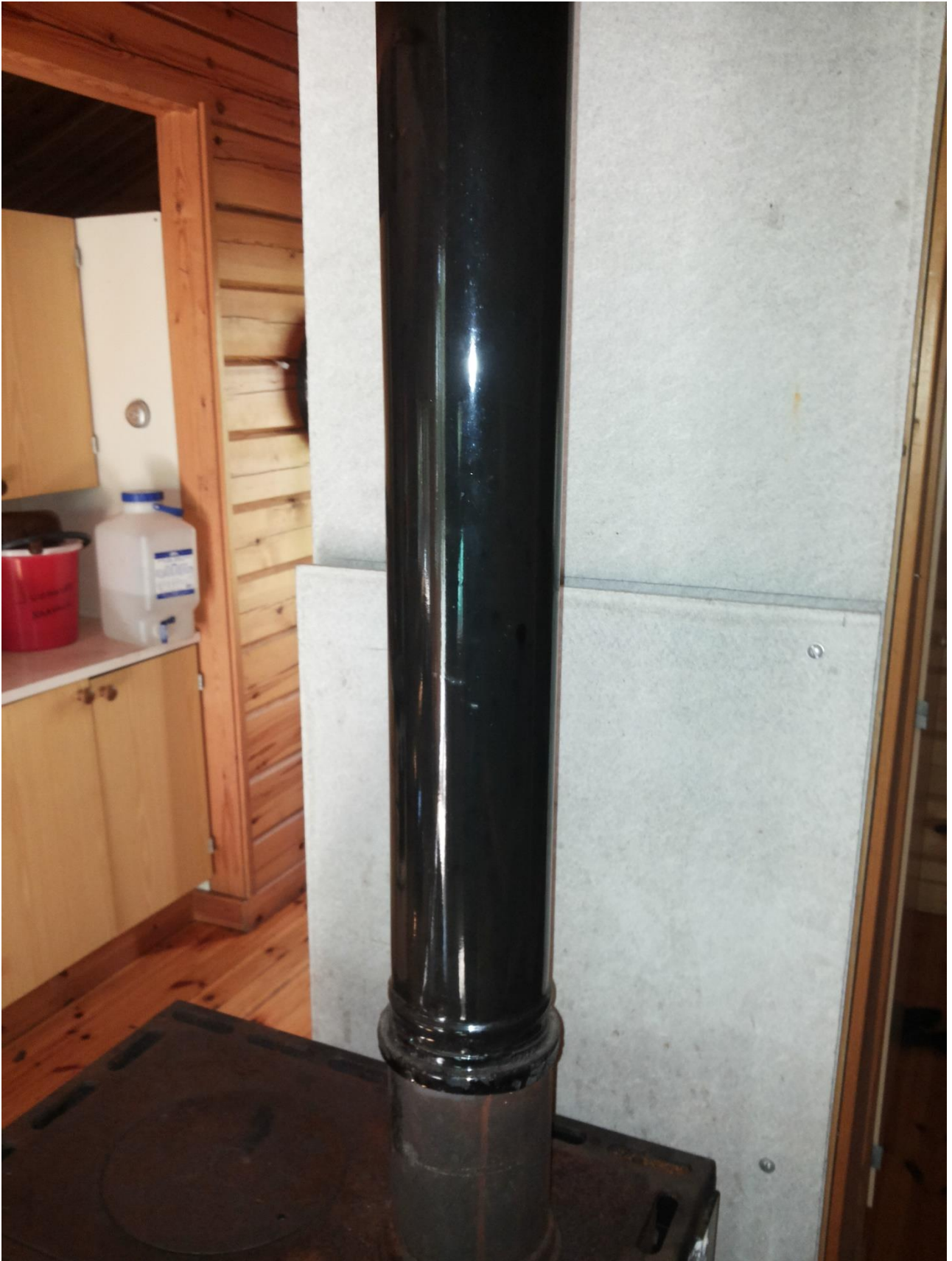
Kuva 6. Kamiinan keittotaso on ruosteessa.
