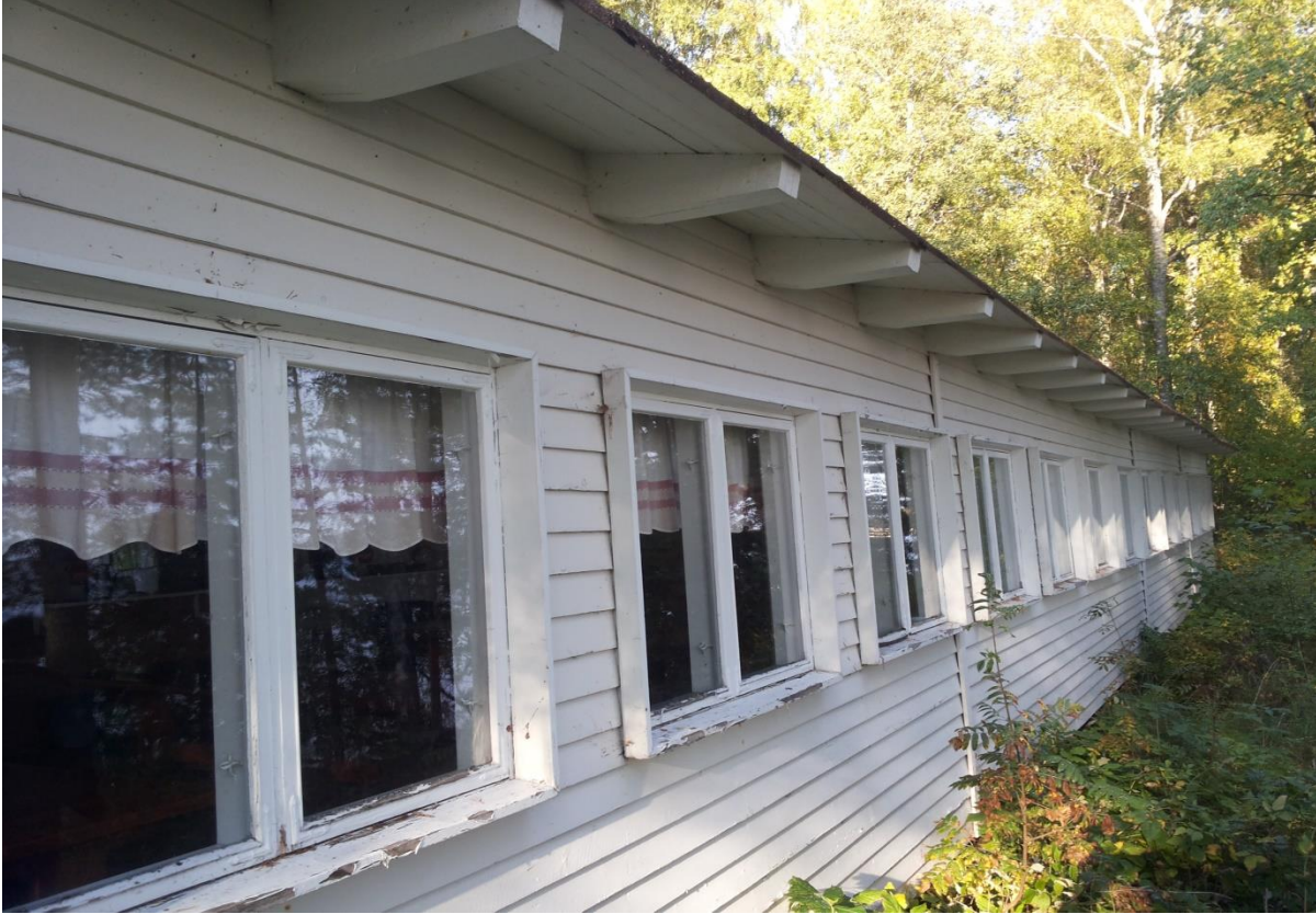
Kuva 6. Ikkunanpuitteet ovat huonokuntoiset.
