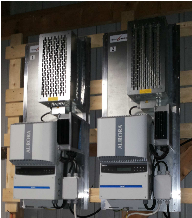
KUVA 7. Kaksi Tuule E200 -tuulivoimalan verkkoon kytkentä laitteistopaneelia (Kuva: Jukka Kangas 2014)
