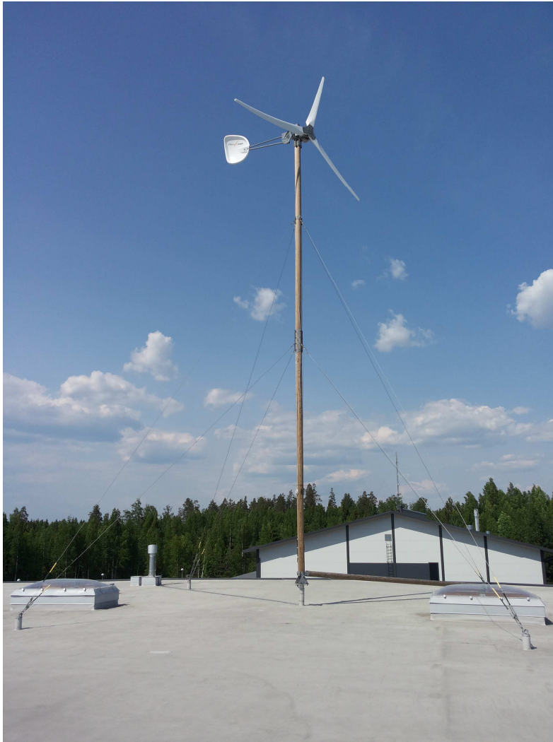
KUVA 5. Finnwind Tuule -pientuulivoimala katolla 18 metrin mastolla (Kuva: Jukka Kangas 2014)
