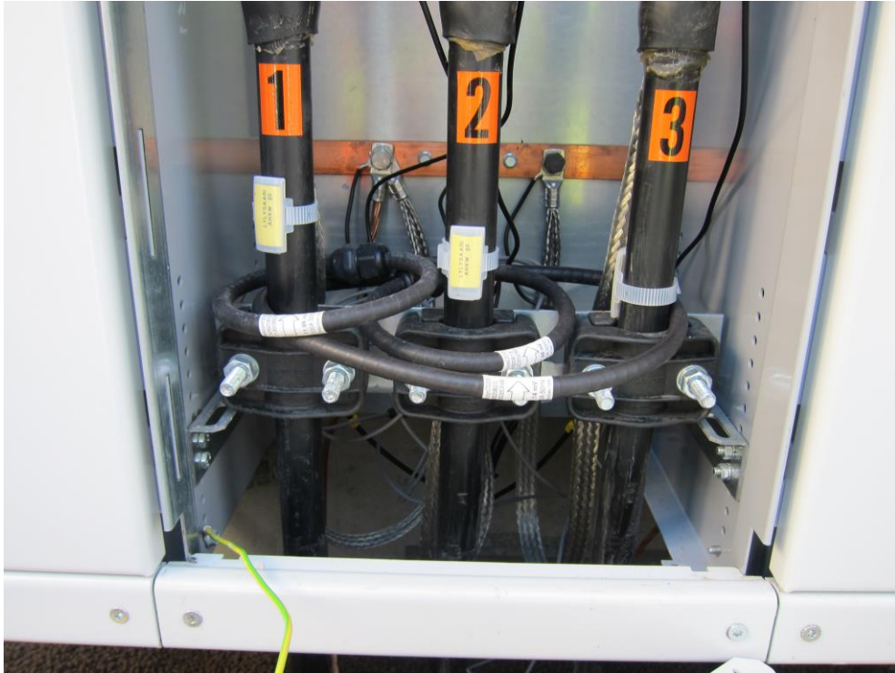
Kuva 15. Rogowski-kelat asennettuina kaapelitilassa
