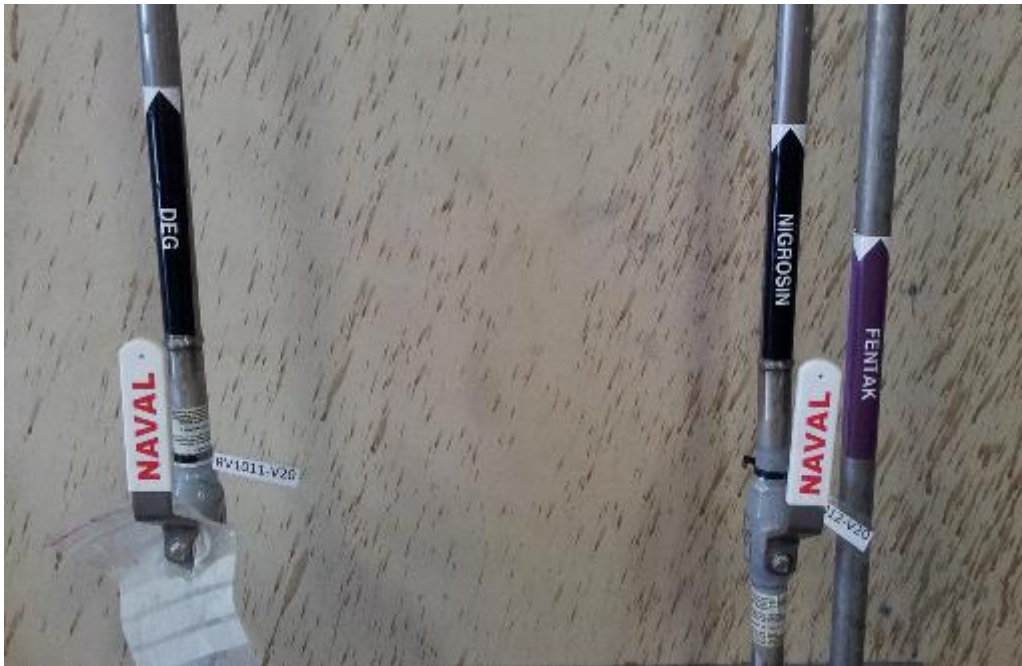
Kuva 2, Kemikaalien turvamerkinnyt putkissa ja venttiilien positiomerkinnyt, Aapo Ala-Sankila, 02/2015
