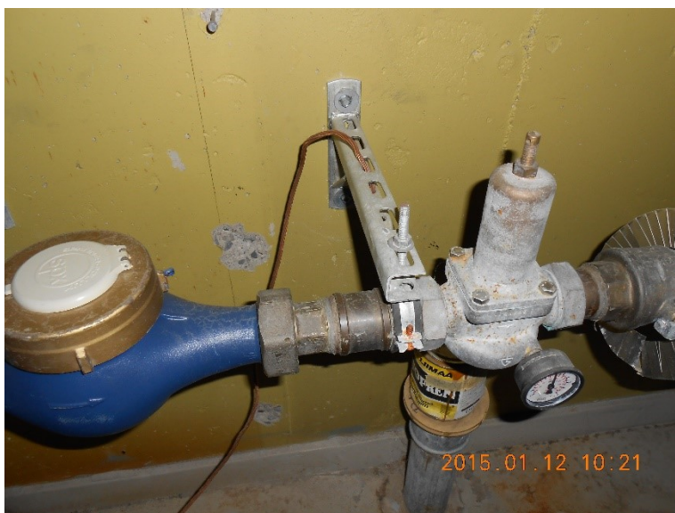
KUVA 5. Vesijohtojen viallinen maadoitus (Kamula 2015.)
