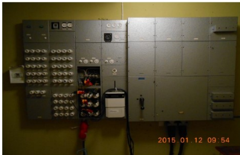
Kuva 3. Pääkeskus kiinteistökeskusten lähtöjen mittaushetkellä.
