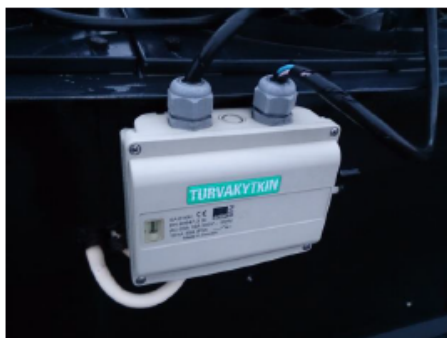
Kuva 7. Takkaimureiden rikkiäiset liitännäsjohdot.
