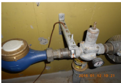
Kuva 6. Putkistojen maadoituksen viallinen kiinnitys.
