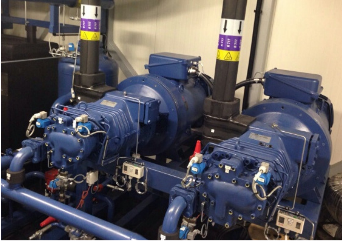
Kuva 12. Jäähallin ruuvikompressorit ja sähkömoottorit
