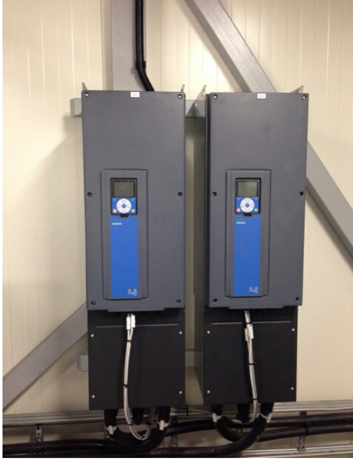
Kuva 13. Kompessoreita käyttävät taajuusmuuttajat
